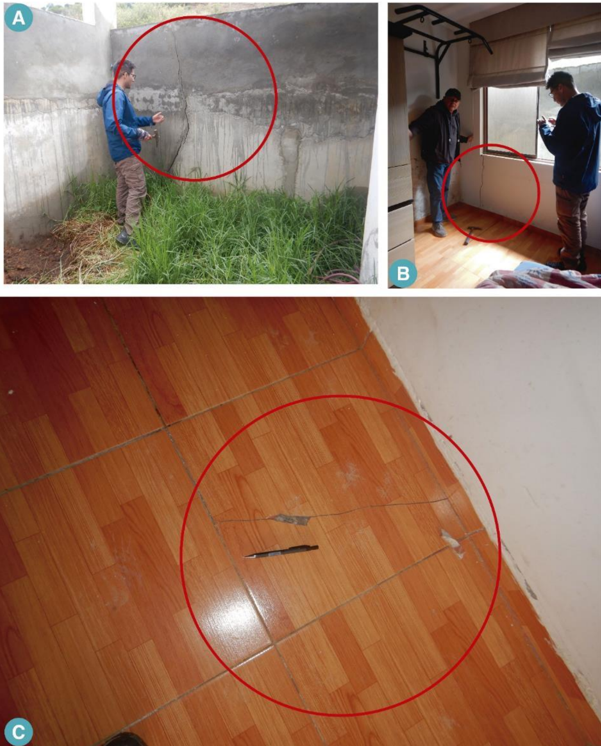
Figura 22. A) muestra agrietamientos en los muros colindantes a la ladera, B) grietas en las paredes de la vivienda, además de descuadre de puertas y ventanas y C) muestra agrietamientos en losetas por excesos de presión.
