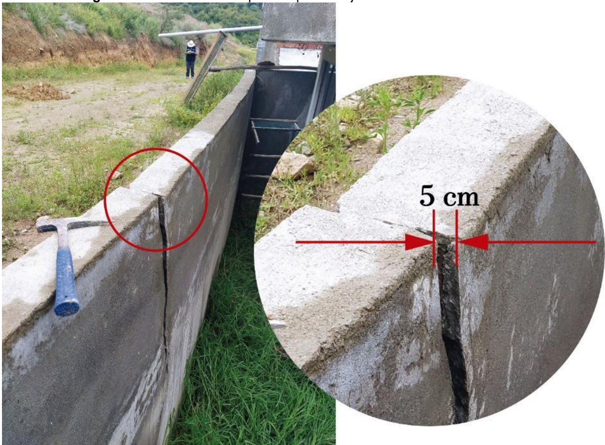
Figura 25. Desplazamiento de 5 cm del muro colindante al talud.
