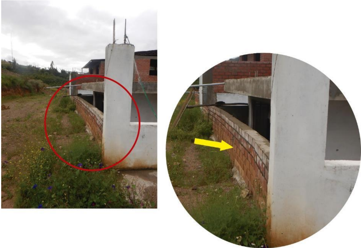
Figura 24. Muro deformado por a la presión ejercida de la masa deslizante.
