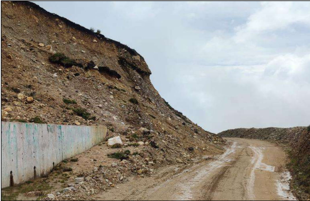
Gráfico 15: En el sector de Putaca se observan derrumbes y deslizamientos
