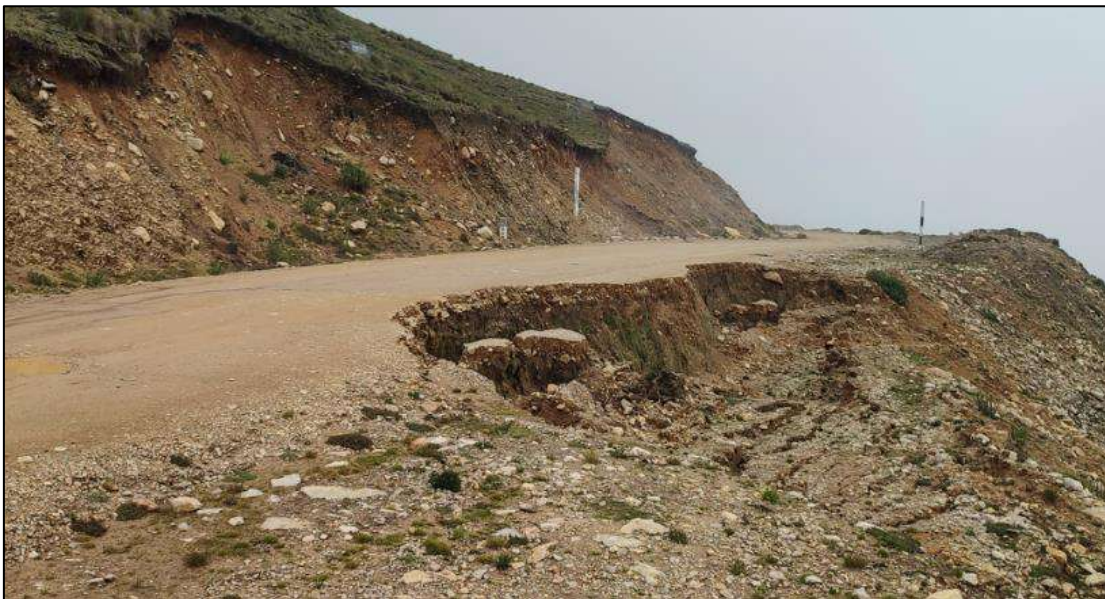
Gráfico 16: Deslizamiento en la vía Putaca.
