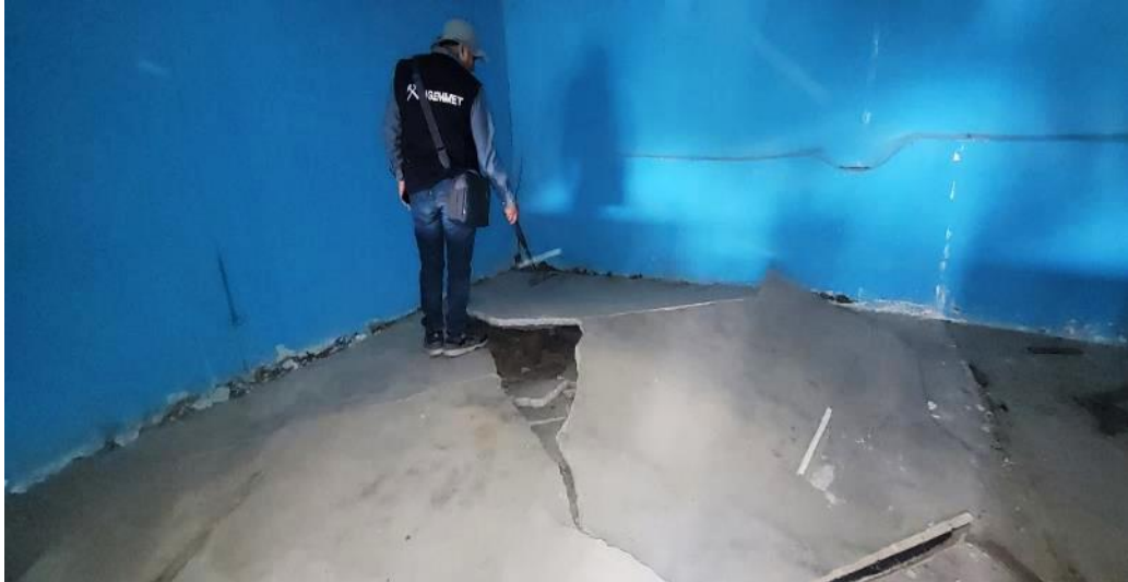
Figura 12. Vivienda afectada por el levantamiento del piso, en la parte baja del deslizamiento. Coordenadas: E: 781570, N: 9211600.
