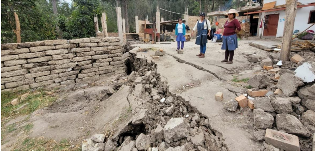
Figura 14. Exterior de vivienda afectada por el escarpe principal, en la parte alta del deslizamiento. Coordenadas: E: 781762, N: 9212141.
