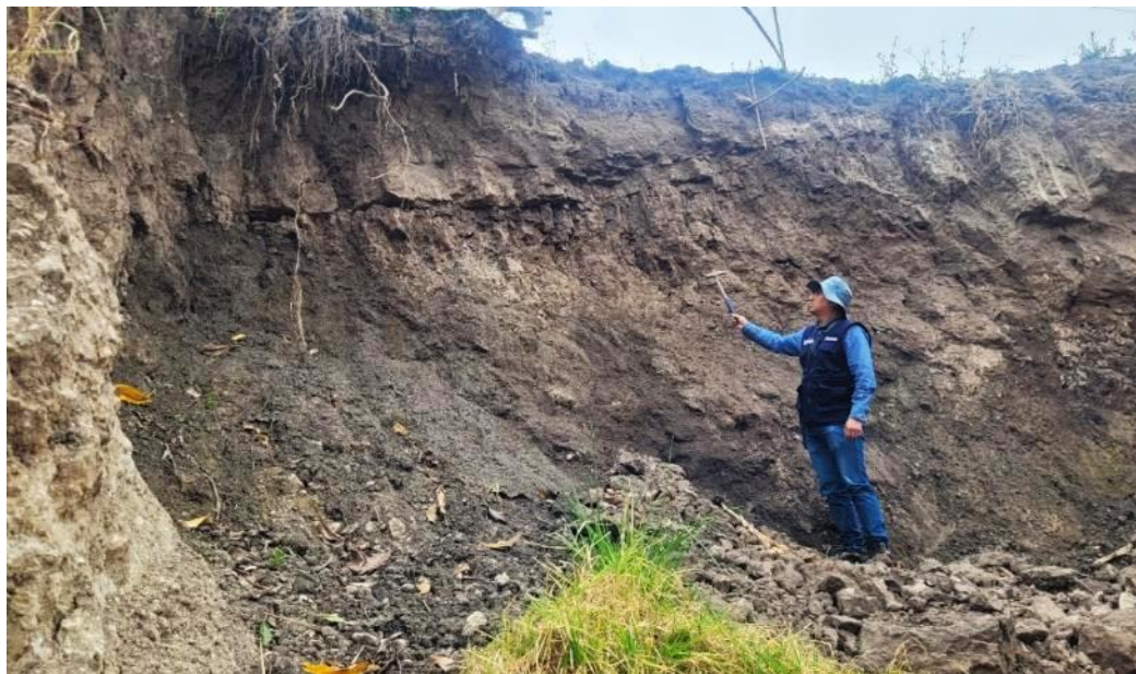
Fotografía 1. Se observa la roca de la secuencia volcánica San José, muy fracturada y completamente meteorizada.
