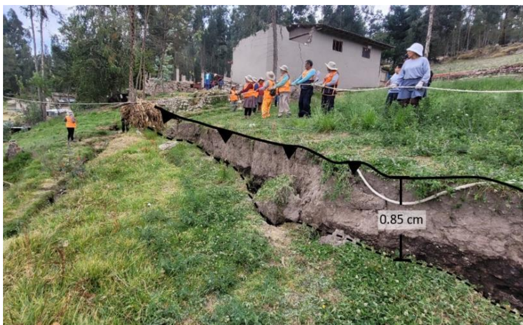
Figura 10. Vista de formación del escarpe principal (29 de agosto), con un salto vertical de 0.85m. Coordenadas: E: 781776, N: 9212131.
