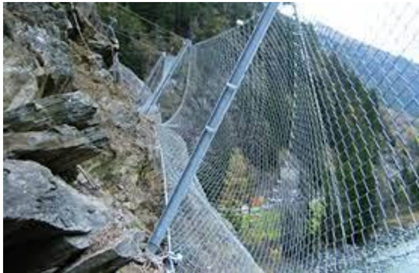
Figura 23. Ejemplo de barreras dinámicas de protección frente a la caída de rocas.
