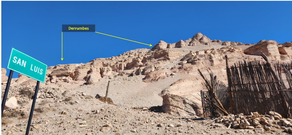
Figura 19. La zona de arranque de los derrumbes se observa en la cumbre de colinas de la Villa San Luis.
