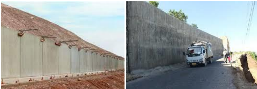
Figura 24. Ejemplo de muros de contención para los derrumbes y sujeción de la avalancha de detritos.
