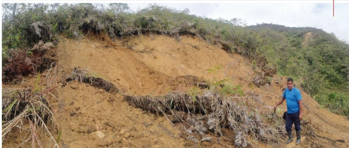
Figura 20. Perfil del deslizamiento activo Da-3.
