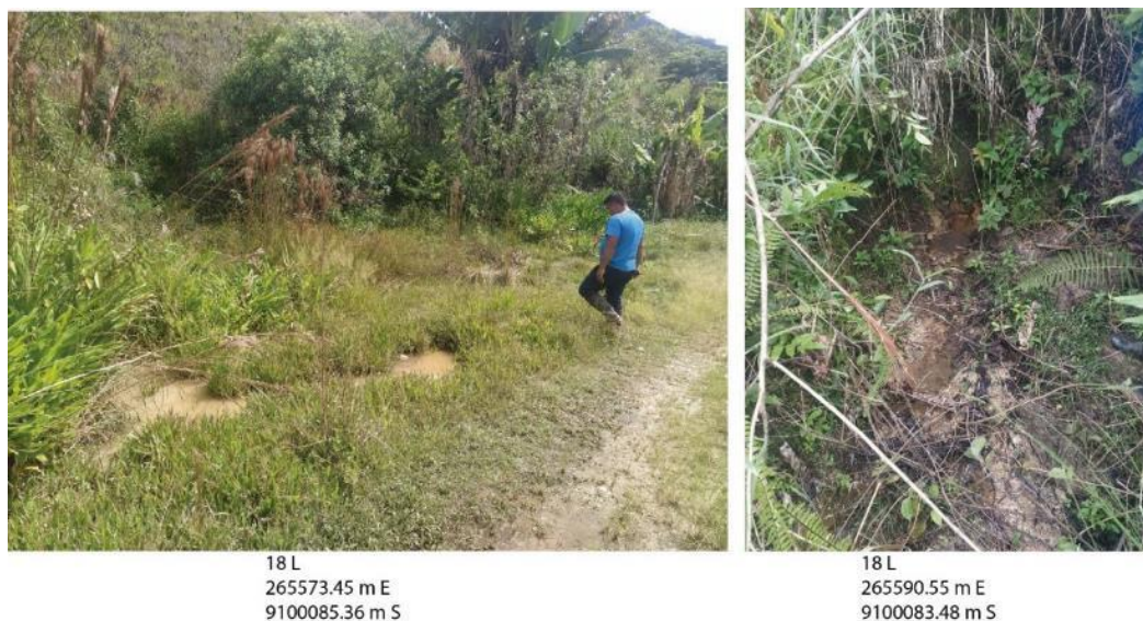
Figura 30. Emanaciones de agua (ojos de agua) por la probable filtración de aguas desde el “bofedal” por entrapamiento de aguas del deslizamiento Da-8.
