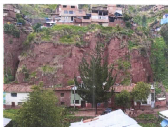
Multipeligro: Derrumbes, deslizamientos, erosion de cauces, flujos en el sector de Rumi Huancaro del distrito de Santiago.
