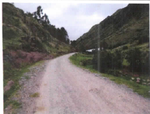
Vias: Infraestructura vial tipo camino vecinal en el ambito rural del distrito de Santiago.
