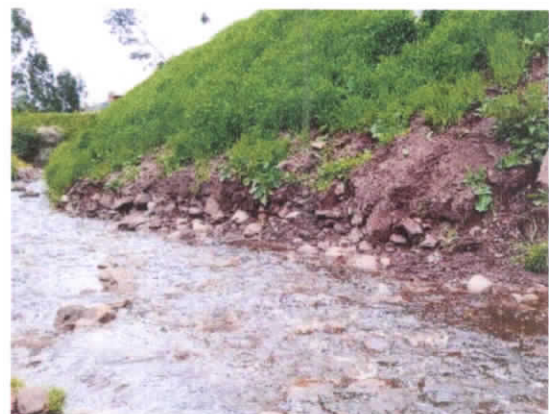
Erosión Fluvial de Cauces: Erosion a nivel de cauces en el sector urbano de Chocco del distrito de Santiago.
