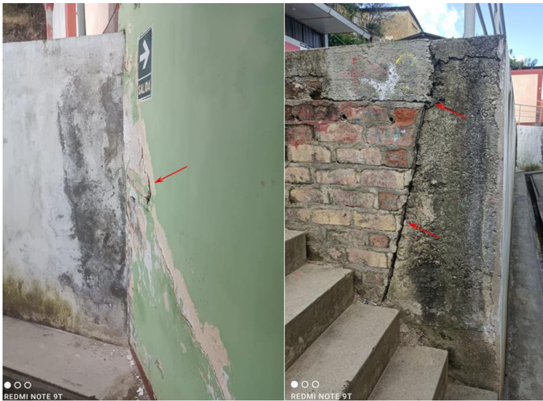
Figura 20. Presencia de humedad en muro de contención con agrietamientos en pared y separación de muro de contención de pared de ladrillo debido al movimiento horizontal, de Institución Educativa.
