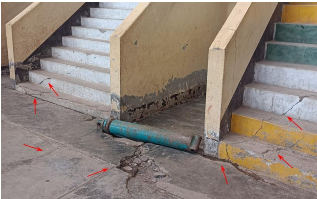
Figura 18. Agrietamiento en tribuna deportiva de Institución Educativa. Ubicación: E: 686654; N: 9361974.
