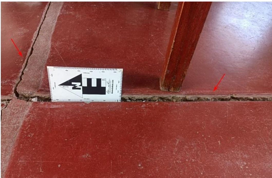
Figura 22. Desplazamiento horizontal en piso de salón de clases de Institución Educativa.
