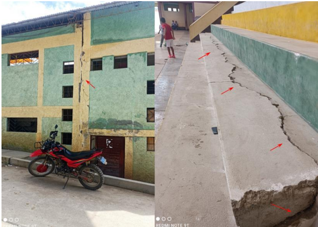
Figura 19. Agrietamiento en paredes y tribuna deportiva de Institución Educativa. Ubicación: E: 686654; N: 9361974.
