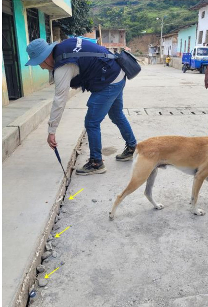
Figura 12. Separación pronunciada de junta de dilatación. Ubicación: E: 686766; N: 9361934.
