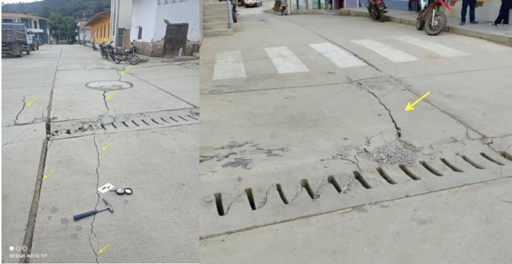
Figura 11. Agrietamiento en vía encementada y separación pronunciada de junta de dilatación. Ubicación: E: 686755; N: 9361900.
