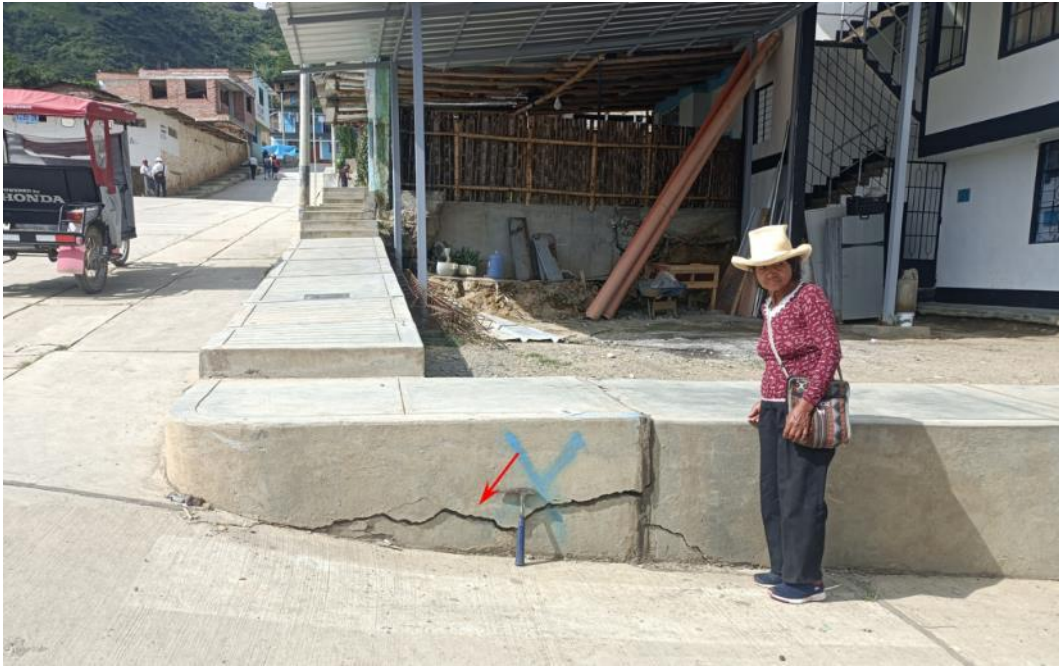
Figura 17. Agrietamiento y movimiento horizontal en vereda. Ubicación: E: 686725; N: 9361892.
