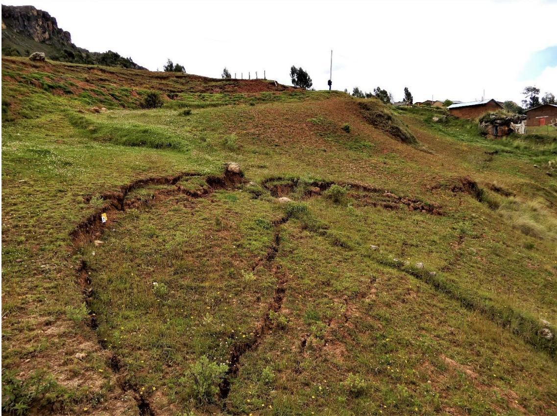
Fotografía 10. Vista de la cabecera del deslizamiento donde se observa zona de múltiples escarpas con saltos menores a un metro, en el sector "A". Coordenadas UTM: 303370 / 8922829, Zona 18.
