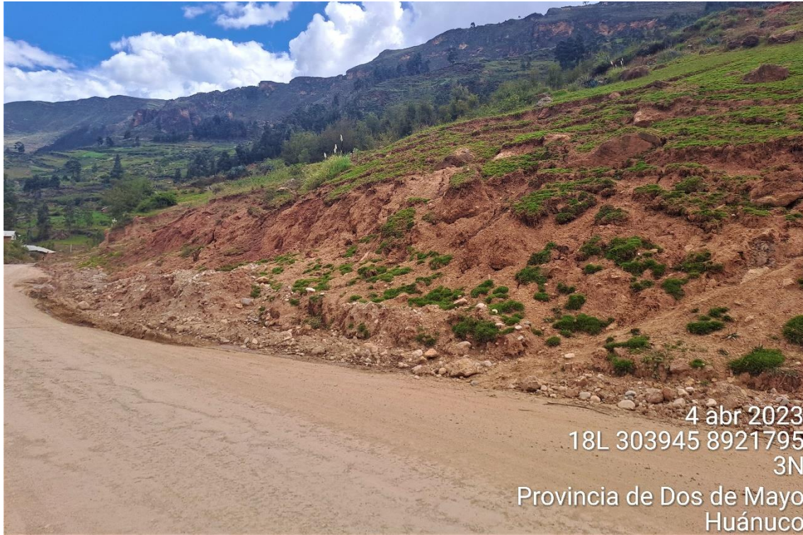
Fotografía 15. Vista de perfil de la masa deslizada en el sector "C".
