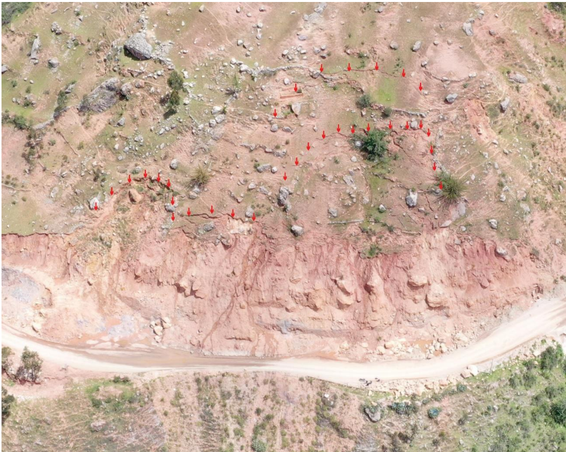
Figura 5. Vista de deslizamientos de escarpas múltiples en el sector "B". Afecta carretera de la ruta La Unión - Huánuco.
