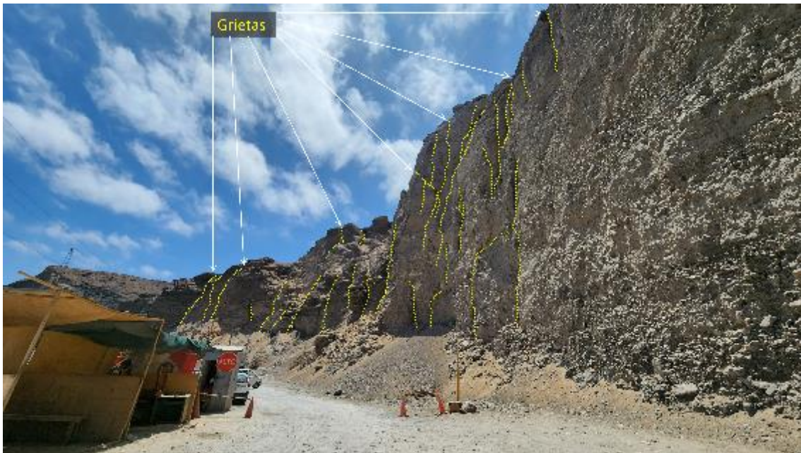
Figura 8. Sistema de grietas en dirección noroeste-sureste (líneas amarillas) en el sector Muelle Pesquero Matarani.
