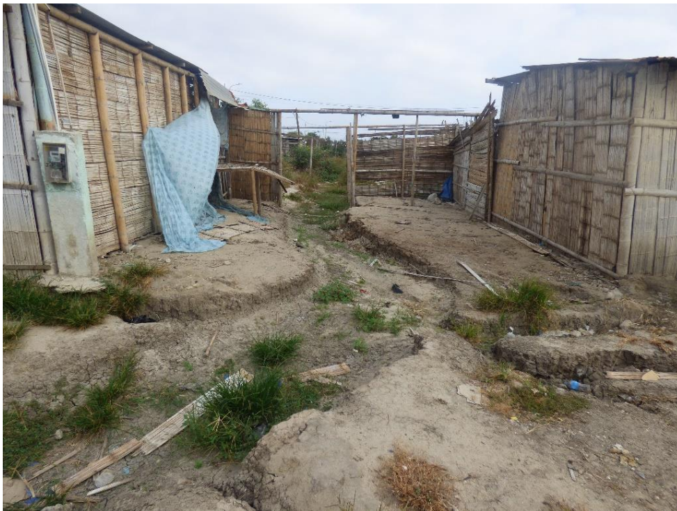
Fotografía 3. Viviendas afectadas por flujos de lodo, estos se desbordan y generan inundaciones. Sector Ely Pintado. Es necesario canalizar la quebrada que no presenta un cauce definido y reubicar viviendas.
