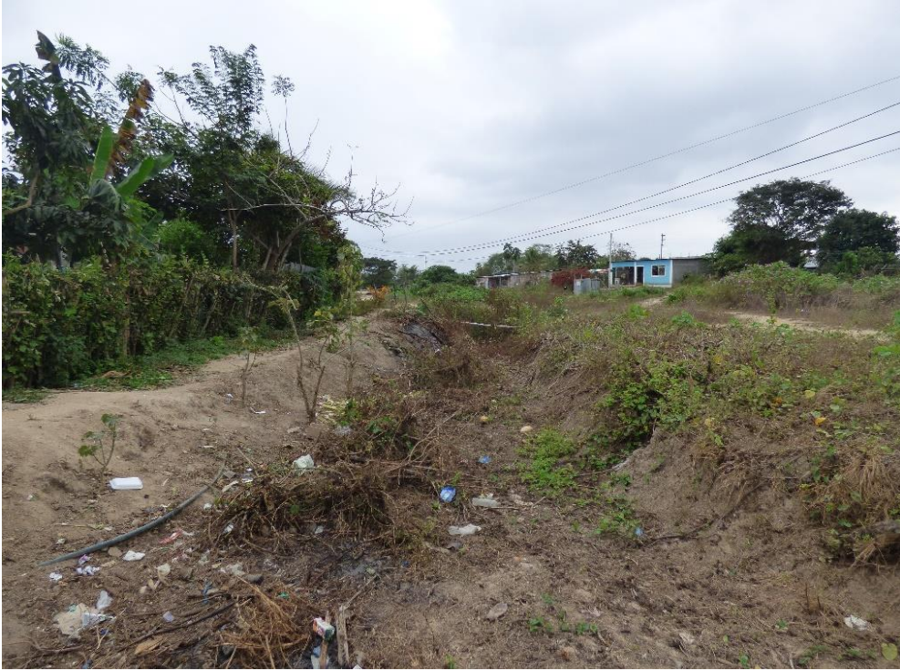
Fotografía 7. Quebrada Seca, colmatada por maleza y desmorte en el caserío del mismo nombre. Se requiere trabajos de descolmatación y encauzamiento. Coordenadas UTM: 589128 / 9594381, Zona 17. Tomado el 28/08/2023.
