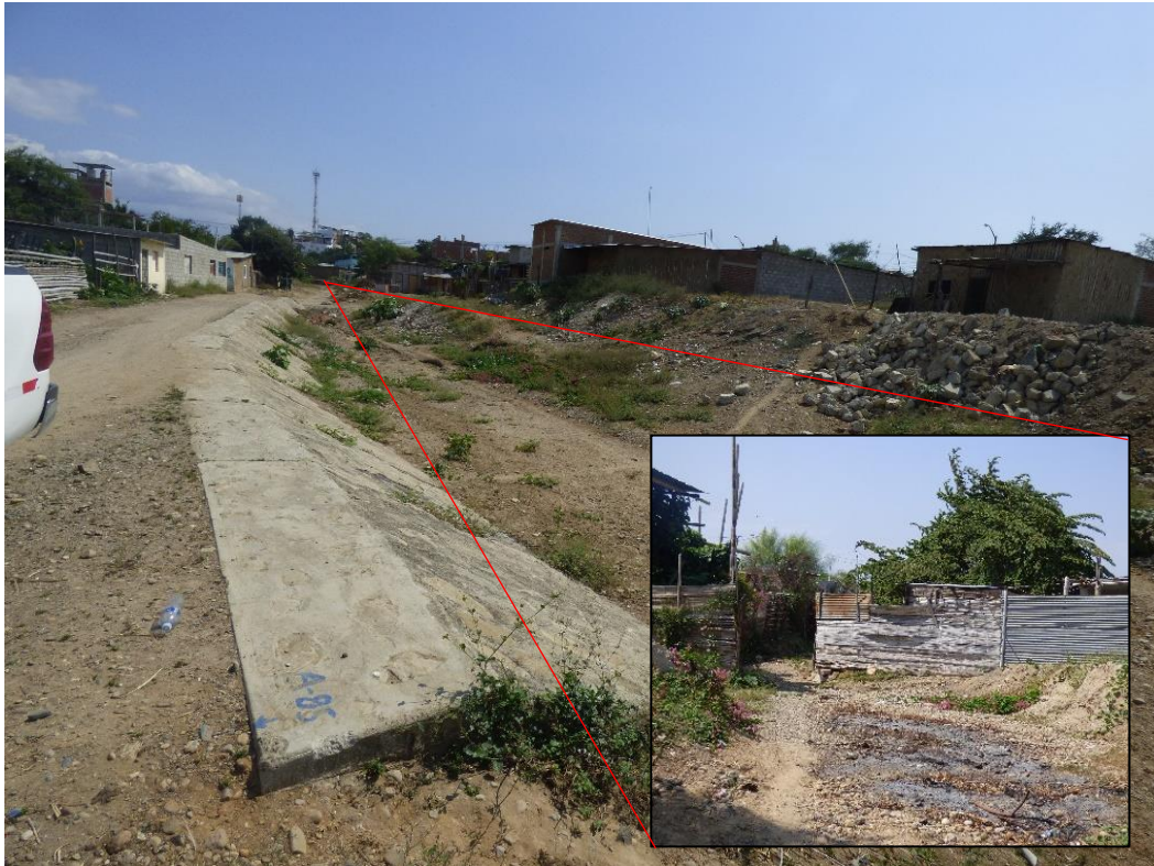
Figura 27. Quebrada en el pasaje Ramón Castilla (C.P. San Jacinto) canalizada parcialmente. Aguas abajo, se presenta viviendas dentro del cauce.
