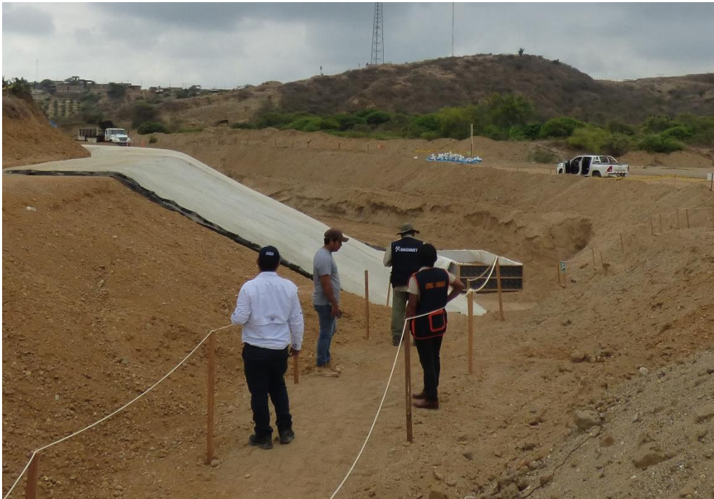
Fotografía 35. Visita con representantes de Indeci del distrito de Corrales a la quebrada del mismo nombre, donde se tiene obras de encauzamiento en ejecución.
