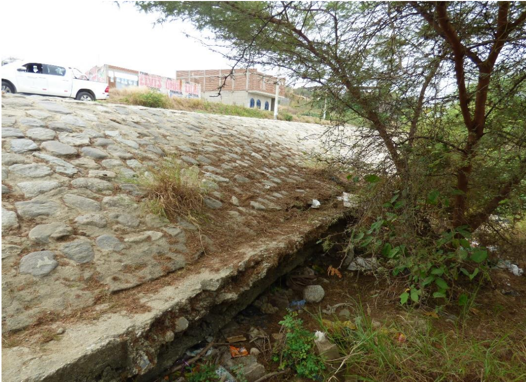
Fotografía 14. Baden que presenta erosión retrogresiva en las bases por acción de flujos de lodo y detritos en la vía Tumbes – San Juan de La Virgen – Pampas de Hospital, centro poblado Garbanzal.
