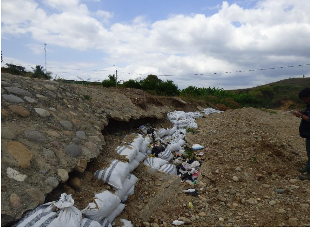
Fotografía 16. Socavamiento de defensas ribereñas dañadas por el flujo de detritos por activación de la quebrada Oidor, San Jacinto.
