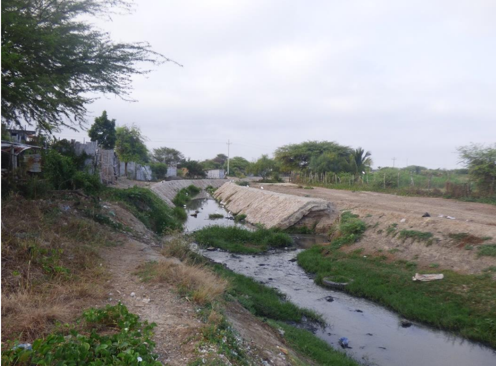
Fotografía 2. Canalización parcial de la quebrada Marco Felipe, sector San Martín y 1 de junio. Falta culminar canalización aguas arriba.
