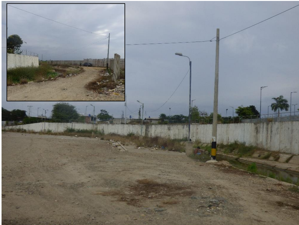
Figura 21. Zona de inundación fluvial por Canal Internacional. Los muros de contención protegen el lado ecuatoriano, sector Playa Sur.
