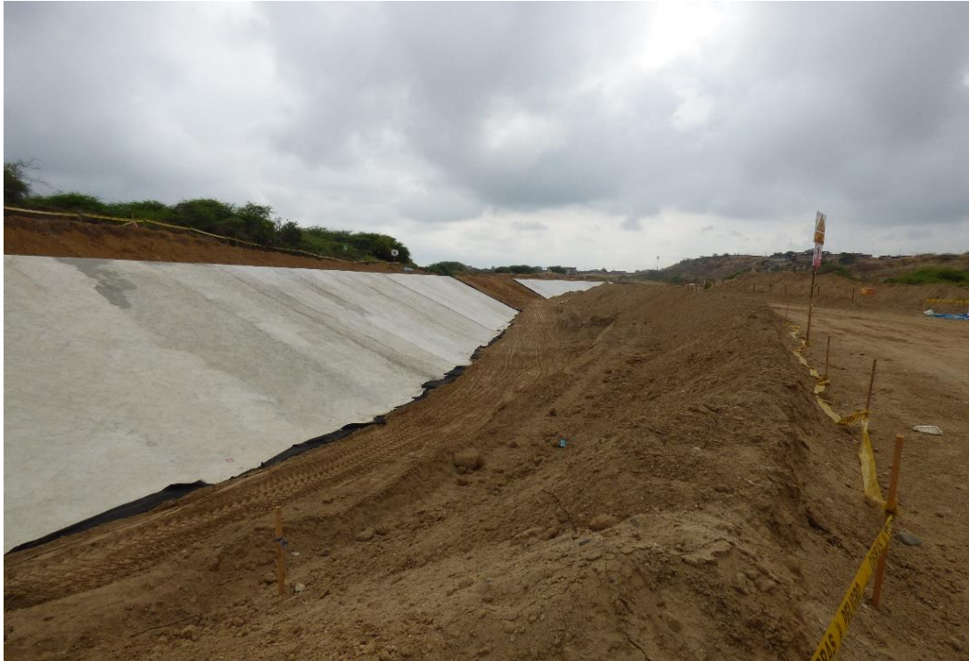
Fotografía 10. Obras de canalización en ambas márgenes de la quebrada Corrales. Coordenadas UTM: 556460 / 9599352, Zona 17. Tomado el 23/08/2023.
