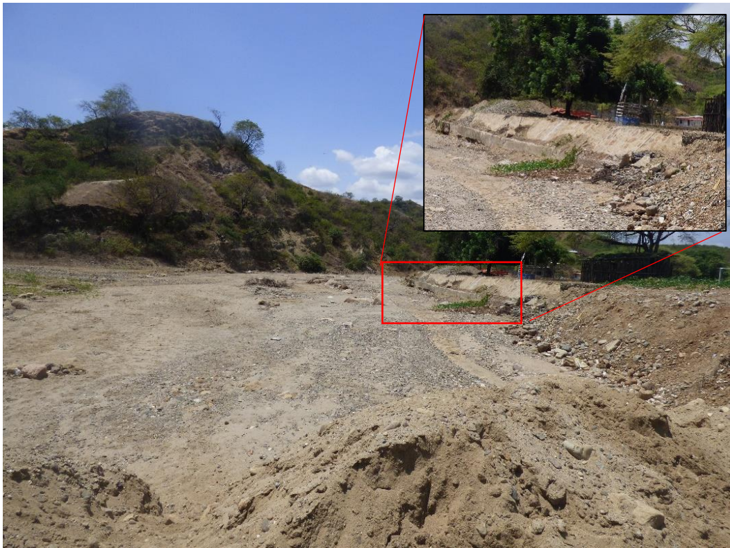
Figura 28. Defensas ribereñas dañadas por flujo de detritos en el acceso al centro poblado La Capitana, San Jacinto.
