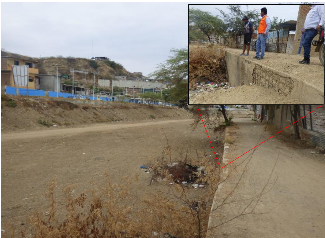
Figura 31. Vista aguas debajo de la quebrada Los Pozos, distrito de Zorritos, con defensas ribereñas desgastadas (margen derecha) y cubiertas por desmonte o viviendas (margen izquierda).
