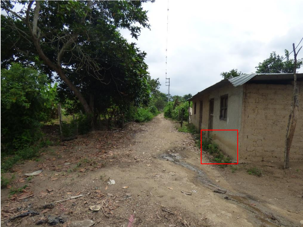
Figura 23. Marca por inundación fluvial durante la activación de la quebrada Faycal en el caserío Isla Noblecilla, distrito de Matapalo. Coordenadas UTM: 587069 / 9591464, Zona 17. Tomado el 28/08/2023.
