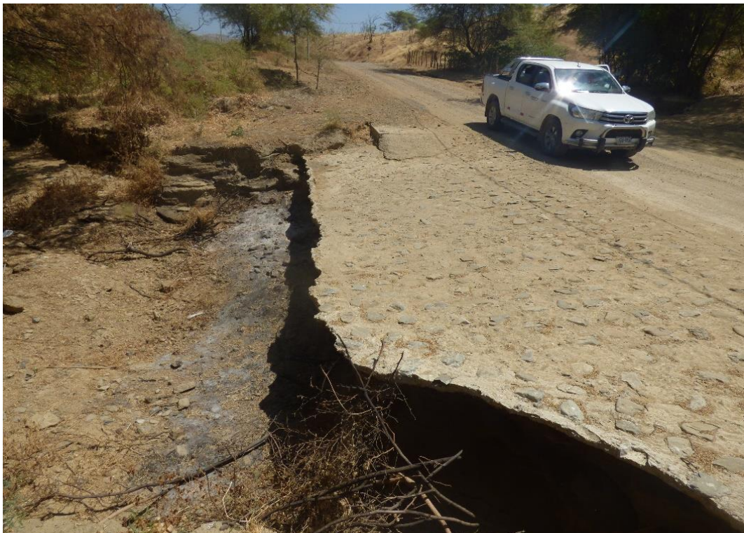
Fotografía 30. Baden con erosión retrogresiva hacia sus bases en la vía Máncora – Fernandez – Casitas, C.P. Barrancos, distrito de Canoas de Punta Sal.
