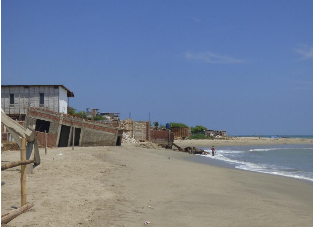
Fotografía 23. Viviendas afectadas por procesos de erosión marina en el sector Costa Verde, distrito de Zorritos.
