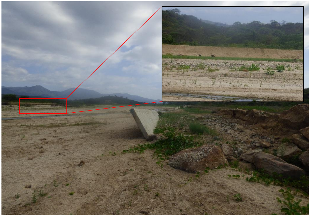
Figura 33. Quebrada Casitas – Bocapán. Hacia la margen derecha se observa barreras ribereñas afectadas. En la margen izquierda la protección es con arrimado de material.
