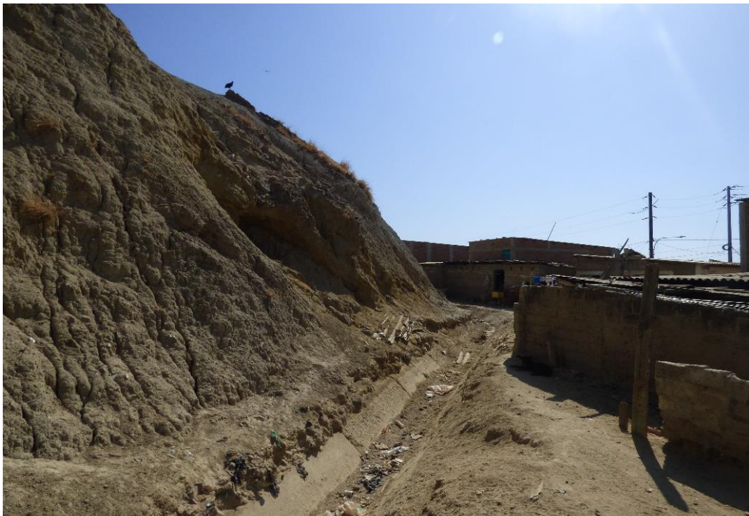
Fotografía 27. Torrenteras a través de viviendas provenientes de la erosión de ladera en el Barrio Marcos Herrera, distrito de Canoas de Punta Sal.
