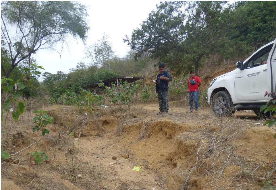
Fotografía 38. Caserío Becerra afectado por una intensa erosión de ladera. Visita realizada con un representante de la Municipalidad de Pampas de Hospital, provincia de Tumbes.
