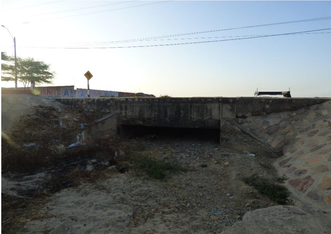
Fotografía 26. Alcantarilla colmatada bajo la vía Panamericana Norte en el sector Punta Mero, distrito de Canoas de Punta Sal.
