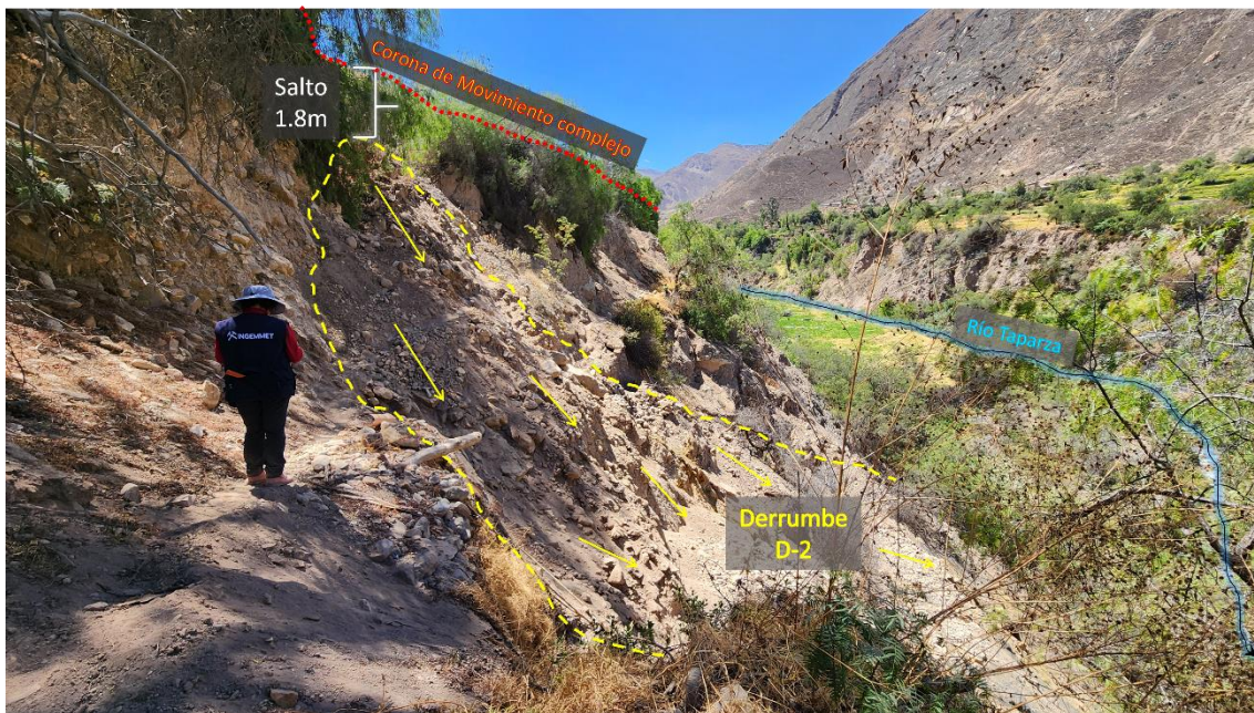
Figura 21. Se observa el derrumbe D-2 y escarpe de salto de 1.8m en el sector de Aguasana Chico, el cual afectó directamente 37 metros del canal de riego Aguasana Chico - Pulviña.
