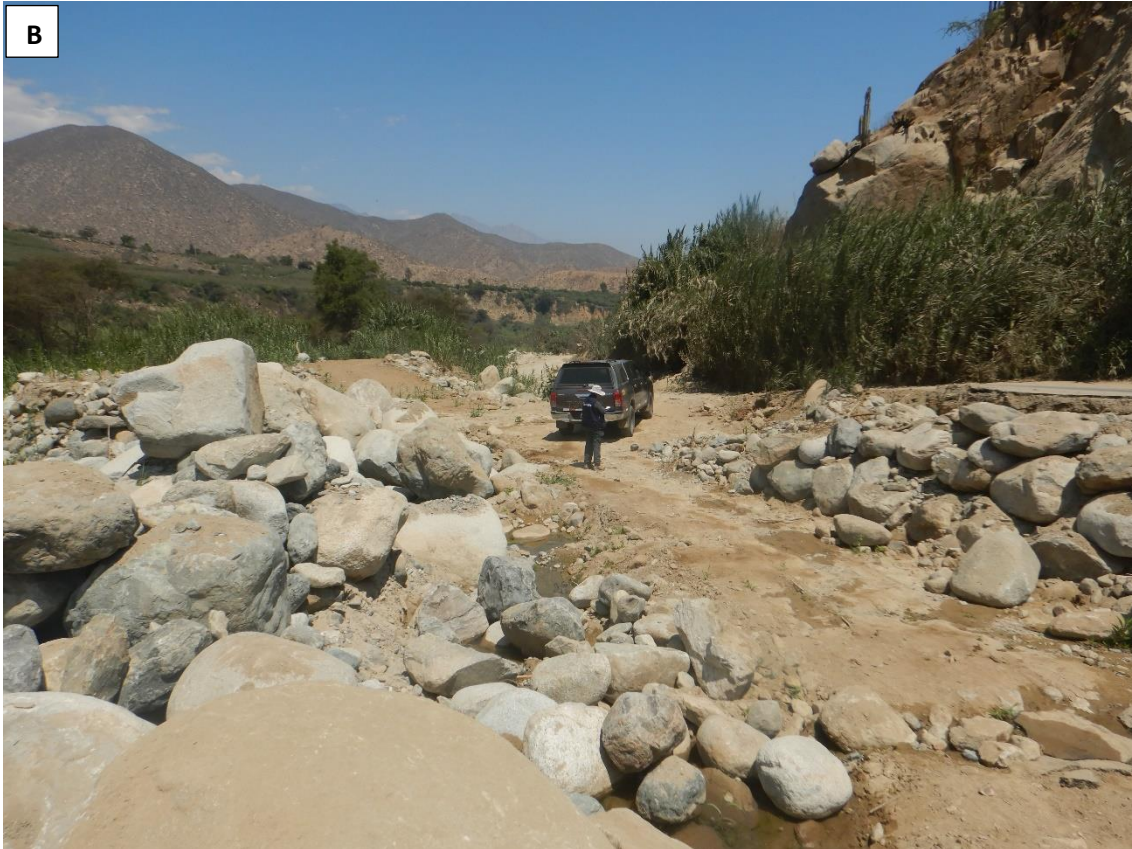
Figura 14. Zona crítica 02-069. Zona afectada por flujo de detritos y erosión fluvial, A) Tramo de carretera afectada por erosión fluvial, destruyendo un total de 45 m, B) Tramo de carretera afectada por flujos de detritos.
