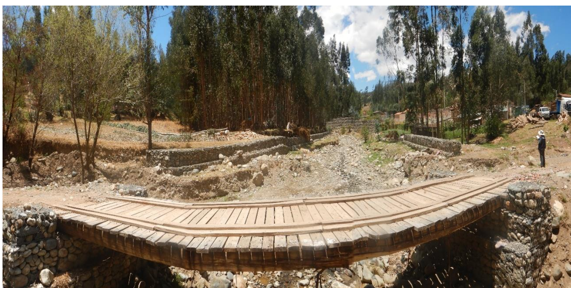
Fotografía 42. Zona crítica 02-025. Quebrada San Miguel de Aco colmatado por flujos de detritos compuestos por diferentes tamaños de bloques arrastrados a lo largo de la quebrada, instalaron gaviones en ambas márgenes del cauce. Coordenadas UTM: 8963830 / 217430, Zona 18. Tomada el 21-09-2023.
