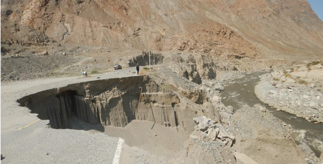
Fotografía 59. Zona crítica 02-053. Proceso de erosión fluvial que afecta 85 m de longitud de la vía Santa -Caraz.
