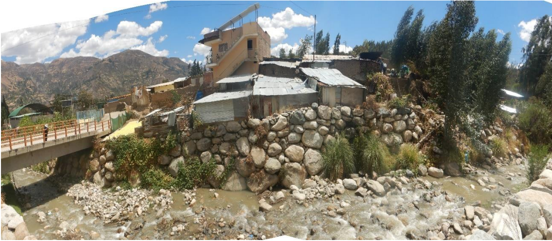
Fotografía 39. Zona crítica 02-017. Viviendas asentadas al borde del río en la margen derecha de la quebrada Obraje, afectado por flujo de detritos en periodos de lluvias con el incremento del caudal del río.
