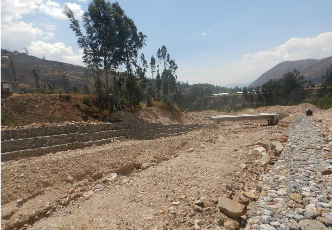
Fotografía 34. Zona crítica 02-011. Sector Olivopampa, cauce de la quebrada colmatado por depósitos de flujos de detritos.
