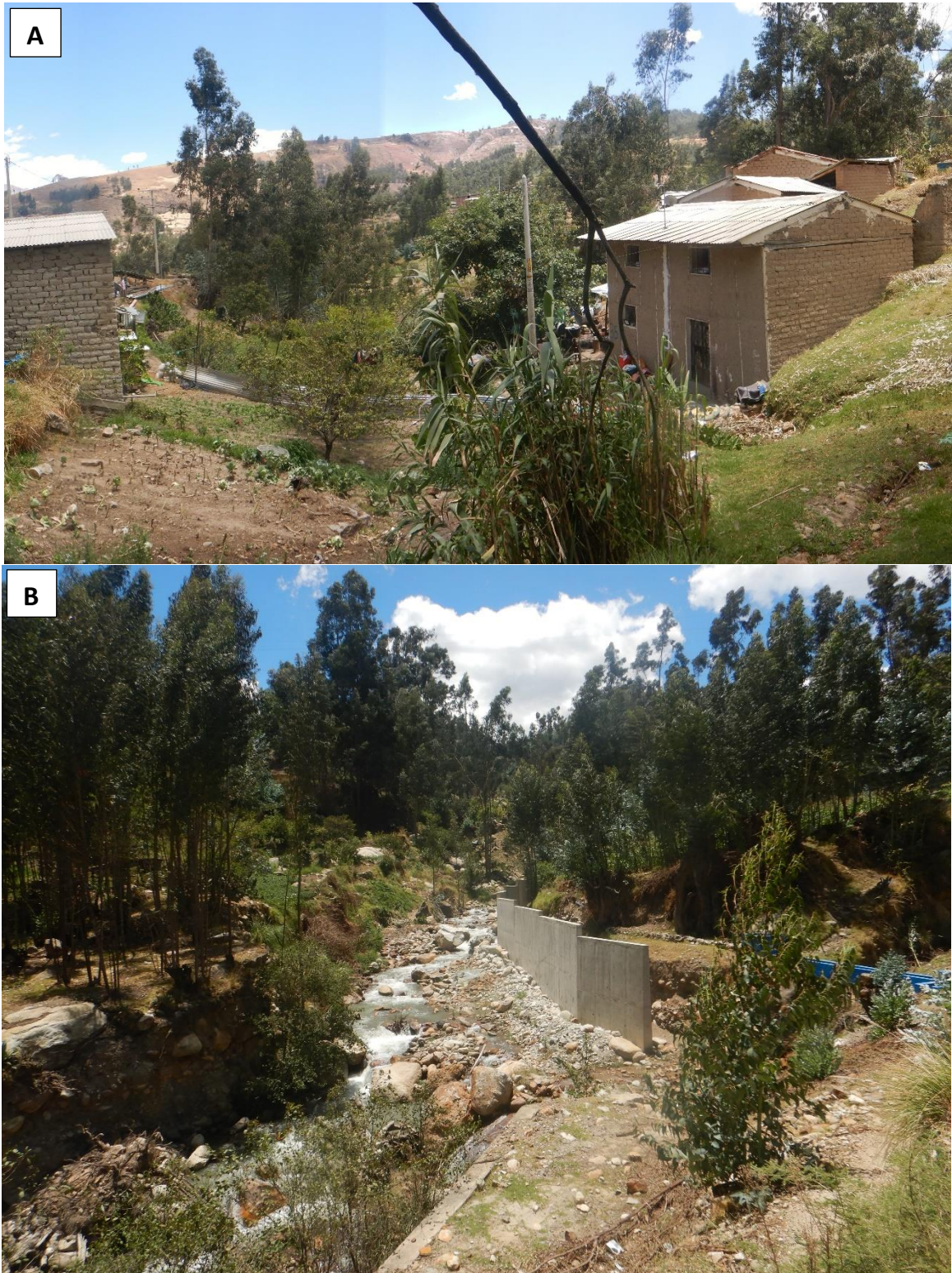
Figura 6. Zona crítica 02-016. Zona afectada por flujo de detritos y erosión fluvial A) Sector Pariacacá afectado por flujo de detritos. B) Instalación de muro de contención en la margen izquierda de la quebrada, con el fin de evitar la erosión fluvial. Coordenadas UTM: 8975477 / 212974, Zona 18. Tomada el 22-09-2023.
