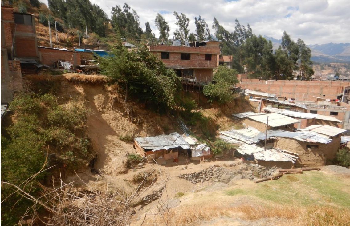
Fotografía 28. Zona crítica 02-004. Viviendas asentadas dentro del cauce de la quebrada Cochac, con evidencia de erosión fluvial en la margen izquierda de la quebrada. Coordenadas UTM: 8946107 / 220456, Zona 18. Tomada el 09-09-2023.
