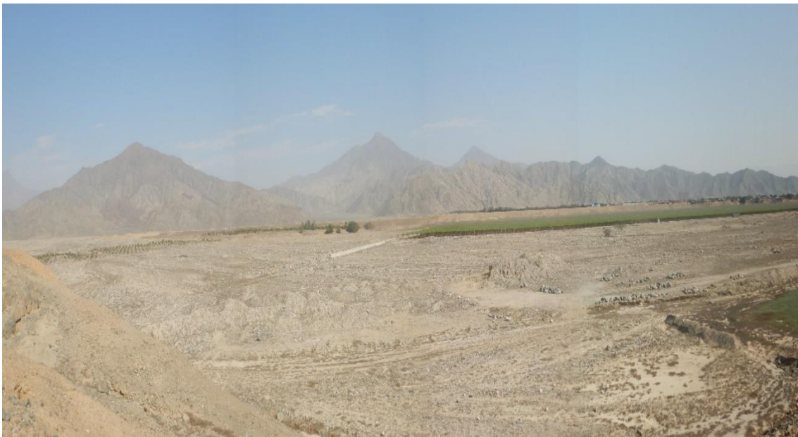
Fotografía 47. Zona crítica 02-033, Zona de depósito de la quebrada de río Seco, dentro del cauce se evidencia un dique transversal de concreto construido con el fin de proteger los terrenos cultivo de uva. Coordenadas UTM: 8956235 / 807056, Zona 17. Tomada el 23-09-2023.
