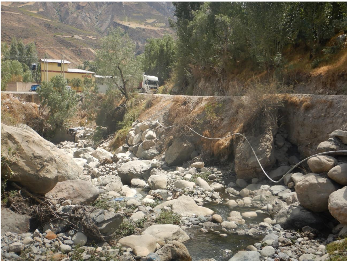
Fotografía 40. Zona crítica 02-018. Tramo de carretera afectada por erosión fluvial, se evidencia el cauce del río Negro colmatado con bloques de hasta 2 m de diámetro.
