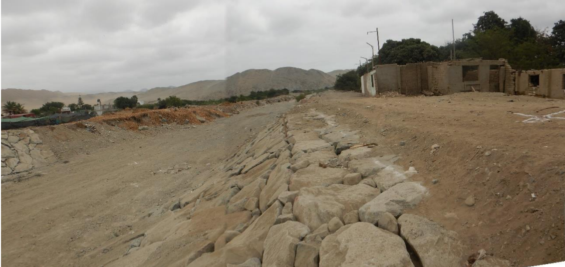
Fotografía 44. Zona crítica 02-028. Aguas abajo del puente Sechín, el flujo de detritos destruyó 03 viviendas en la margen derecha del río, se evidencia 30 m de enrocado en ambas márgenes, construidas después del ciclón Yaku.
