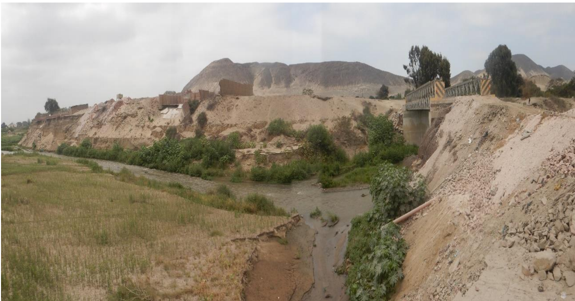
Fotografía 74. Zona crítica 02-089. Viviendas destruidas por la erosión fluvial, los estribos del puente Huacachaloque son afectados por los flujos de detritos compuestos por diferentes tamaños de bloques arrastrados a lo largo de la quebrada. Coordenadas UTM: 9006066 / 764992, Zona 17. Tomada el 04-09-2023.
