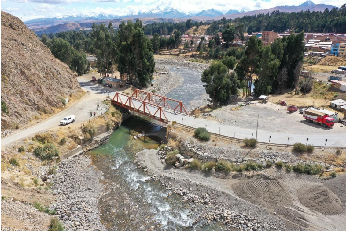
Fotografía 84. Zona crítica 02-106. Vista del puente Parcos afectado por flujo de detritos en el 2017. Así mismo se observa erosión fluvial en las márgenes del río Santa, en el extremo sur de Catac (aguas arriba del puente de paso). Por otro lado, las viviendas ubicadas muy cerca al cauce podrían ser afectadas por erosión fluvial, flujo de detritos e inundaciones caso se obstruya el paso del agua en el puente (por entrapamiento de material). Coordenada UTM: 8915124 / 233279, Zona 18 L. Tomada el 10-09-2023.
