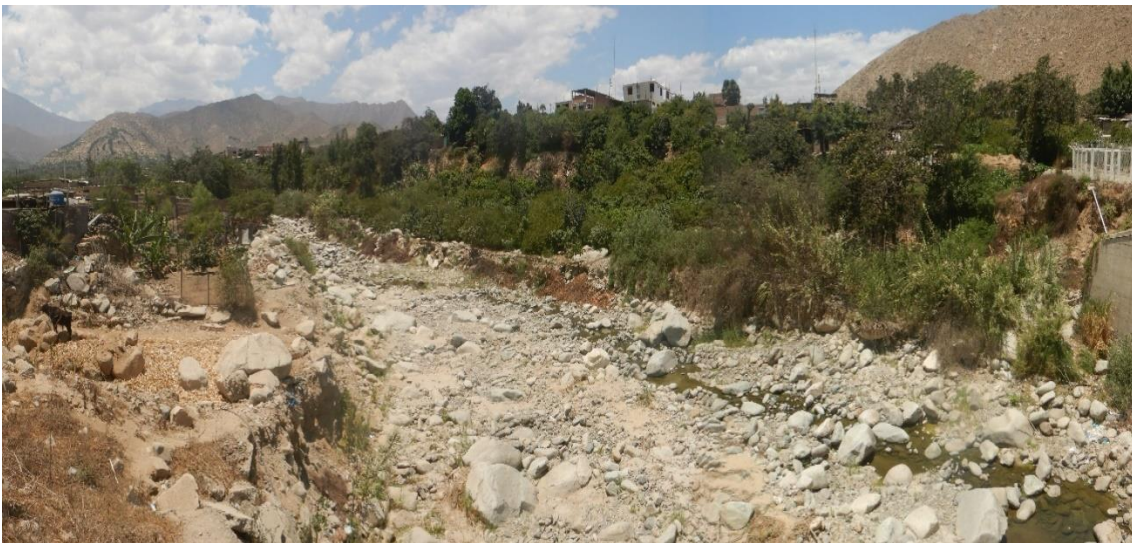
Fotografía 51. Zona crítica 02-037. Vista hacia aguas arriba del cauce del río Yautan, el cual se encuentra colmatado por depósitos de flujos de detritos y ocurre procesos de erosión fluvial en ambas márgenes del río. Coordenadas UTM: 8947077/ 829354, Zona 17. Tomada el 23-09-2023.
