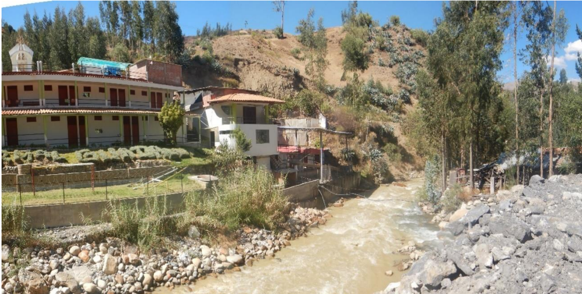
Fotografía 41. Zona crítica 02-023. Erosión fluvial afectando ambas márgenes del río Vicos, el flujo de detritos en temporada de lluvias sobrepasa el muro de contención del hotel. Coordenadas UTM: 8968737 / 216850, Zona 18. Tomada el 21-09-2023.
