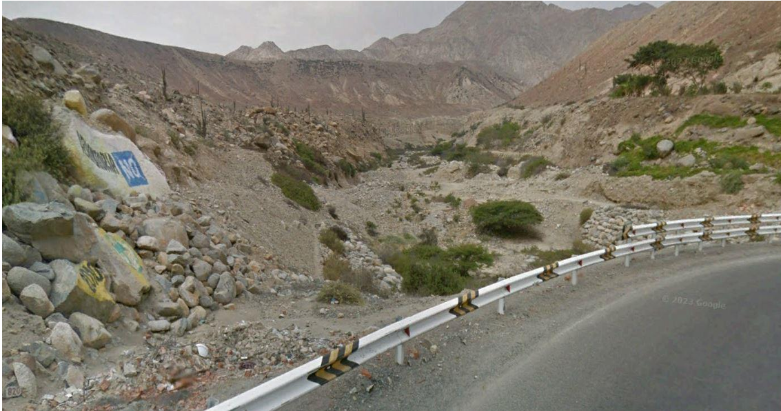
Fotografía 92. Zona crítica 02-115. Vista aguas arriba del puente Chasquitambo / San Marcos, existe bastante material suelto disponible en el cauce que puede ser acarreado en forma de flujo de detritos en temporada de lluvias intensas y/o extraordinarias. Coordenadas UTM: 8857533 / 212322, Zona 18 L. Tomado el 17-09-2023.
