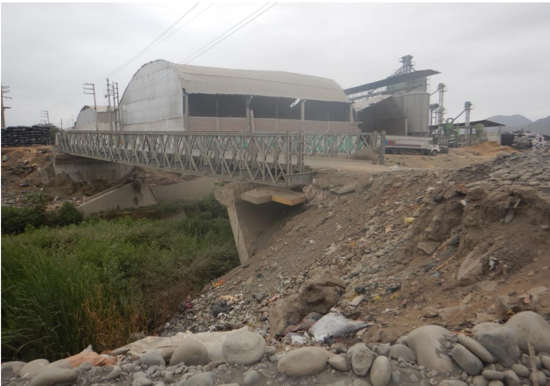
Fotografía 64. Zona crítica 02-062. Erosión fluvial que afecta los estribos del puente de acceso principal al poblado Tambo Real.
