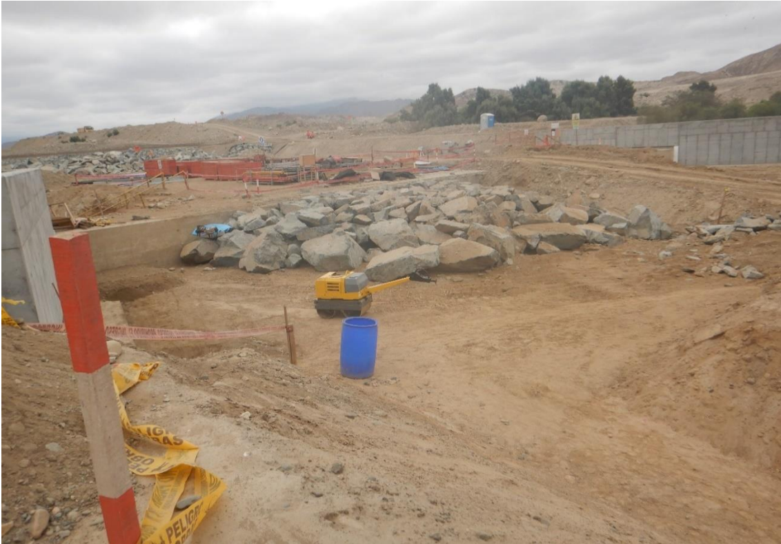
Fotografía 65. Zona crítica 02-063. Río Lacramarca (sector chachapoyas), actualmente se realizan obras de ampliación del cauce del río y enrocados en ambas márgenes del río. Coordenadas UTM: 9009491 / 779413, Zona 17. Tomada el 03-09-2023.
