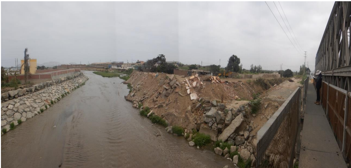
Fotografía 68. Zona crítica 02-070. Cauce del río denominado acequia, aguas abajo se evidencia 350 m destruyendo parte de infraestructura de fábricas y afectado por procesos de erosión fluvial en la margen derecha del cauce del río y se observa depósitos de desmonte sobre el cual se asientan viviendas.
