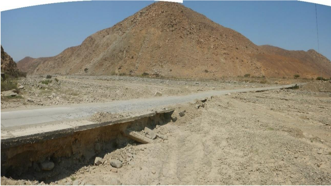
Fotografía 61. Zona crítica 02-056. Quebrada Cayhuamarca se activa en períodos de lluvia afectando el tramo de la vía Santa – Caraz, socavando la base de la plataforma de vía. Coordenadas UTM: 9036696 / 787200, Zona 17. Tomada el 01-09-2023.
