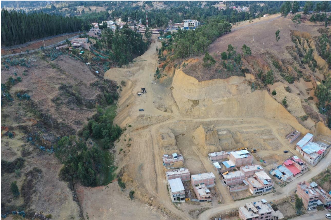
Fotografía 33. Zona crítica 02-010. Corte de talud que provocan rellenos del cauce de la quebrada, sobre este depósito inestable de relleno se asientan viviendas. Coordenadas UTM: 8946900 / 224166, Zona 18. Tomada el 22-09-2023.
