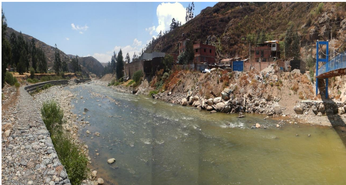
Fotografía 26. Zona crítica 02-002, Viviendas y gaviones afectados durante el ciclón Yaku 2023 por erosión fluvial y flujo de detritos, ubicados en ambas márgenes del río Santa. Coordenadas UTM: 8941731 / 221268, Zona 18. Tomada el 11-09-2023.
