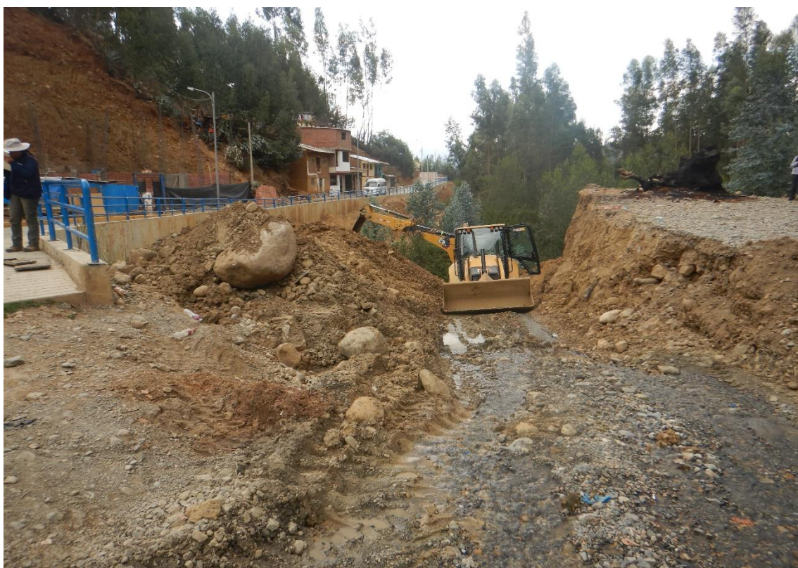
Fotografía 27. Zona crítica 02-003. Cauce de la quebrada río Auqui colmatado completamente por depósitos de flujos de detritos. Coordenadas UTM: 8945286 / 224616, Zona 18. Tomada el 11-09-2023.
