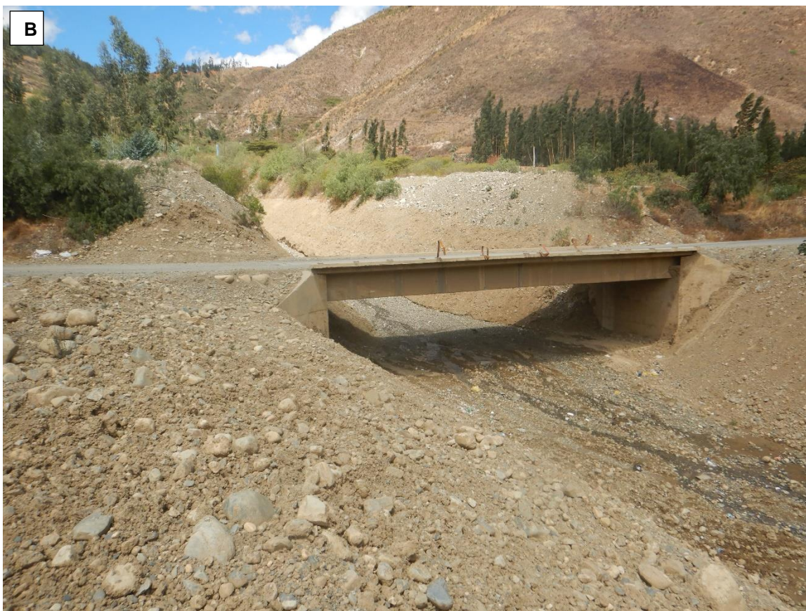
Figura 8. Zona crítica 02-024. A) Sector Pumpuc afectado por flujo de detritos, destruyó parte de la infraestructura del puente, ubicado con coordenadas N: 8963644; E: 215951. B) Sector Caztunapampa afectado por flujo de detritos, durante el ciclón Yaku destruyó parte de la estructura del puente, ubicado con coordenadas N:8962633; E:216275. Zona 18. Tomada el 21-09-2023.
