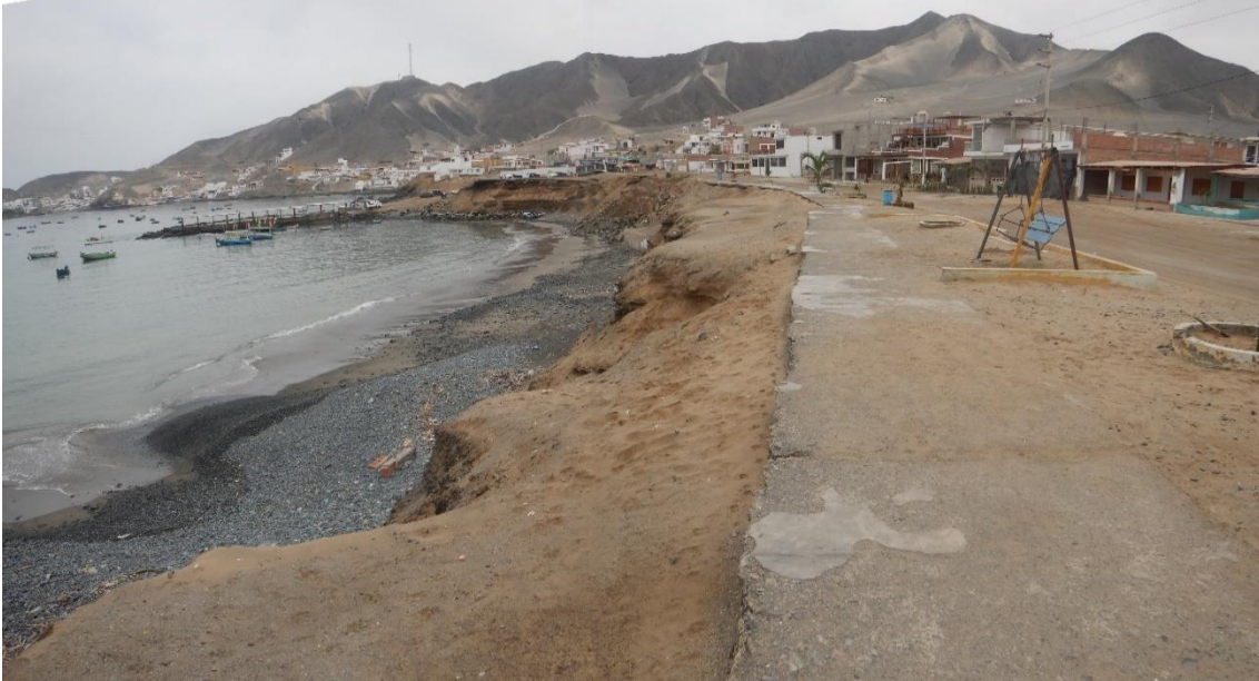
Fotografía 48. Zona crítica 02-034. Tortugas, zona afectada por flujo de detritos, en particular la bahía es afectado por erosión marina.
