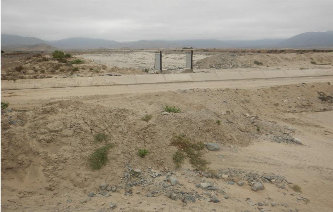
Fotografía 75. Zona crítica 02-090. Canal de riego y terrenos de cultivos afectados por los flujos de detritos recurrentes periódicamente en temporada de lluvias. Coordenadas UTM: 8995948 / 785555, Zona 17. Tomada el 05-09-2023.
