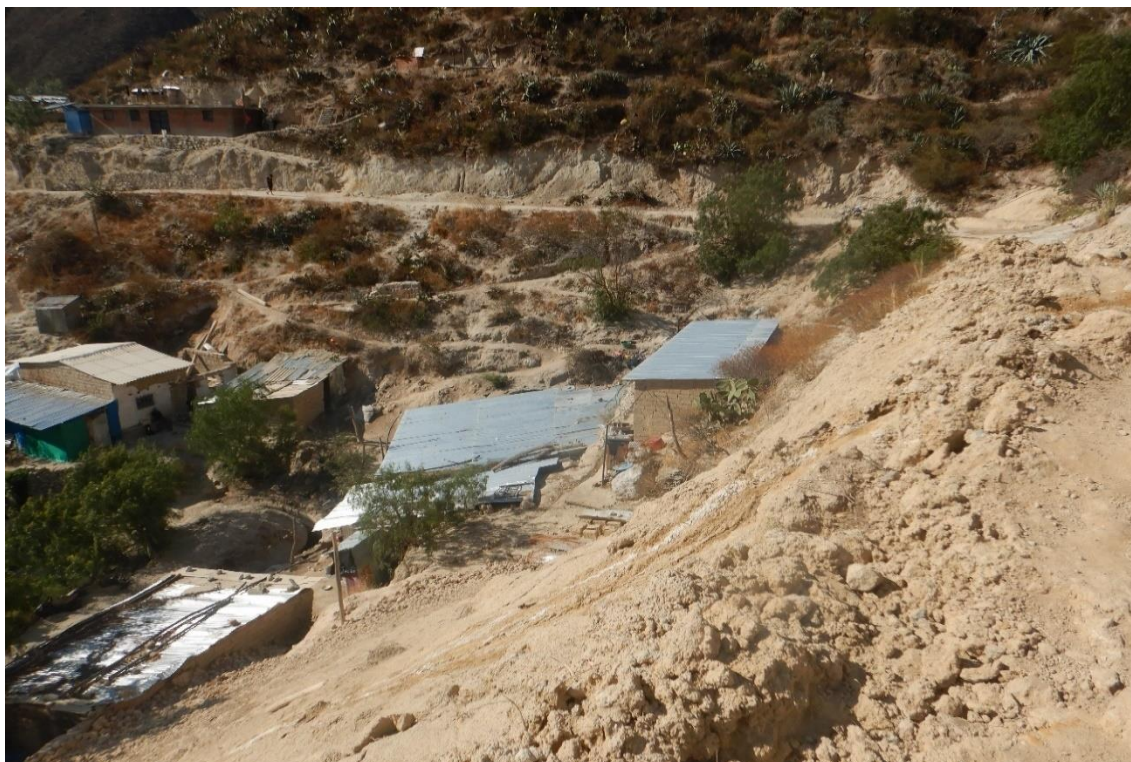
Fotografía 53. Zona crítica 02-041. Se observa viviendas actualmente habitadas asentadas al pie del deslizamiento rotacional activo.
