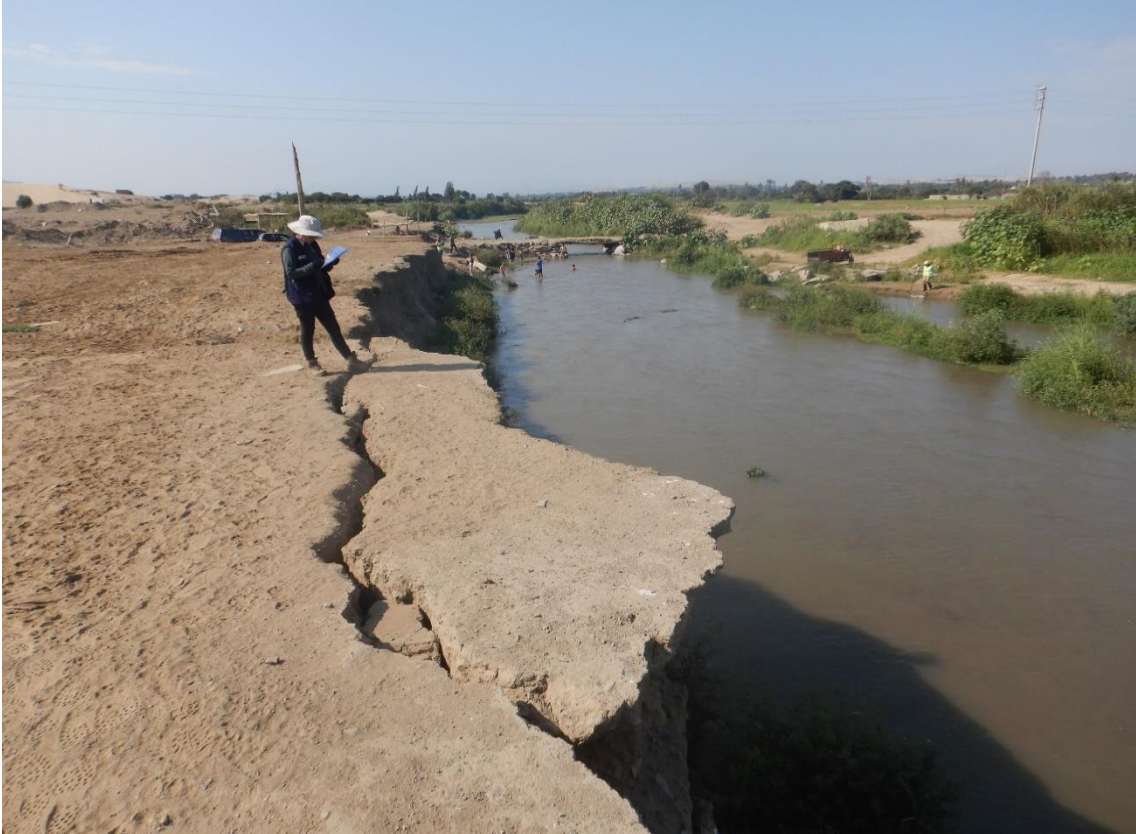
Fotografía 67. Zona crítica 02-066. Ocurre socavamiento fluvial, con una longitud erosionada de 300 m. afectando estructura de un puente rustico y terrenos agrícolas (en el margen derecho del río Lacramarca).
