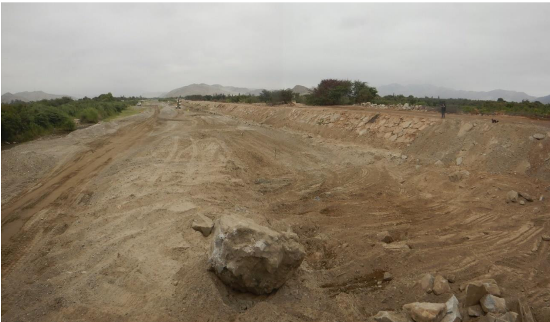
Fotografía 49. Zona crítica 02-035. Puente Tabón, fue destruido durante el FEN 2017, afectada periódicamente por flujo de detritos compuestos por diferentes tamaños de bloques arrastrados a lo largo de la quebrada, actualmente realizan trabajos de enrocados en ambas márgenes del río.
