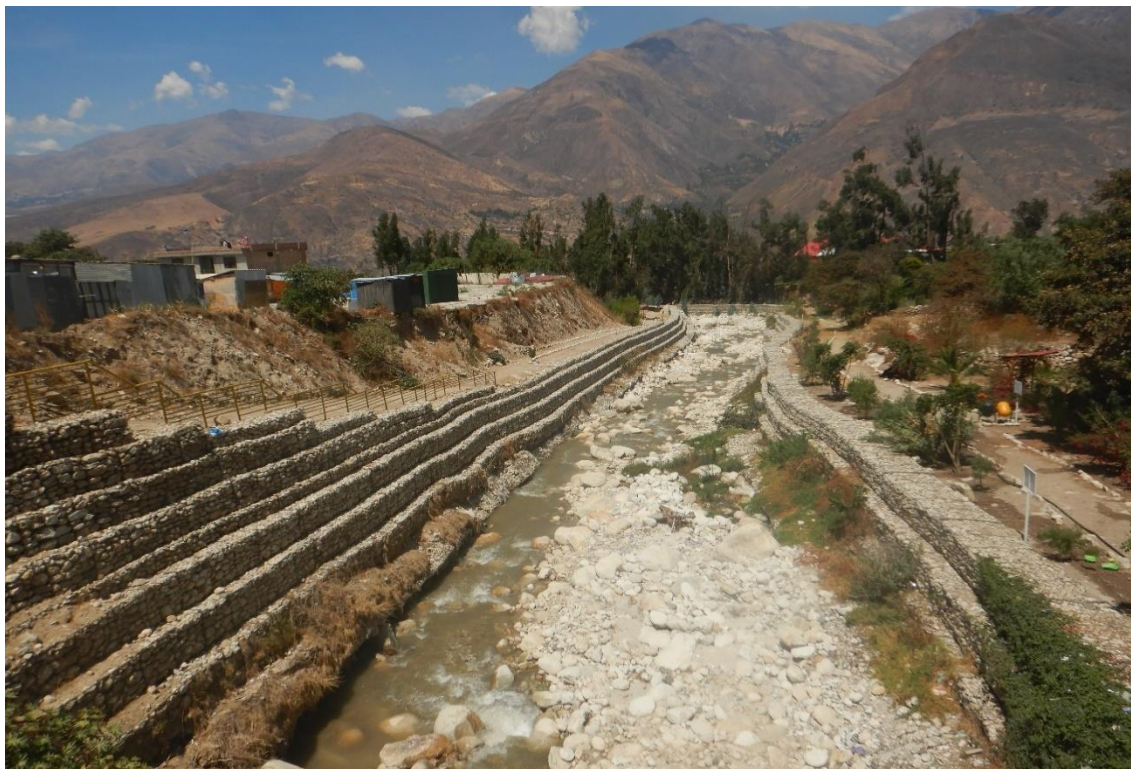
Fotografía 52. Zona crítica 02-040. Río Llullan activada durante el ciclón Yaku en su paso por el sector se desbordó aguas abajo afectando viviendas en la margen izquierda del río, los gaviones instalados presentan socavamiento en su base.
