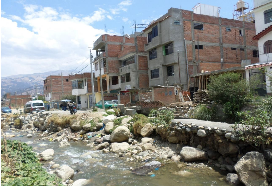
Fotografía 32. Zona crítica 02-009. Cauce del río Paria, se evidencia erosión fluvial socavando la margen derecha del cauce, aguas abajo ocurre desbordamiento del río en temporadas de lluvias. Coordenadas UTM: 8946044 / 223540, Zona 18. Tomada el 13-09-2023.
