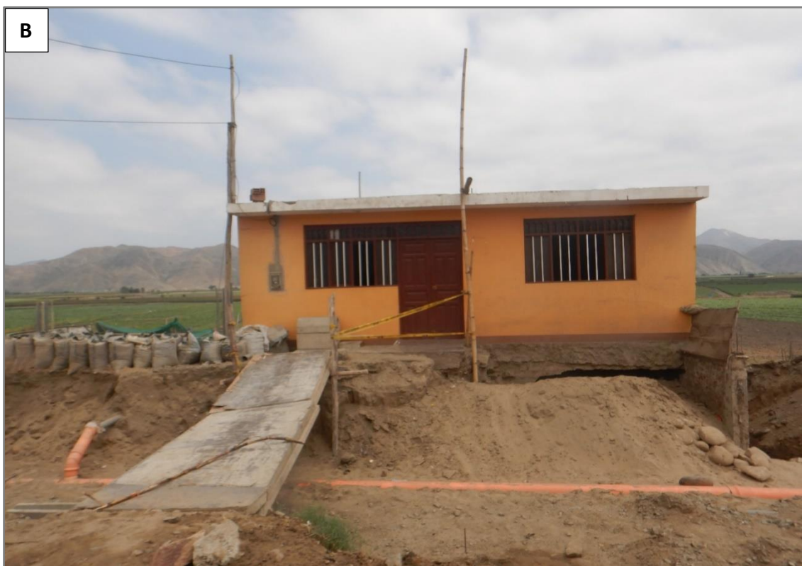
Figura 12. Zona crítica 02-060. El poblado La Rinconada, afectada periódicamente por inundación pluvial y flujo de detritos, A) viviendas destruidas por el desborde del canal que cruza el poblado B) vivienda socavada en la base, actualmente realizan obras de reconstrucción. Coordenadas UTM: 9016420 / 767820, Zona 17. Tomada el 02-09-2023.
