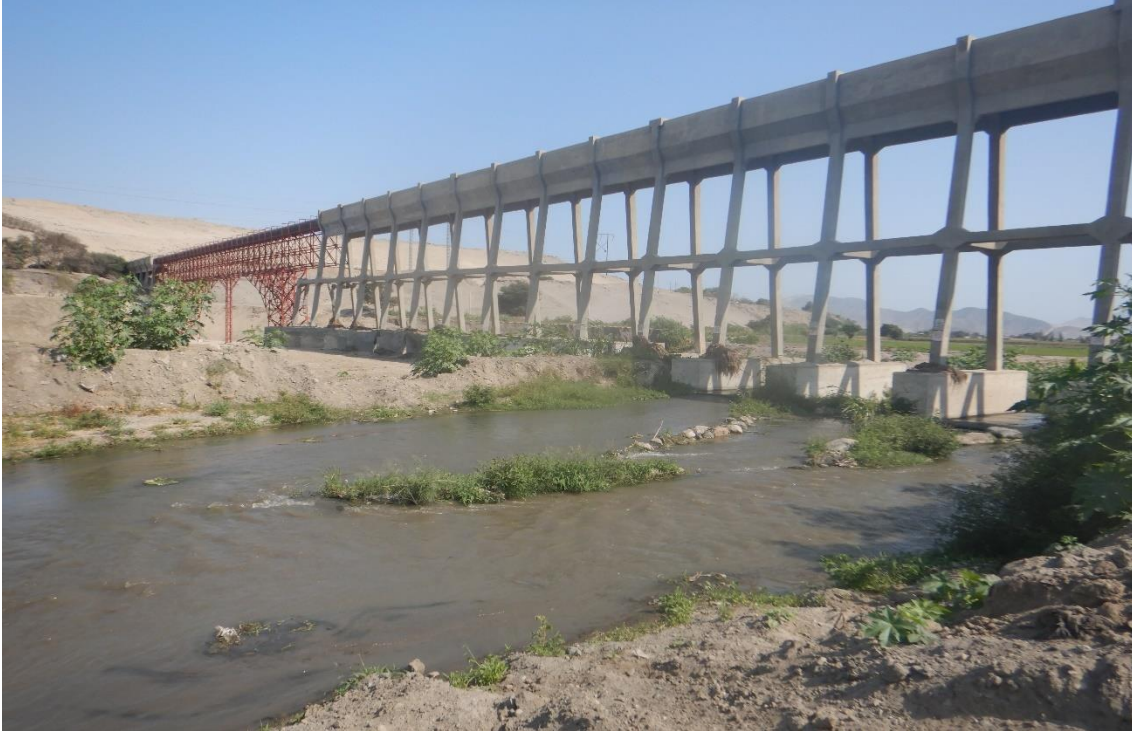
Fotografía 63. Zona crítica 02-061. Quebrada que fue reactivada con el ciclón Yaku 2023, el flujo de detritos destruyó 12 zapatas/columnas, en el cauce del río ocurren procesos de erosión fluvial en ambos márgenes.
