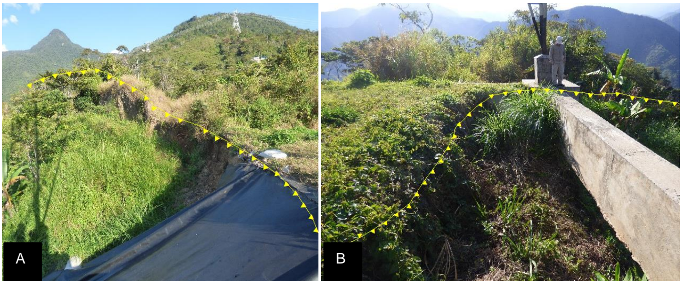
Figura 8. A. Vista hacia el oeste de la torre de alta tensión, se ha señalado la corona del deslizamiento en estado de reactivación (líneas amarillas). B. La corona llega hasta la torre de alta tensión afectando sus cimientos.
