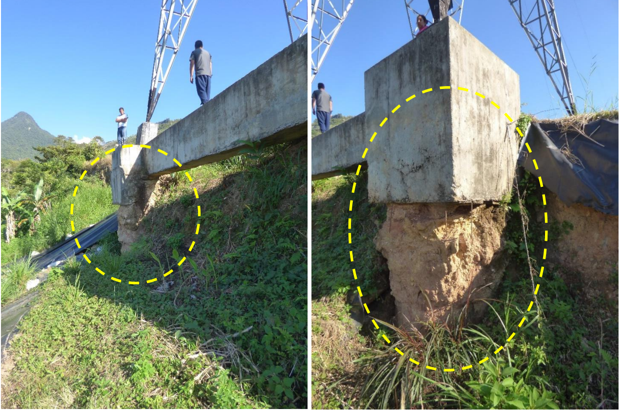
Figura 10. Torre de alta tensión (T-09 N. L2257), se observa la afectación de la cimentación en su base, la socavación ha ido en aumento debido a la reactivación del deslizamiento en este sector.
