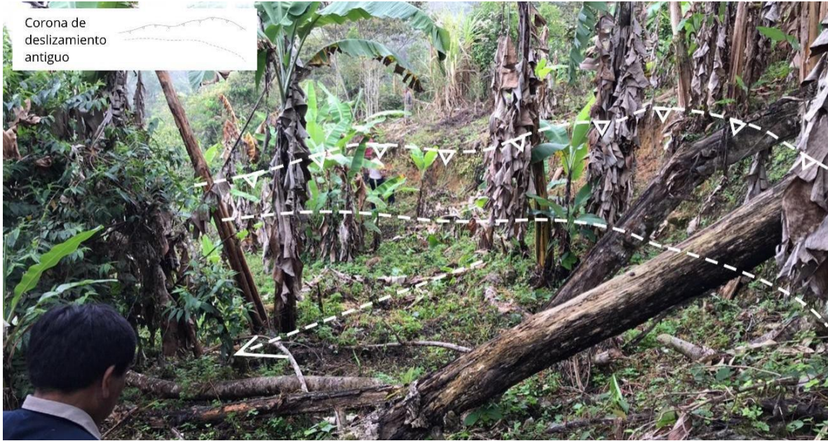
Figura 15. Corona de deslizamiento que afecta torre de alta tensión en San Emilio. Se observa el escarpe erosionado, evidencia de desplazamientos anteriores. Tomada de (Nuñez & Albinez, 2020)
