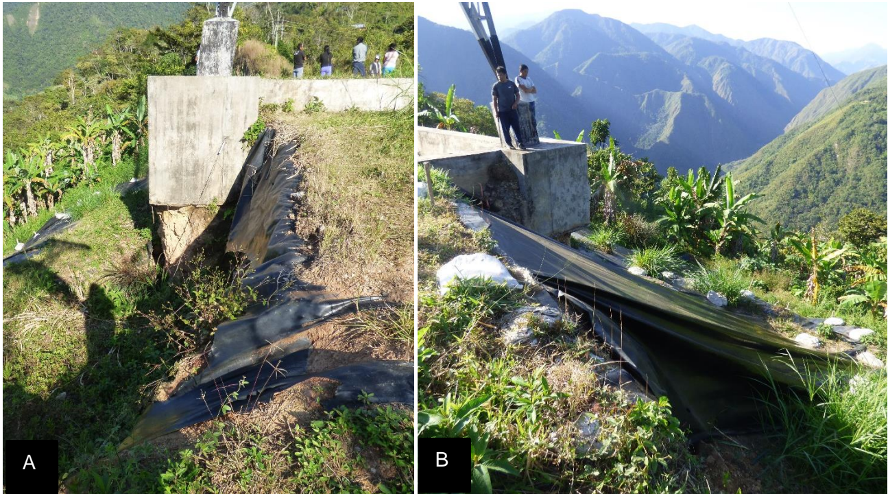
Figura 9. A y B. Muestran geomembranas colocadas con el fin de dar mayor estabilidad a la zona afectada, protegiéndola de la lluvia y evitando la saturación del suelo.
