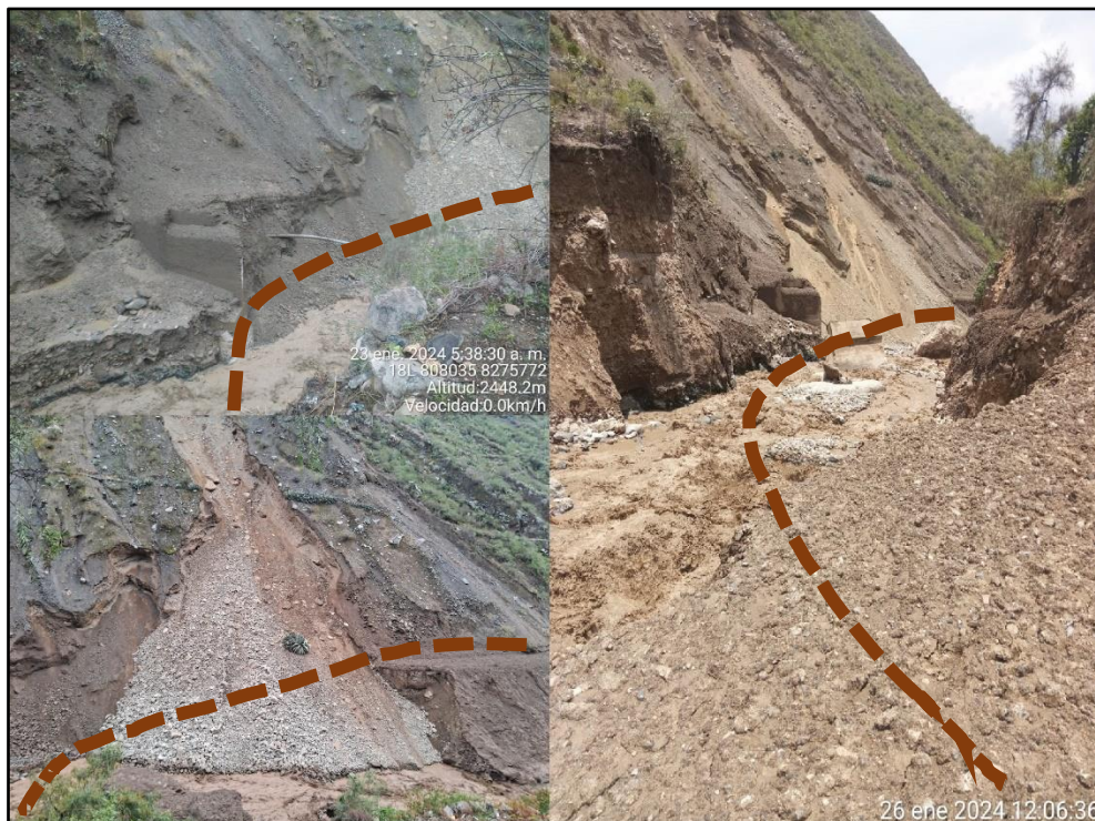
Figura 11. Puente carrozable destruido, principal infraestructura de comunicación del distrito de Choco. Fotografías: Municipalidad de Choco
