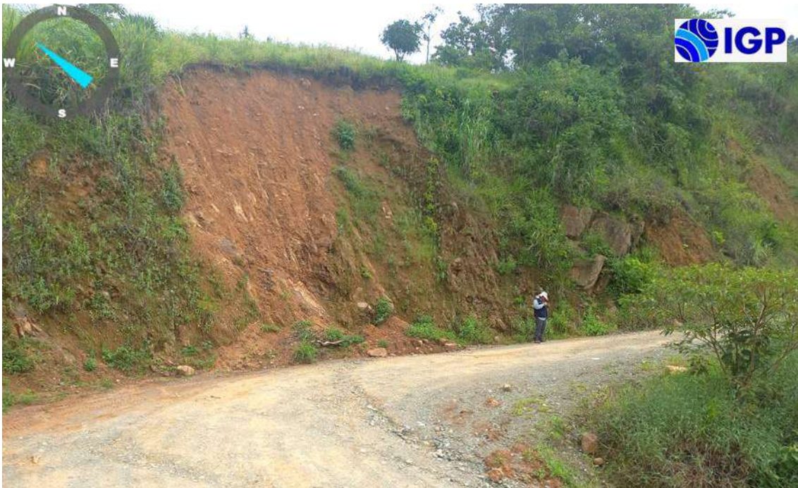
Figura 16.- Formación Grupo San Pedro reconocido en un corte de la vía situada en el extremo noroeste de Montero, está conformada principalmente por lodolitas y lutitas intercaladas con areniscas meteorizadas que se presentan susceptibles a movimientos en masa (deslizamientos y derrumbes)
