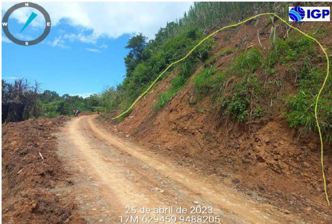
Figura 31.- Deslizamiento (debajo de línea amarilla) ocurrido el presente año, posterior a las lluvias intensas ocurridas el presente año, afectó parte de la vía Montero – Santa Cruz.
