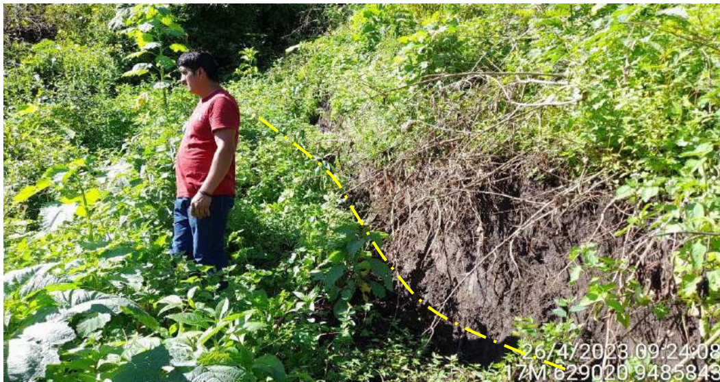
Figura 41.- Zona de arranque en ladera inestable, reconocida en la parte superior de la institución educativa Los Girasoles
