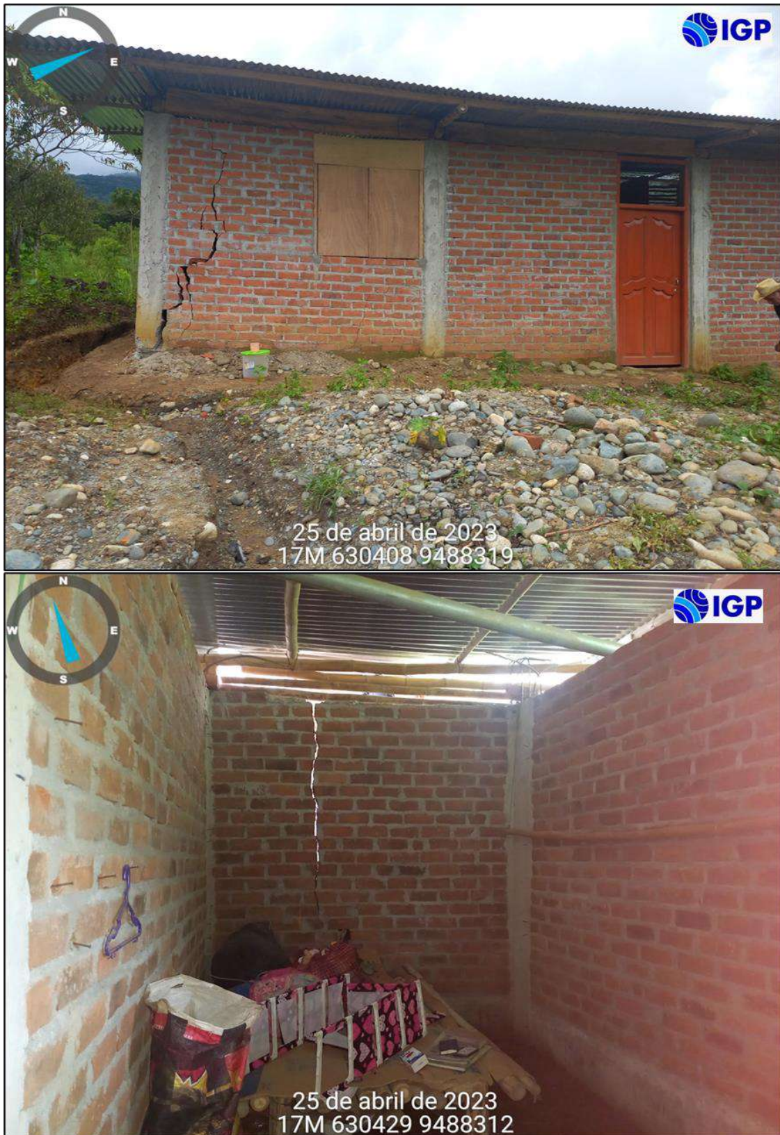
Figura 35.- Grietas en viviendas situadas sobre arcillas saturadas que vienen siendo afectadas por el fenómeno reptación de suelos
