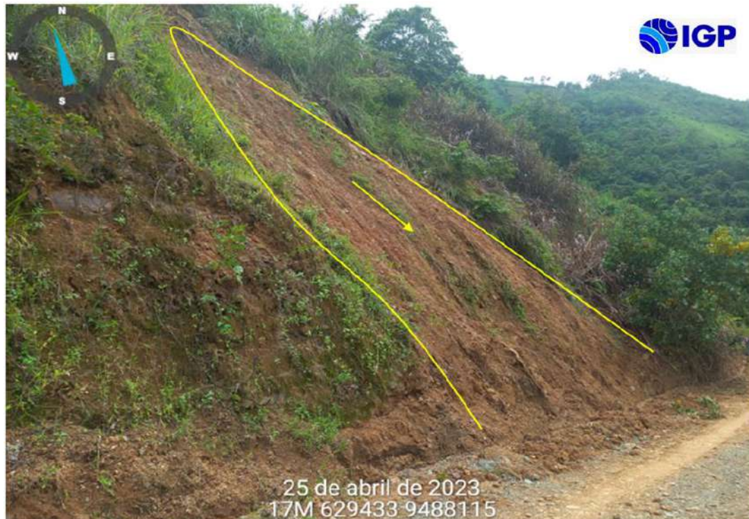
Figura 30.- Derrumbe (debajo de línea amarilla) generado en el sector Z debido a la ocurrencia de precipitaciones pluviales intensas que afectó la vía Montero – Santa Cruz y caseríos aledaños
