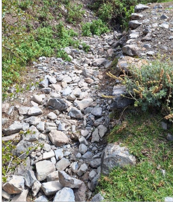
Fotografía 3. Cauce de la quebrada Parizahuayo colmatado de material detrítico originado por huacos antiguos.
