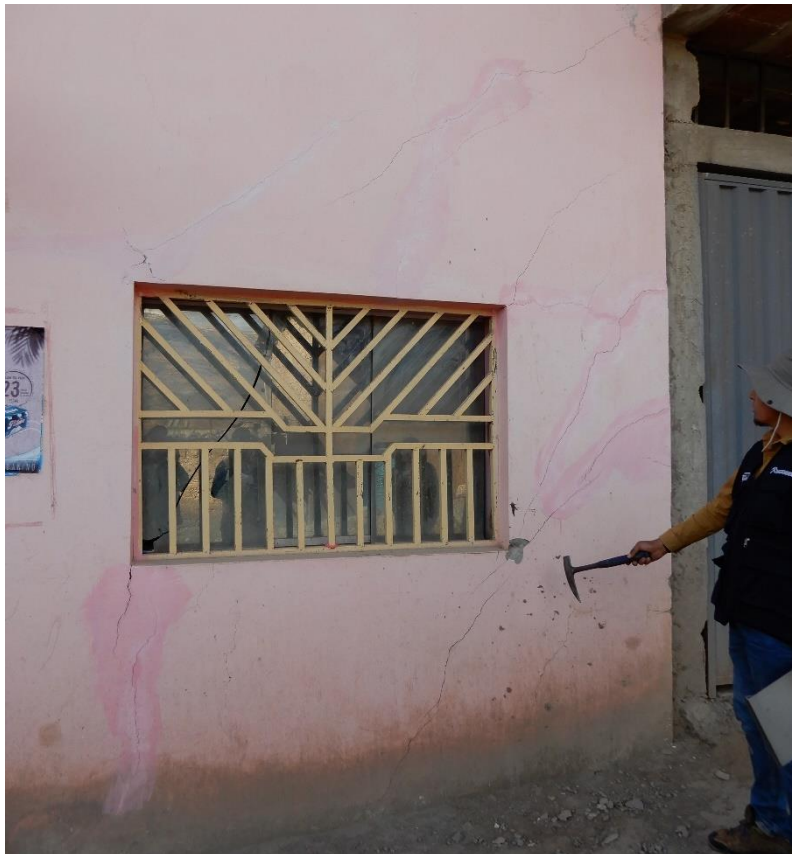
Fotografía 4. Vivienda con fisuras diagonales ocasionadas por el deslizamiento rotacional en la parte alta del barrio Ramón Castilla UTM: 769015 / 9125943, Zona 17.
