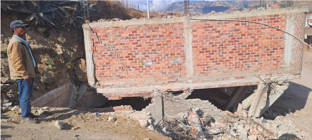
Fotografía 3. Vivienda destruida ubicada en el cuerpo de deslizamiento rotacional activo. UTM: 769015 / 9125943, Zona 17.
