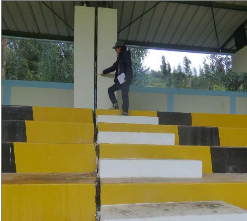
Fotografía 3: Vista de la parte central de la tribuna, con desplazamiento de 7 cm en la parte delantera y 2.4 cm en la parte posterior.
