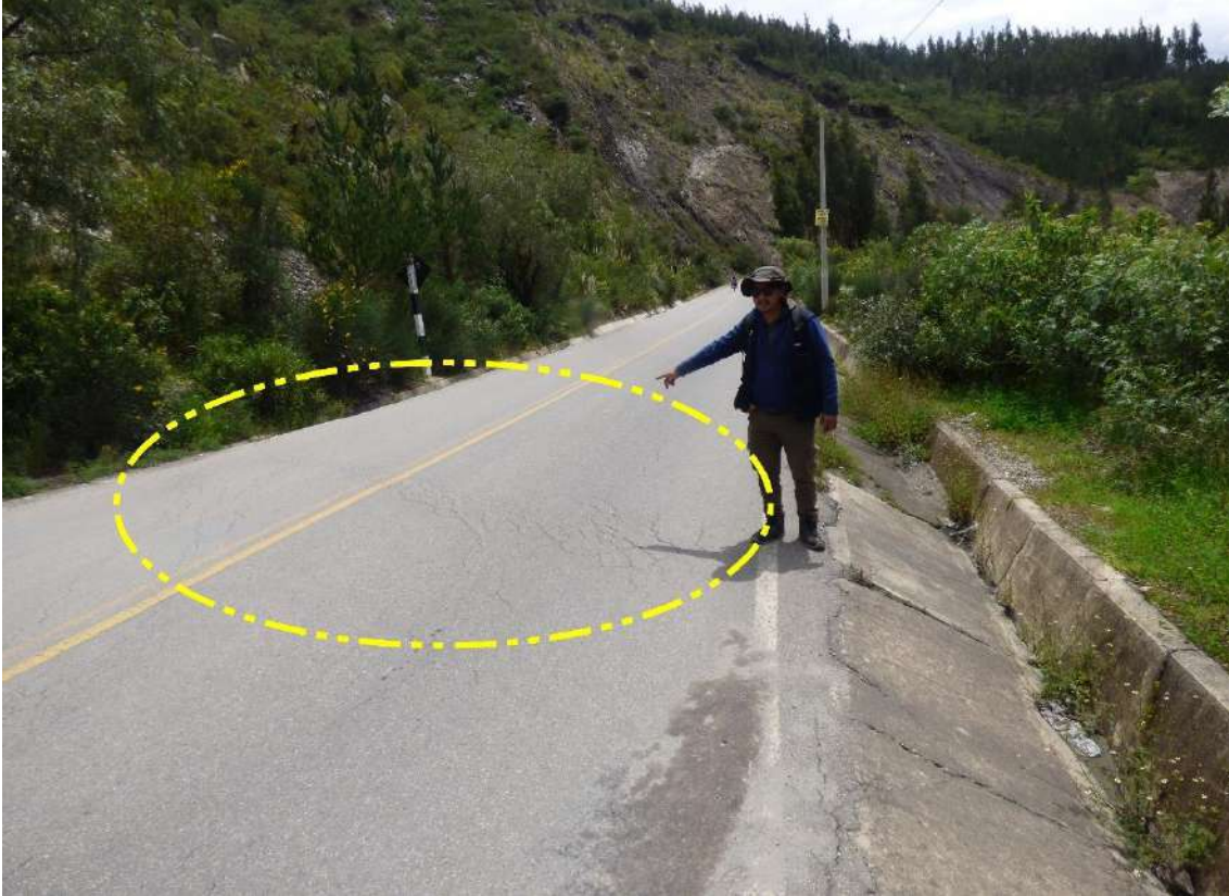
Figura 17. Deformación y agrietamientos milimétricos en la carretera Chavín de Huántar-San Marcos. Estas evidencias son indicativas de reactivaciones del deslizamiento por encima del estadio Municipal Chavín de Huántar. Coordenadas referenciales: UTM WGS84 Zona 18S 261326 E, 8942403 N.
