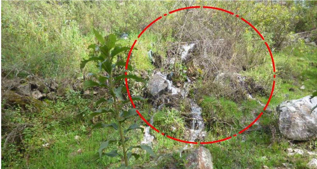
Figura 8: Canal de riego revestido hasta media ladera, lo que hace que el agua continúe su recorrido ladero abajo hasta infiltrarse. Coordenadas referenciales: UTM WGS84 Zona 18S 260618 E, 8942627 N.
