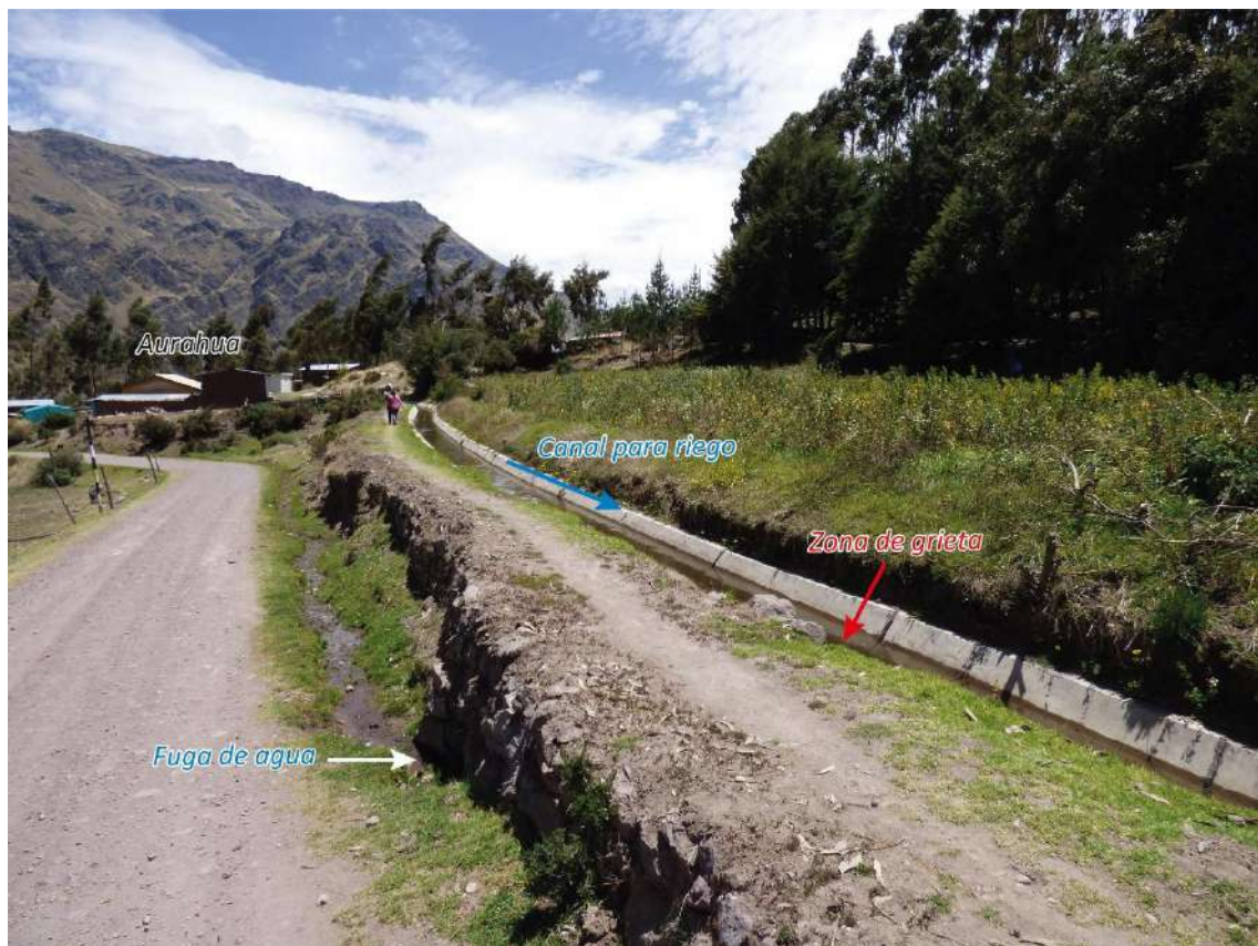
Figura 9. Canal de concreto para riego, con presencia de fugas debió al deterioro y/o agrietamiento del canal por la deformación del terreno.
