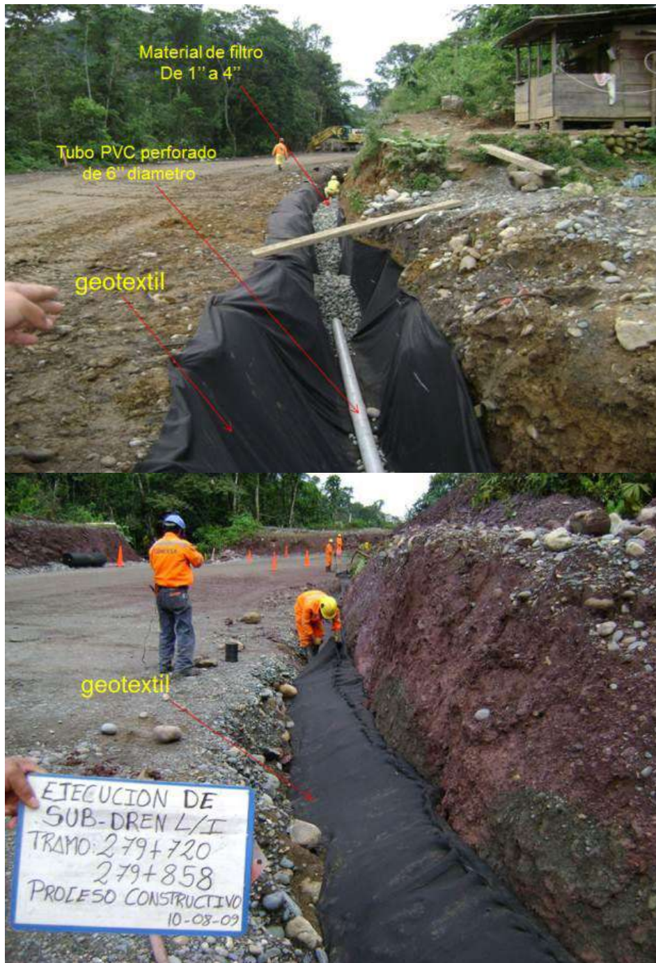
Figura 28, Proceso constructivo de un subdrén tipo D) con tubería cribada, material grueso (Grava) y geotextil, aplicado para drenaje longitudinal. El geotextil es permeable (Farfan et,al 2010).
