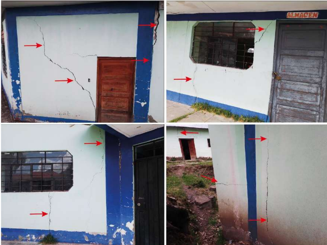
Figura 10. Muros agrietados en infraestructuras de ladrillo y cemento debido a la deformación del terreno.
