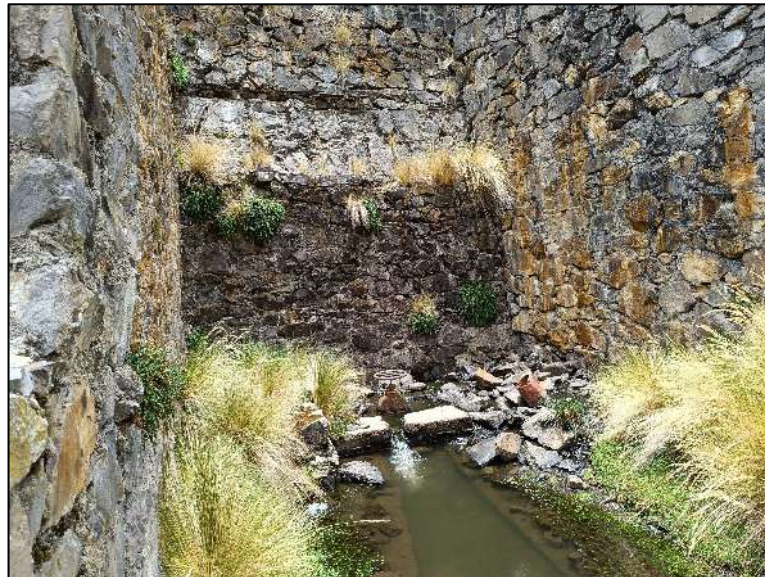
Fotografía N° 20: Vista de la válvula aguas abajo y filtraciones.
