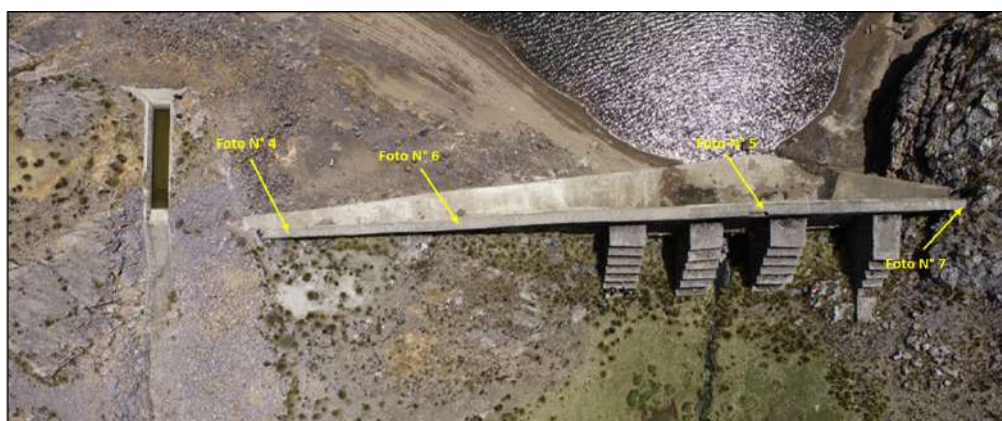
Fotografía Aérea N° 01: Vista en planta (aérea) de las fisuras resaltantes encontradas en la corona.
