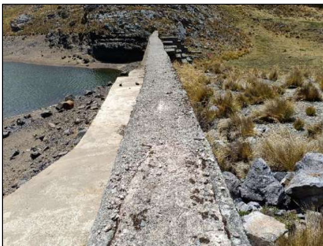
Fotografía N° 04: Fisuras encontradas en la margen derecha.
