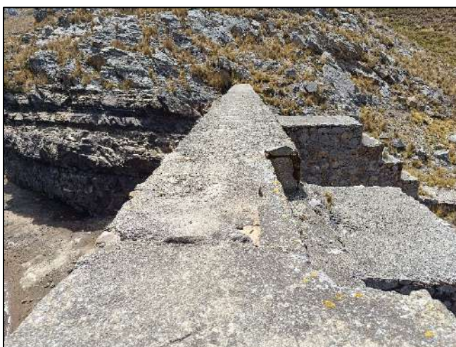
Fotografía N° 05: Fisuras encontradas en la parte central.
