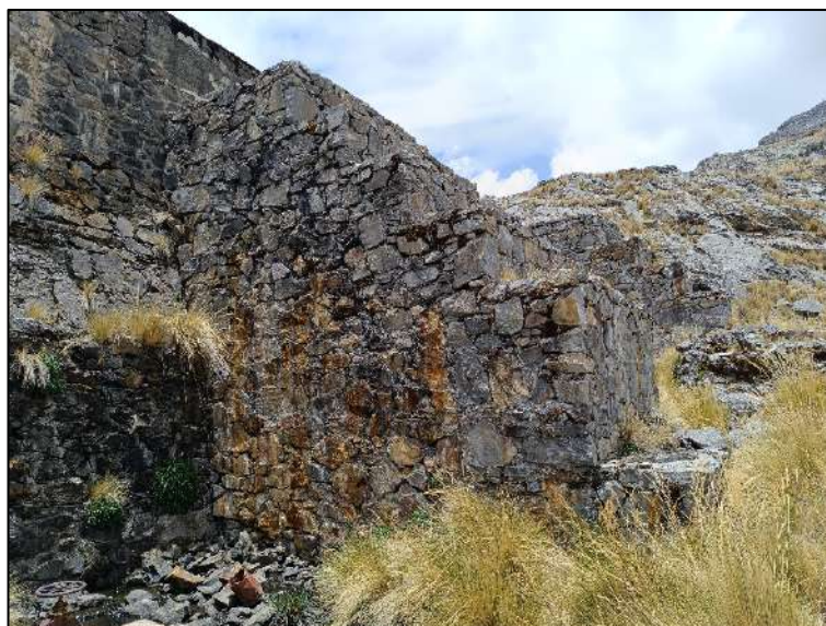
Fotografía N° 19: Fisuras, coloración y vegetación encontradas en los contrafuertes, de la parte central.
