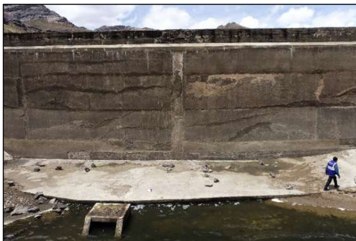
Fotografía N° 13: Fisuras encontradas en la margen central, aguas arriba.
