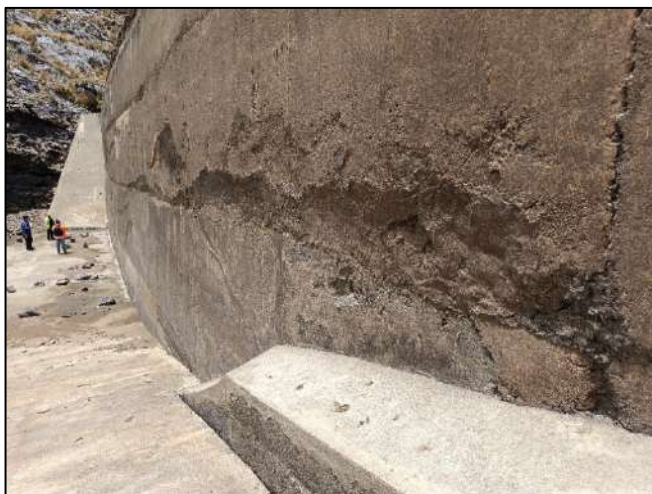
Fotografía N° 12: Fisuras encontradas en la margen derecha y margen central, aguas arriba.
