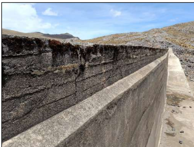
Fotografía N° 10: Fisuras encontradas en la margen izquierda, aguas arriba.
