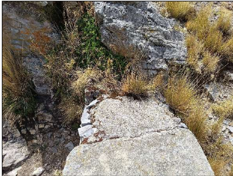
Fotografía N° 07: Fisuras encontradas en la margen izquierda.
