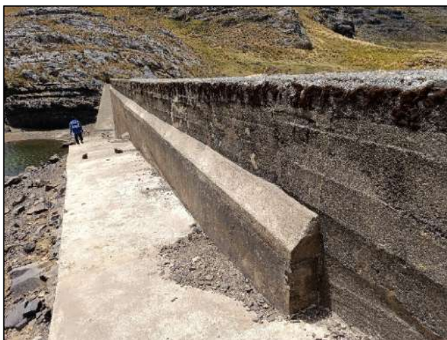
Fotografía N° 11: Fisuras encontradas en la margen derecha, aguas arriba.
