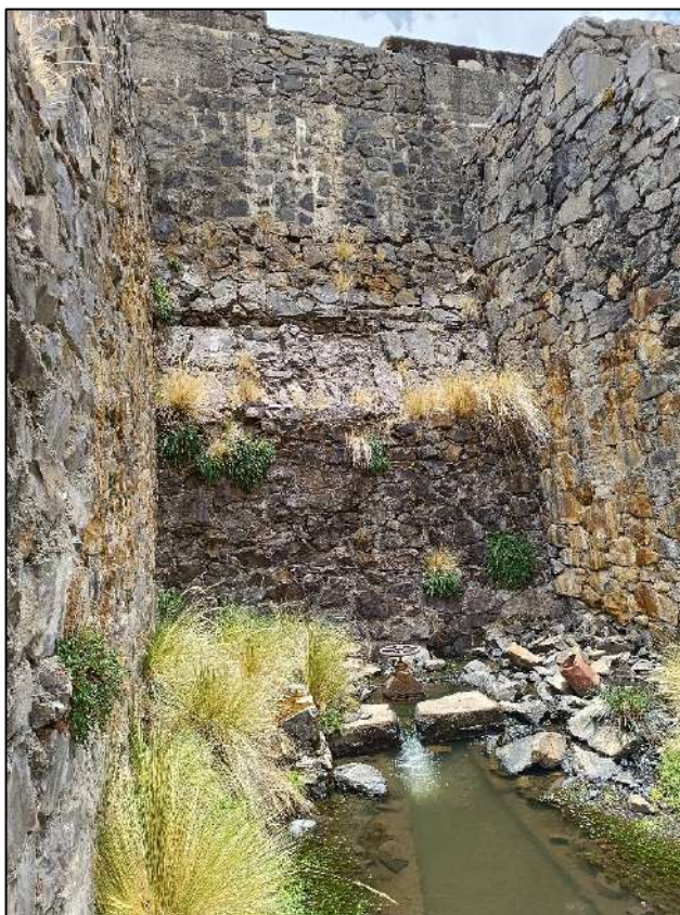
Fotografía N° 18: Fisuras, coloración y vegetación encontradas en la parte central.
