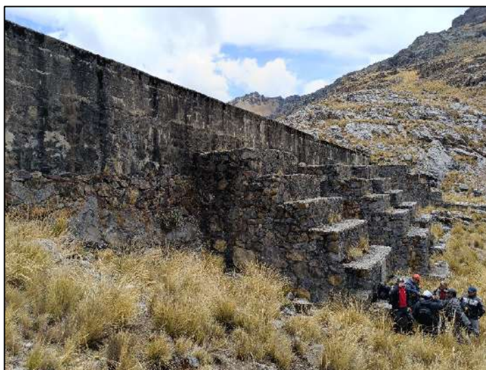
Fotografía N° 16: Fisuras y coloración encontradas en la margen derecha.
