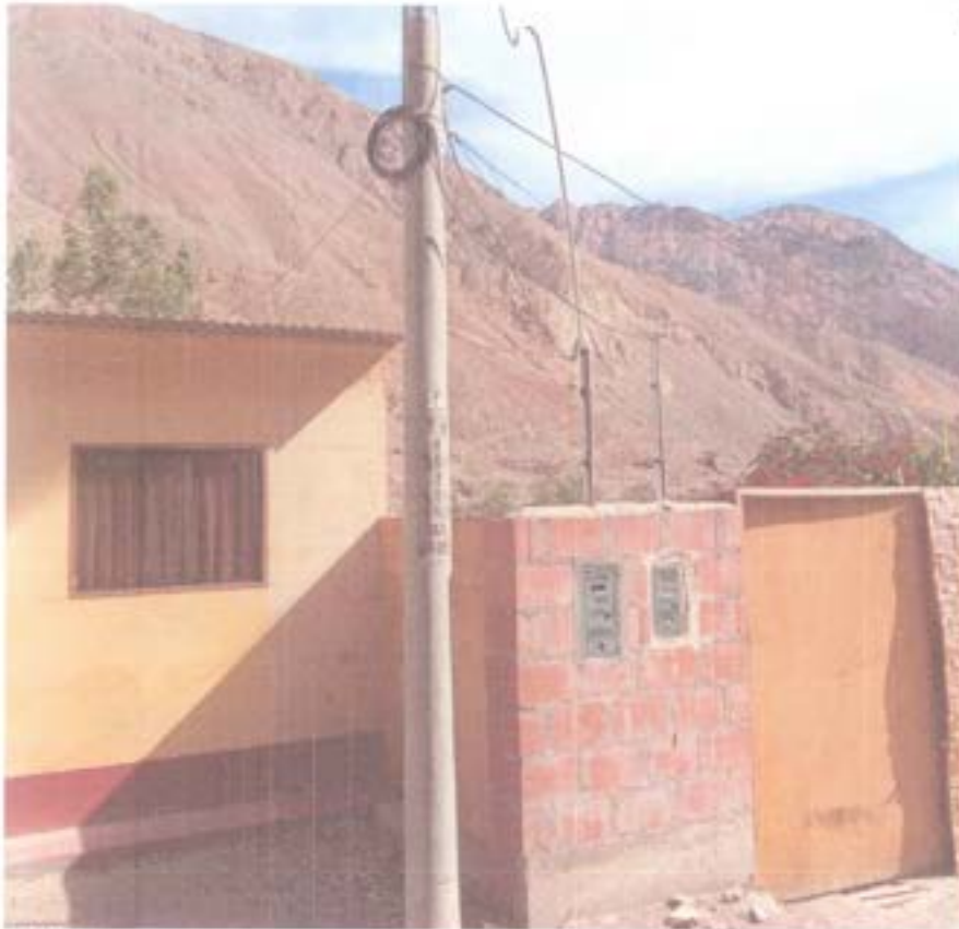
Fotografía 18 Red pública de alumbrado en viviendas ubicadas en la carretera a Curibaya.
