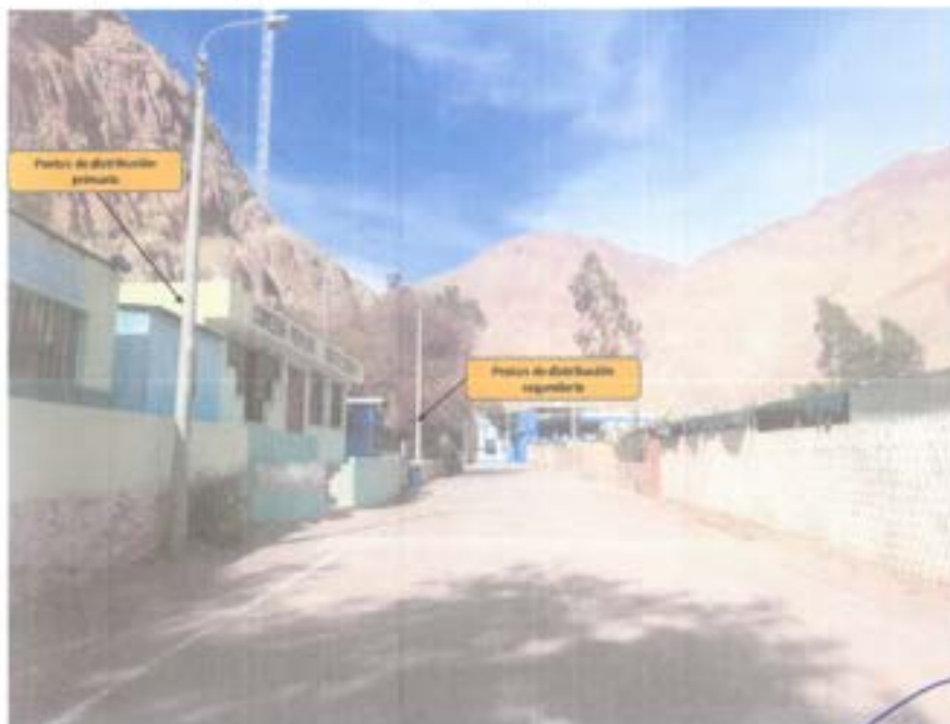
Fotografía 62 Identificación de postes de red primaria y secundaria
