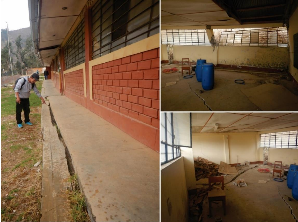
Figura 18. Se observa institución educativo primario N° 22097 Pichuta, con grietas en los pisos y paredes, también se observó que la estructura de una ventana esta inclinando producto del empuje del suelo; así como afectación en la vereda del frontis.
