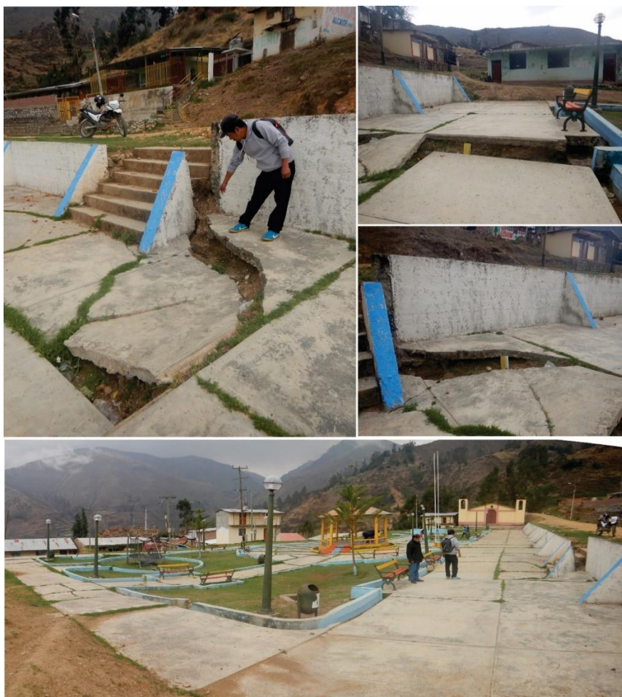
Figura 17. Vista de la plataforma del anexo Pichuta, se evidencio asentamiento en uno de los extremos de la plataforma de concreto, el cual es la continuidad de grietas que se desplaza desde las instituciones educativas.
