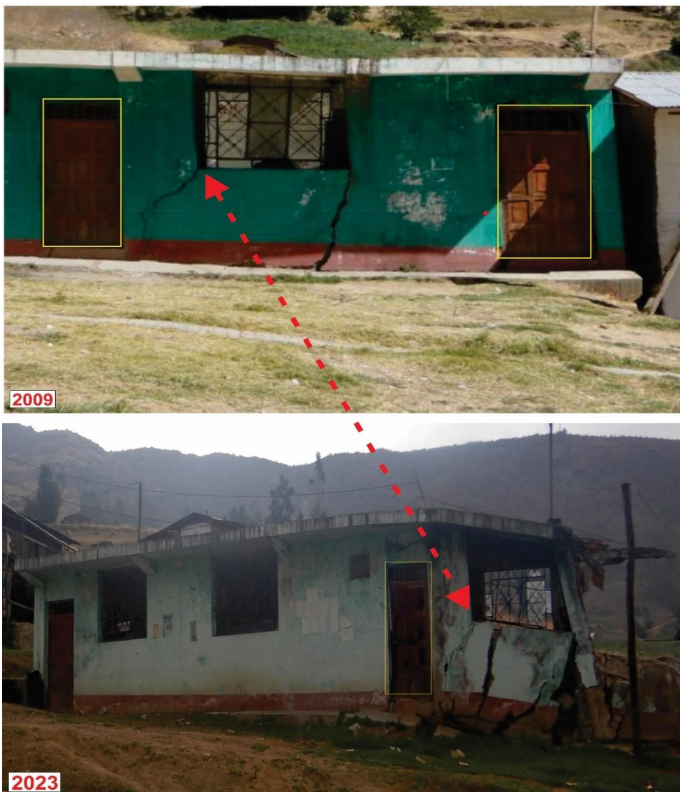
Figura 24. Vista de la imagen del 2009 donde se observa infraestructura afectada; presentaba grietas próximas a la ventana (Imagen extraída del informe técnico, Gómez, 2009, elaborado Ingemmet), imagen del 2023 infraestructura destruida, se evidencio grietas en las paredes y piso, actualmente la infraestructura es utilizada como depósito, el cual expone a las personas que ingresan a esa construcción.
