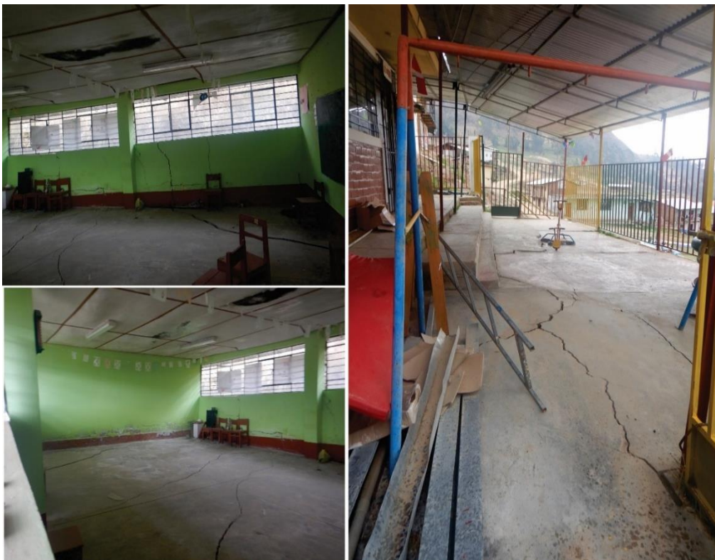
Figura 19. Vista de la Institución Educativo Inicial N°366 Pichuta, presenta afectación principal en su patio de juegos, presentan agrietamientos de 0.08 m de ancho con profundidades visibles de 0.05 m y longitudes de 4 m.
