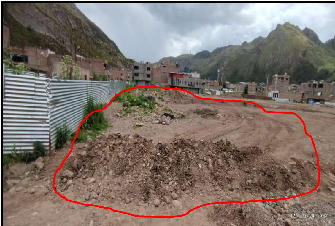
Fotografía N° 4: se evidencia acumulación de agua debido a que se encuentra montículos de materiales excedentes.
