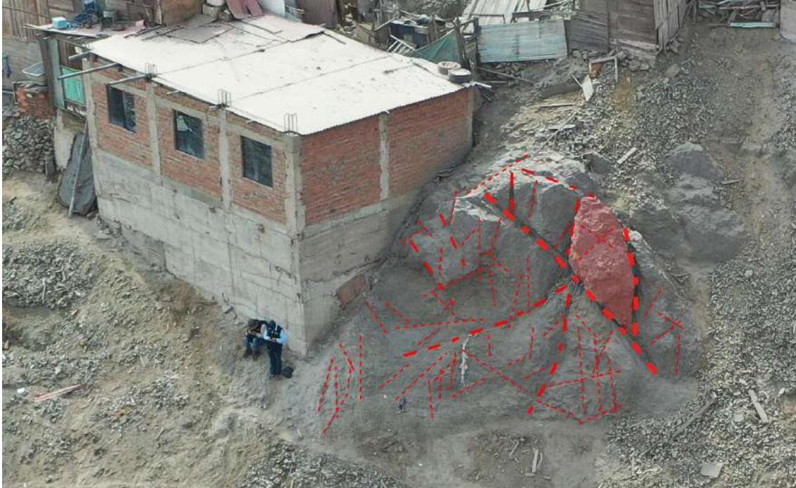
Figura 7. Vista del principal sector crítico susceptible a desprenderse (polígono color rojo), el cual está formado por un macizo rocoso, fuertemente fracturado (líneas entrecortadas rojas), lo que dada la naturaleza de su composición lo hace inestable. Coordenadas referenciales UTM WGS-84, 18S: E: 269354; N: 8688681.
