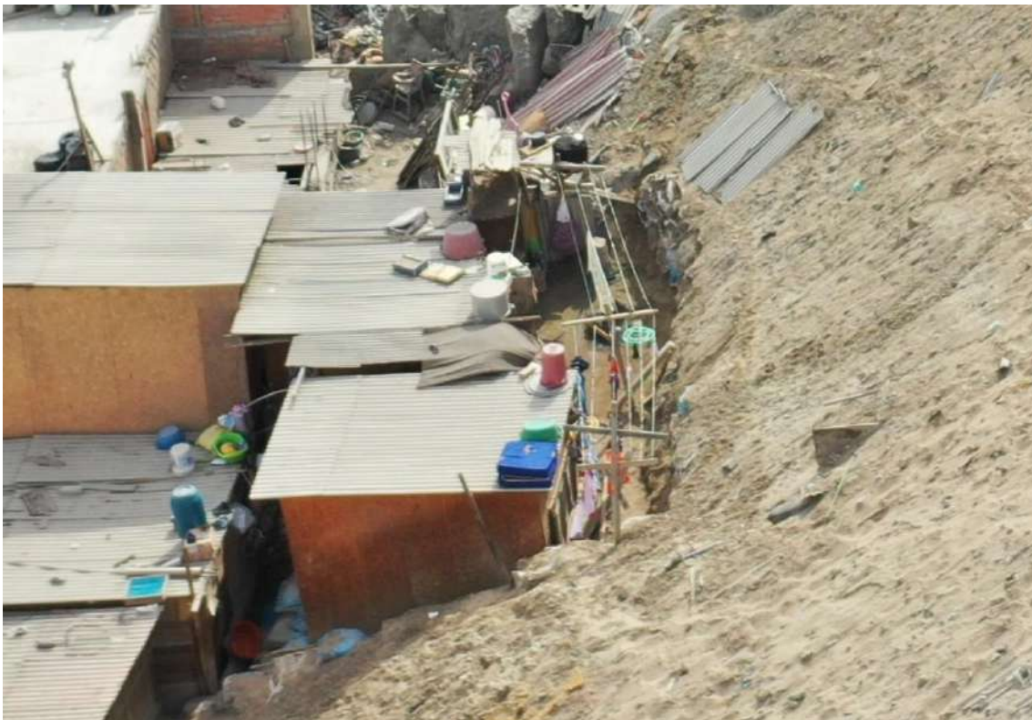
Fotografía 6. Cortes de talud realizados en depósitos eólicos para la construcción de viviendas. Esta acción contribuye a la inestabilidad de la ladera. Coordenadas referenciales UTM WGS-84, 18S: E: 269361; N: 8688663.
