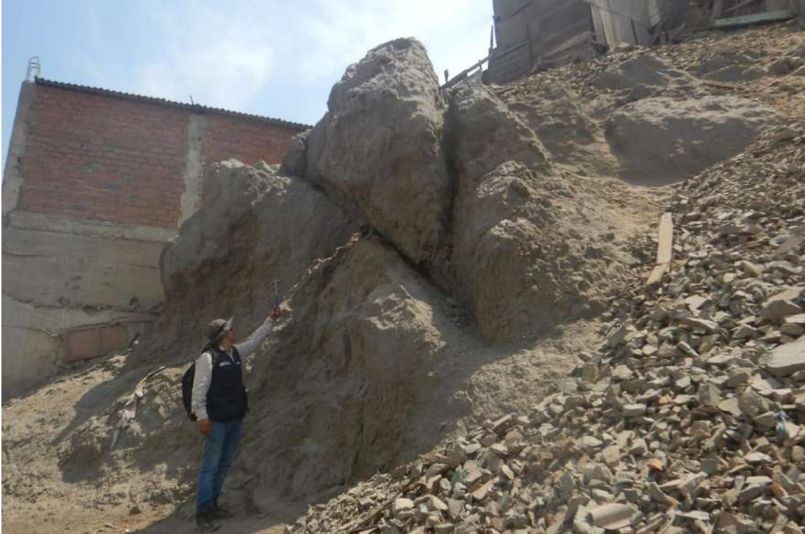
Fotografía 5. Vista de rotura en cuña formado por la intersección de dos planos de debilidad que se cruzan, lo que generan un bloque susceptible a desprenderse. Coordenadas referenciales UTM WGS-84, 18S: E: 269357; N: 8688676.
