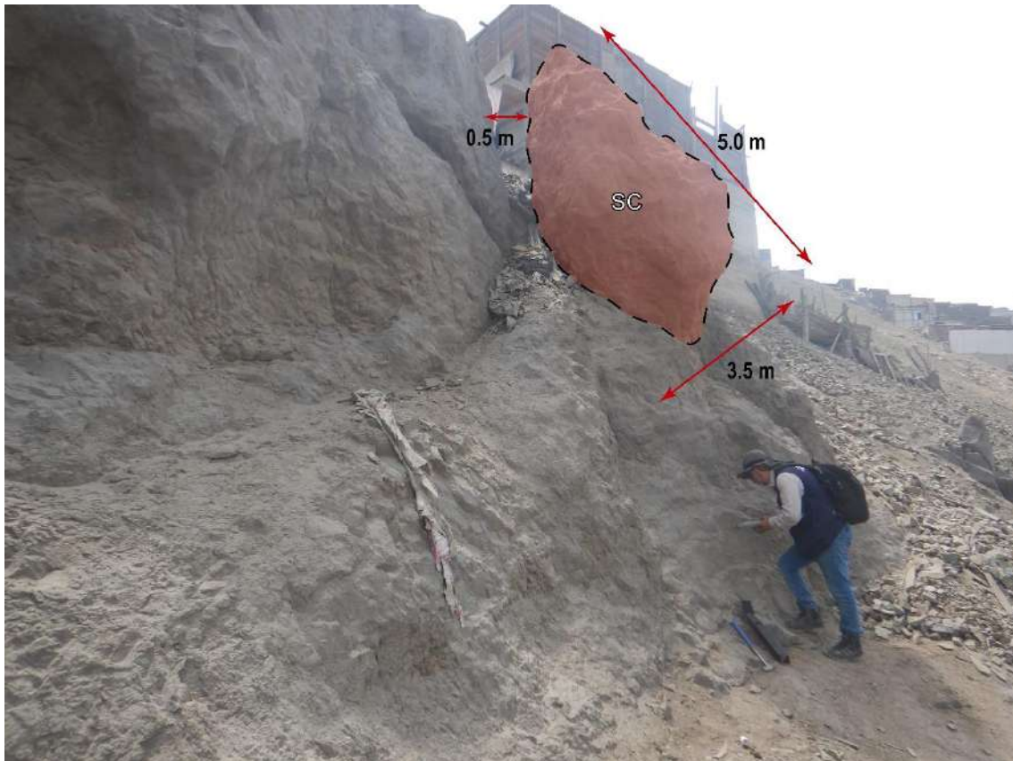
Figura 8. Vista de perfil del sector crítico (SC), formado por un macizo rocoso fuertemente fracturando, con dos sistemas de fracturas muy abiertas, que dejan un bloque aislado (polígono color rojo), con una separación entre 0.30 a 0.50 m.
