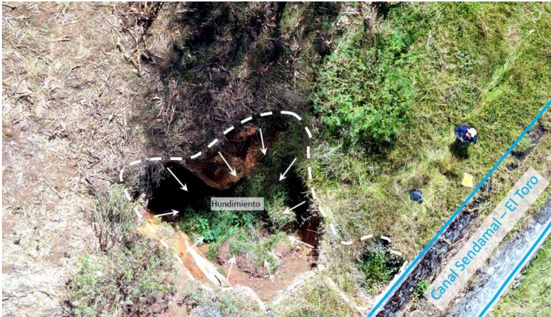
Figura 11. Se observa el hundimiento colinda con el canal Sendamal – El Toro. Coordenadas UTM, WGS-84, 17S. Norte: 9239952 y Este: 809828.
