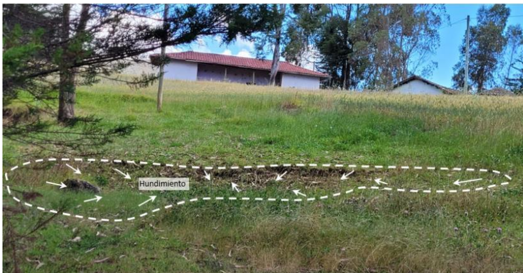
Figura 14. Se observa el inicio del proceso de hundimiento. Coordenadas UTM, WGS-84, 17S. Norte: 9240003 y Este: 809718.
