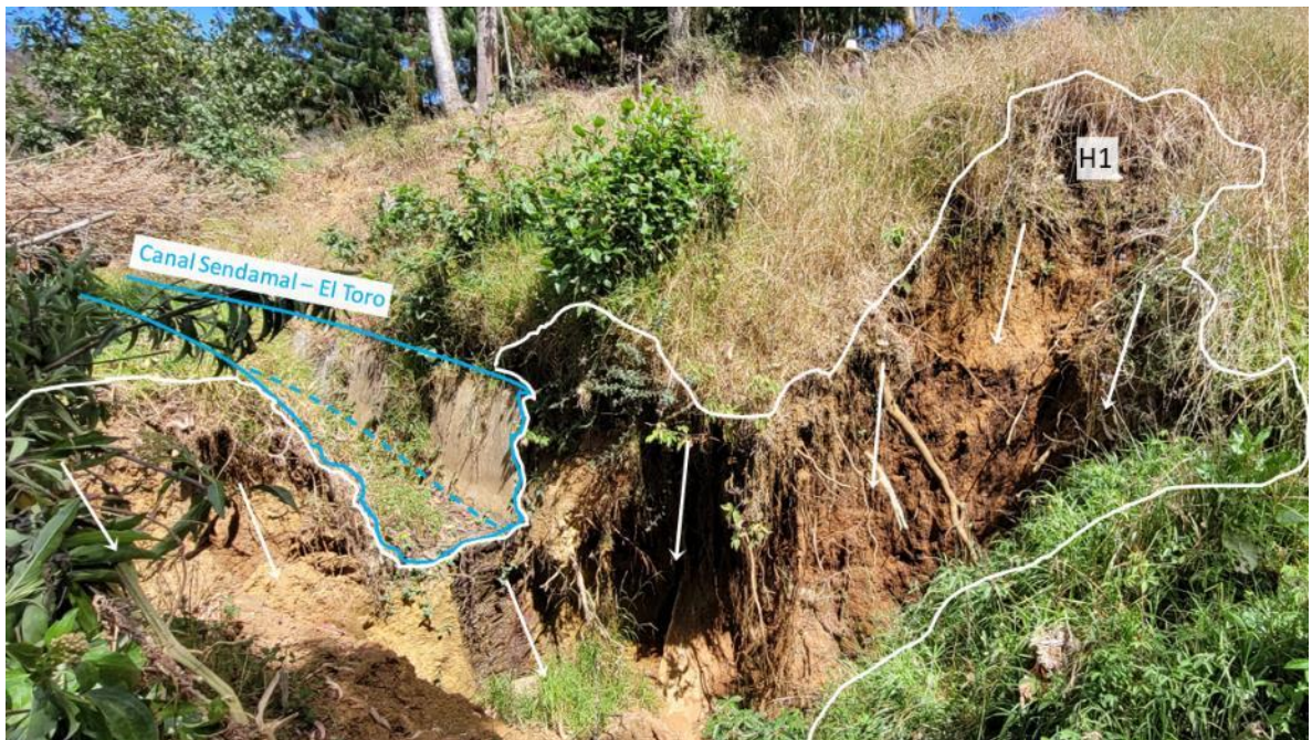
Figura 17. Hundimiento 1 en un tramo de 7m del Canal Sendamal – El Toro
