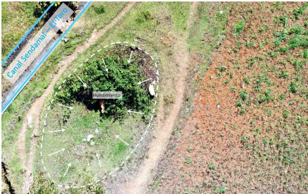
Figura 13. Se observa el hundimiento colinda con el canal Sendamal – El Toro. Coordenadas UTM, WGS-84, 17S. Norte: 9239951 y Este: 809841.
