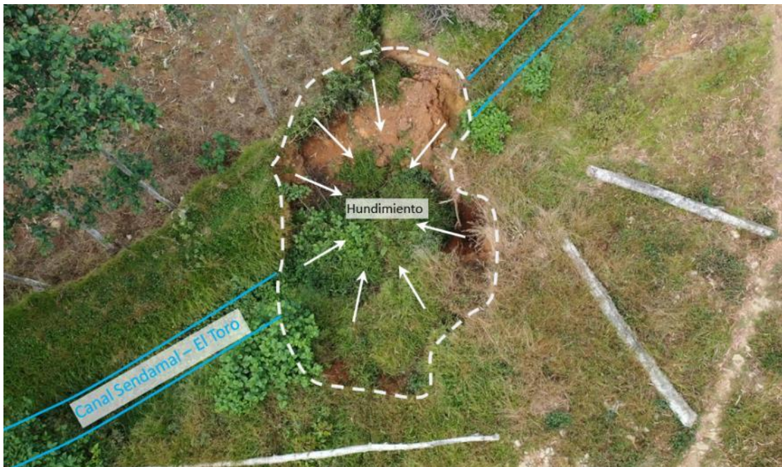
Figura 10. Se observa el canal Sendamal – El Toro afectado por el hundimiento. Coordenadas UTM, WGS-84, 17S. Norte: 9240125 y Este: 809552.
