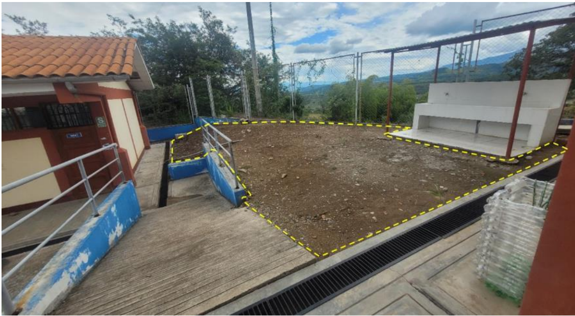
Figura 10. Terreno sin ninguna cobertura que impida la infiltración del agua proveniente de las precipitaciones pluviales.
