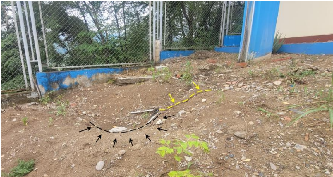
Figura 11. Erosión de terreno, genera agrietamientos y depresión del terreno incrementando la saturación por infiltración de agua.
