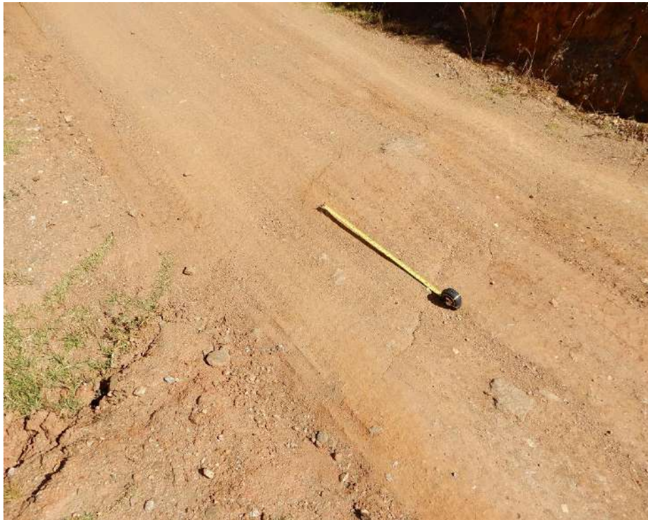
Fotografía 11. Presencia de grietas en carretera afirmada UTM: 303700 / 8961375, Zona 18.
