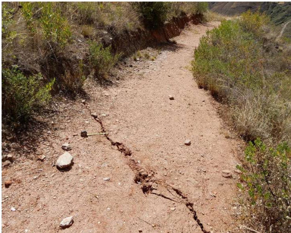
Fotografía 9. Presencia de grietas en camino de herradura a 150 m del derrumbe; lado izquierdo. UTM: 303917 / 8961148, Zona 18.
