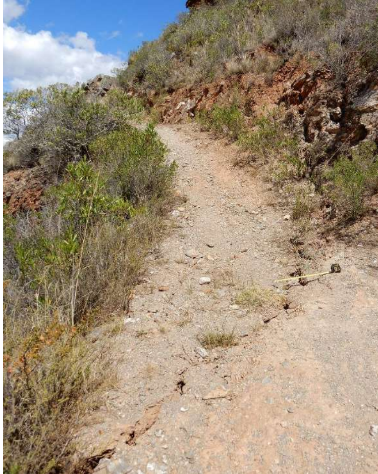
Fotografía 10. Presencia de grietas en camino de herradura a 150 m del derrumbe; lado derecho. UTM: 303952 / 8961215, Zona 18.
