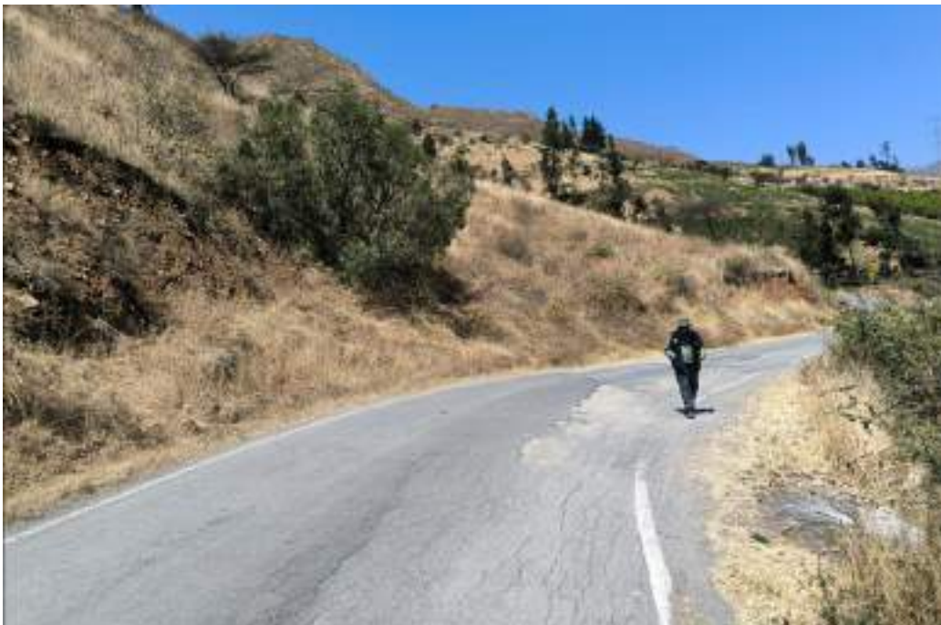
Fotografía 22. Muestra dalos en la carretera agrietamientos con aperturas en dirección al movimiento, rellenos con brea.
