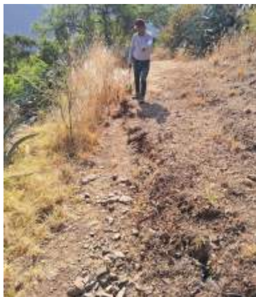
Fotografía 25. Evidencias de la dinámica del deslizamiento Dr-a5 (escapamientos menores a 1m).
