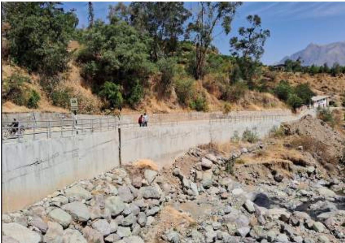
Fotografía 8. Muestra el muro de contención posterior al puente, con evidencias de presión sobre este por el deslizamiento activo (Dr-a1).
