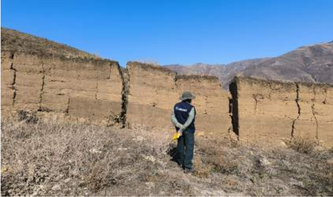
Fotografía 27. Aperturas en muros del cementerio en dirección del movimiento del deslizamiento Dr-a6
