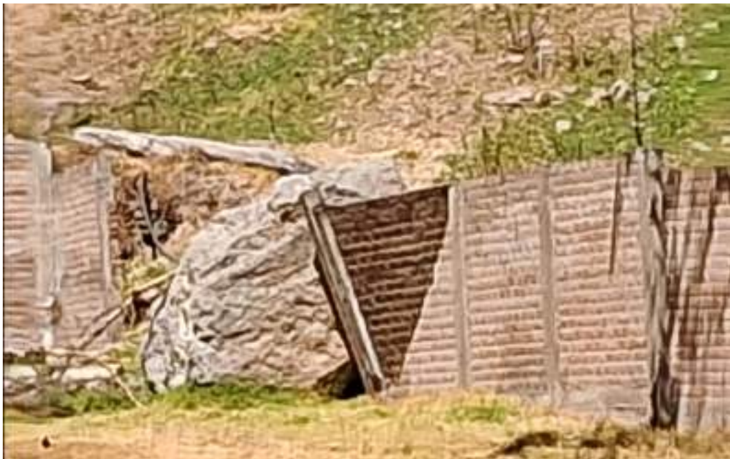
Fotografía 16. Bloques de roca en el cuerpo de la masa deslizada, caídos debido a cortes en el talud y la subsecuente destrucción de un muro.
