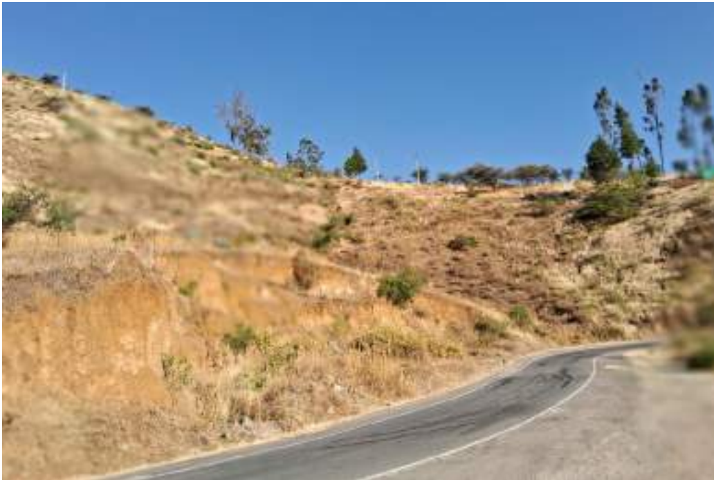
Fotografía 21. Escarpes secundarios en el cuerpo del deslizamiento Dr-a4.
