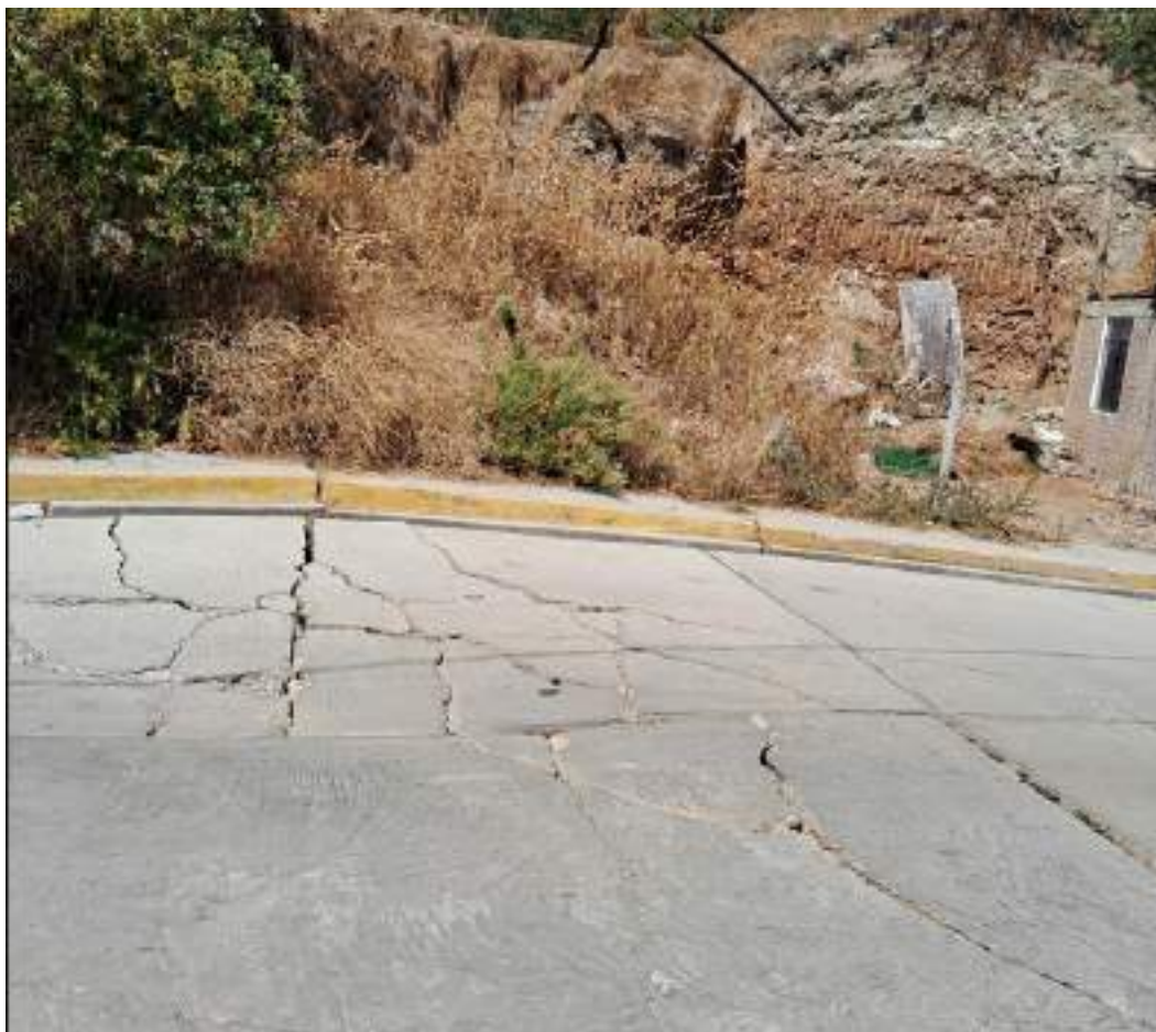
Fotografía 17. Grietas en el asfalto de la carretera afectada por el deslizamiento Dr-a2.
