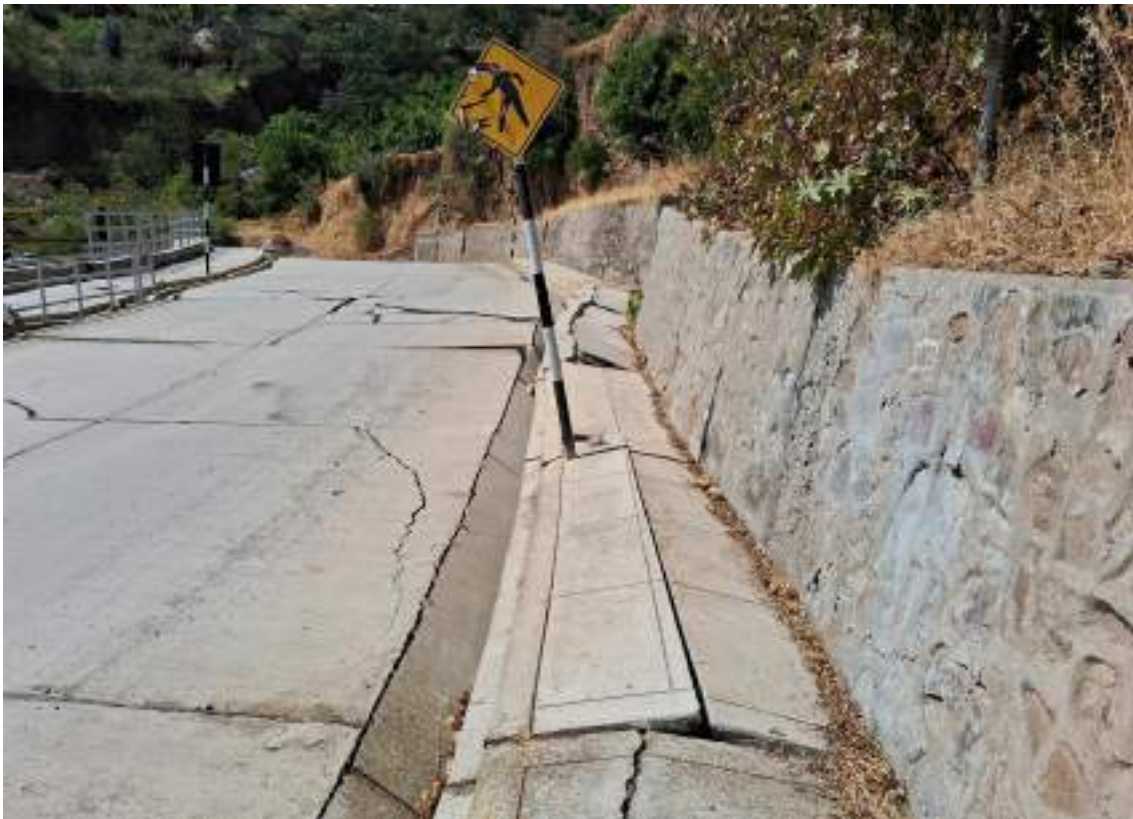
Fotografía 10. Muestra como el pavimento se levantó durante deslizamiento debido a la presión ascendente del suelo desplazado, la acumulación de material en la base del deslizamiento, deformaciones diferenciales del terreno y el aumento de la presión del agua subterránea. Estas
