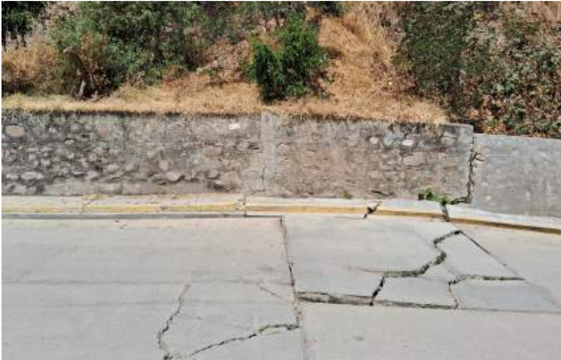
Fotografía 9. Agrietamientos en las coordenadas UTM, WGS 84, 18s, X45335 e Y:8520322.
