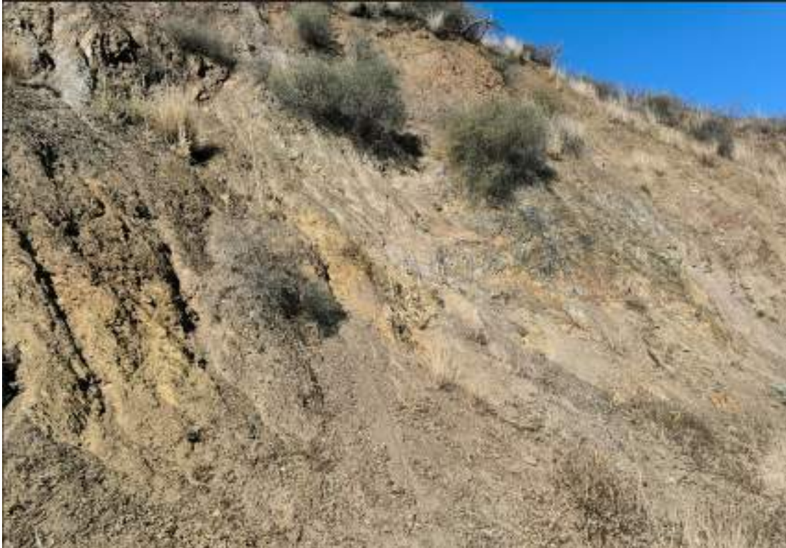
Fotografía 23. Erosión en la parte superior del deslizamiento, muestra surcos en el cuerpo de deslizado.
