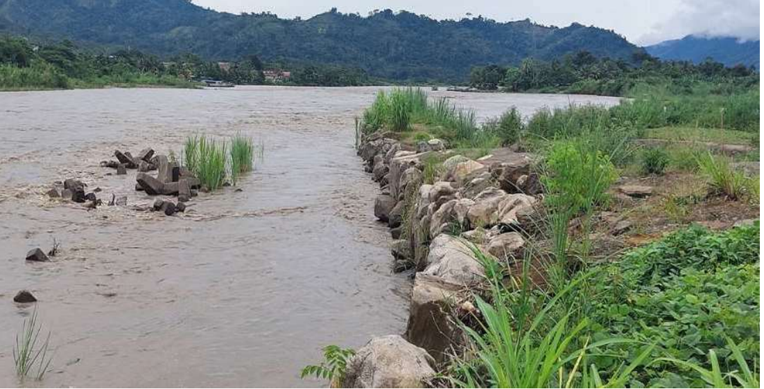
FIGURA N°03: VISTA FOTOGRAFICA DE LA MARGEN DERECHA DEL RIO APURIMAC EN EL TRAMO DE INTERES EN LA QUE SE OBSERVA LAS AFECTACIONES EN LOS TALUDES. LAS MISMAS QUE EN MAXIMAS AVENIDAS SE INUNDAN.
