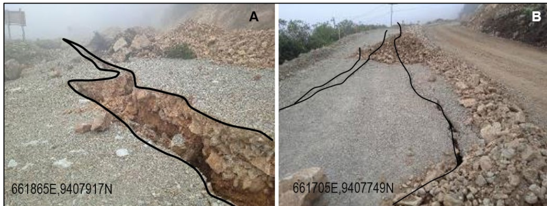
Figura 32. (A) Grieta en la parte superior central de la corona. (B) Grieta en el flanco sur de la corona.
