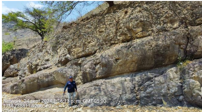
Fotografía 1. Macizo rocoso medianamente fracturado y moderadamente meteorizado de la Etapa Volcánica Chilete.
