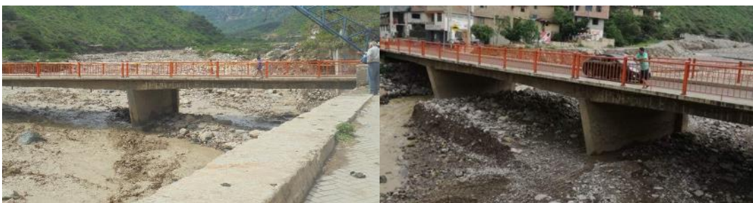
Fotografía 4. Colmatación de la quebrada Huertas en marzo del 2017 (izquierda) y 2019 (derecha). Fuente: Municipalidad Distrital de Chilete.
