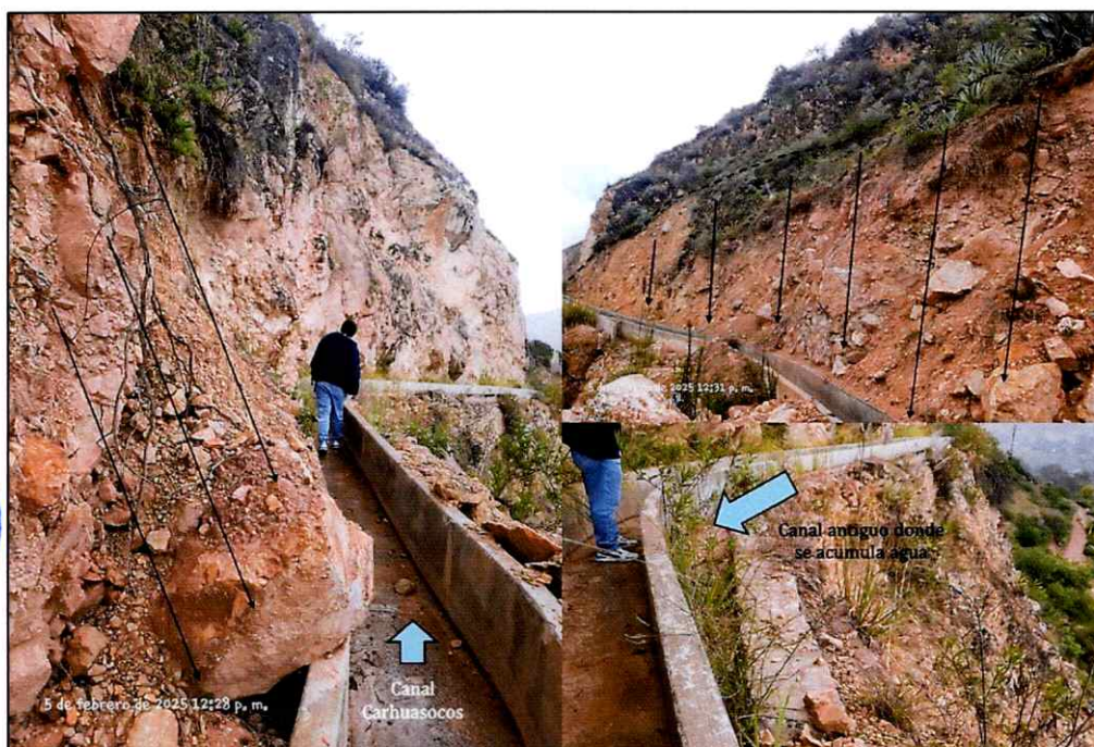
Ilustración 33. Caída de rocas que colmatan el canal Carhuasocos y acumulación de agua sobre base de canal antiguo.
