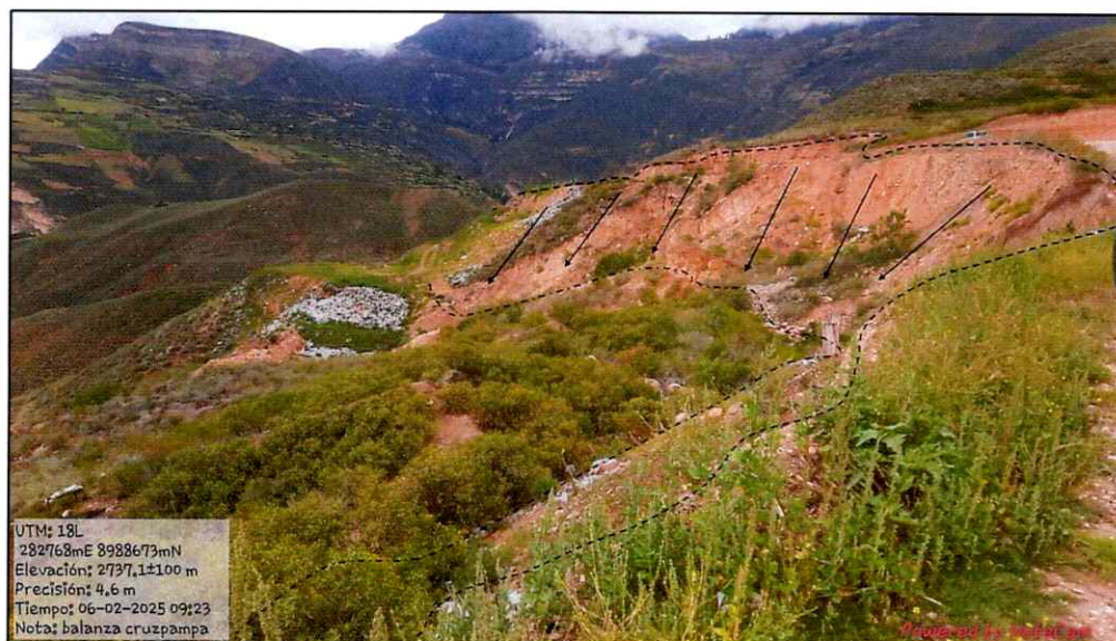
Ilustración 11. Grietas y asentamiento del talud de la carretera Aczo – Chingas (cruce Vilcabamba).
