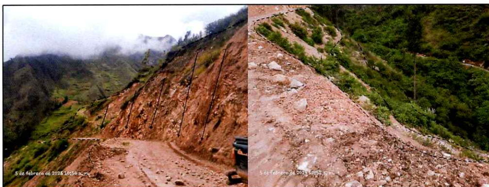
Ilustración 19. Zona de deslizamiento sobre el talud de la carretera y deslizamiento sobre la plataforma.
