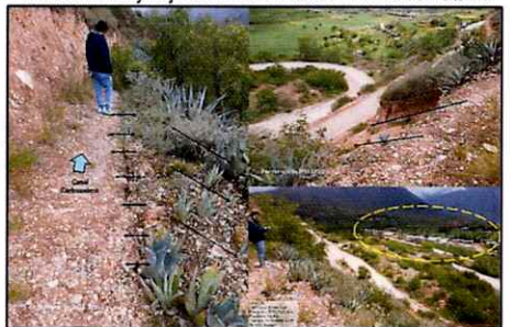
Formación de grietas e inicio de deslizamiento del talud sobre el que se asienta el canal.
