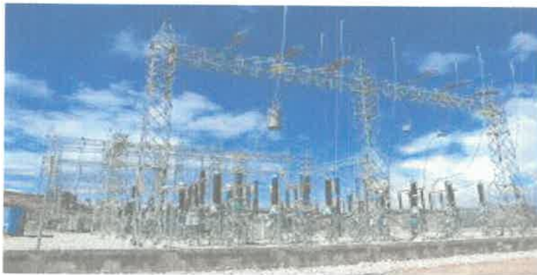
Gráfico 6 Subestación Eléctrica Montalvo
