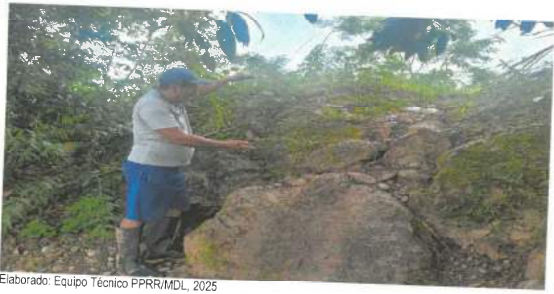
Foto N°10. Inspección del muro de contención ante el desborde del río Tulumayo, erosión y pérdida de plataforma.
