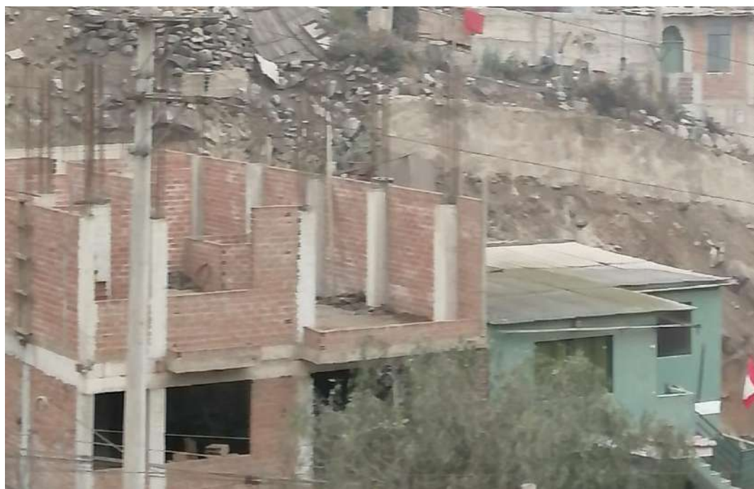
Se observa vivienda en construcción de segundo nivel con paredes de ladrillo en el AAHH ANDRES AVELINO CACERES-PARCELA.
