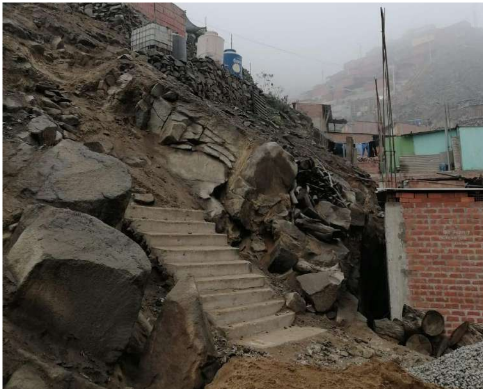
Escalera incompleta y sin barandas en el AAHH ANDRES AVELINO CACERES-PARCELA 5.
