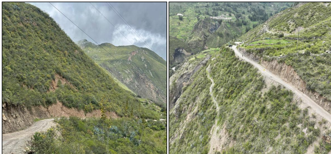
Figura 56. Deslizamiento y elementos expuestos – Ahusana
