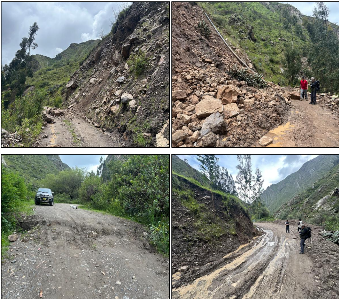
Figura 80. Tramos afectados de la zona crítica – Zinga - Acceso Llamac
