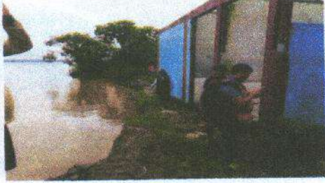
Vista de la zona erosionada cercana al centro educativo de la localidad
