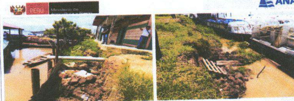
Sector con problemas de erosión y con presencia de pilotes de acero a modo de defensa ribereña, construido por pobladores.
