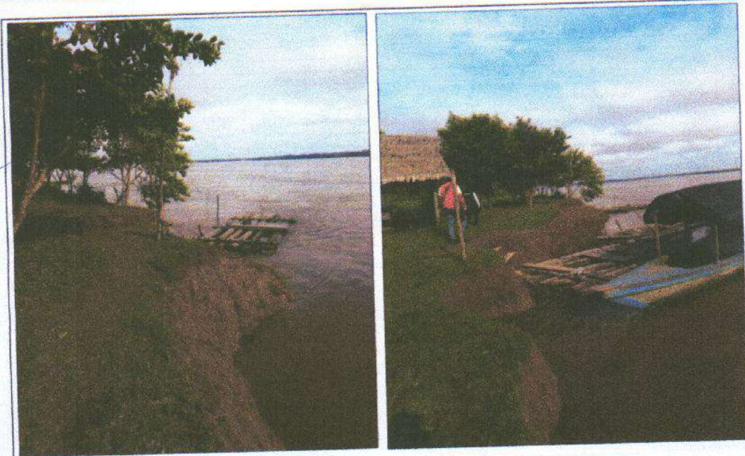
Sector de la comunidad de Solterito, con presencia de erosión en la ribera del río Marañón - margen izquierdo y acompañamiento
