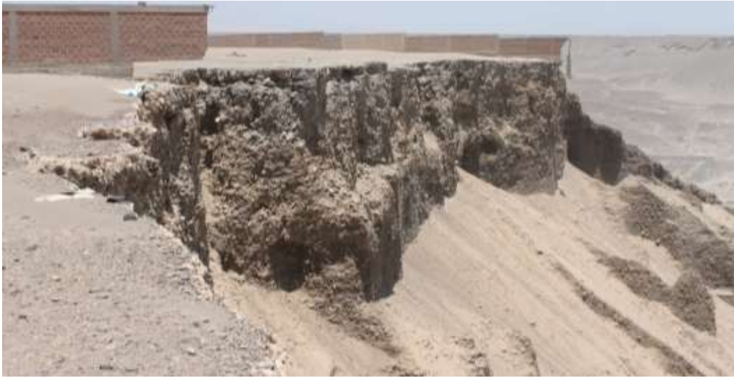
Foto 4: Vista superior del flanco derecho de la escarpa del deslizamiento.
