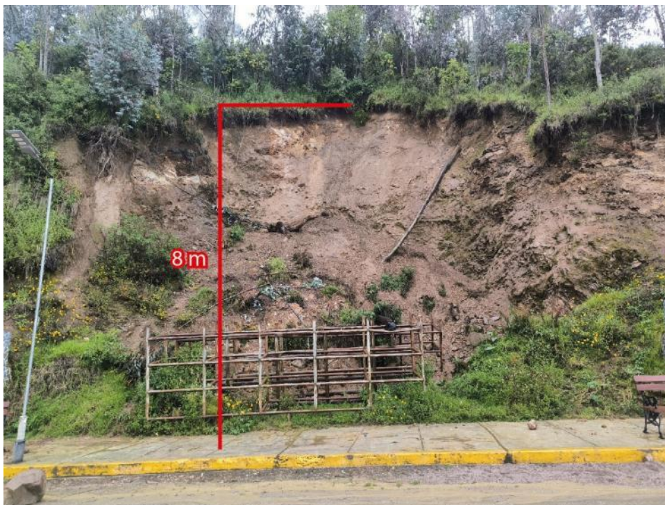
Figura 16: Derrumbe Da-5, en el sector de acceso a Comas.
