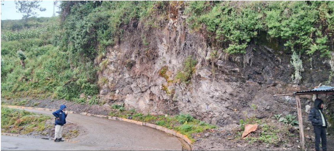
Fotografía 2: Andesitas altamente meteorizadas en las coordenadas UTM, WGS 84, 18s, X: 490547.20 m E; Y: 8704236.97 m S
