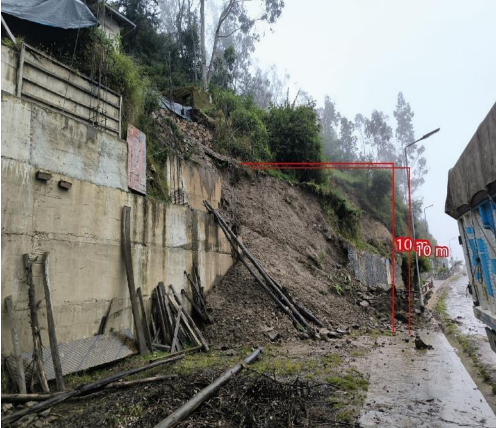
Figura 14: Derrumbe Da-3, en el sector de acceso a Comas.
