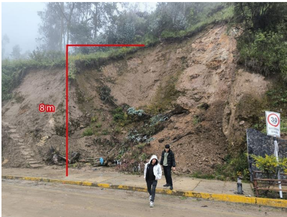
Figura 15: Derrumbe Da-4, en el sector de acceso a Comas.
