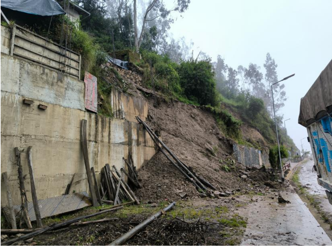
Fotografía 5: Depósitos coluviales en la entrada del centro poblado Comas. UTM, WGS 84, 18s, X: 490587.96 m E; Y: 8704189.21 m S.
