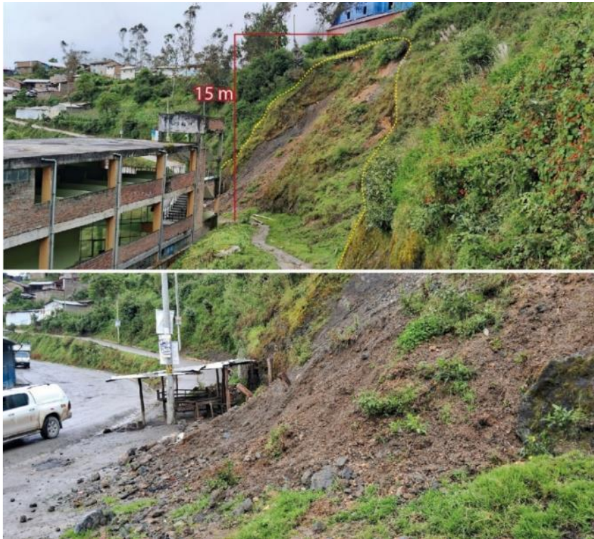
Figura 11: Derrumbe (Da-2), en la parte baja de la ladera considerada como zona crítica en el sector de Comas alta.
