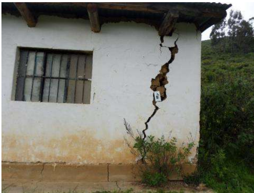
Fotografía 8. Vista de vivienda de adobe que presenta grietas en sus paredes y piso, lo cual demuestra el desplazamiento del terreno.
