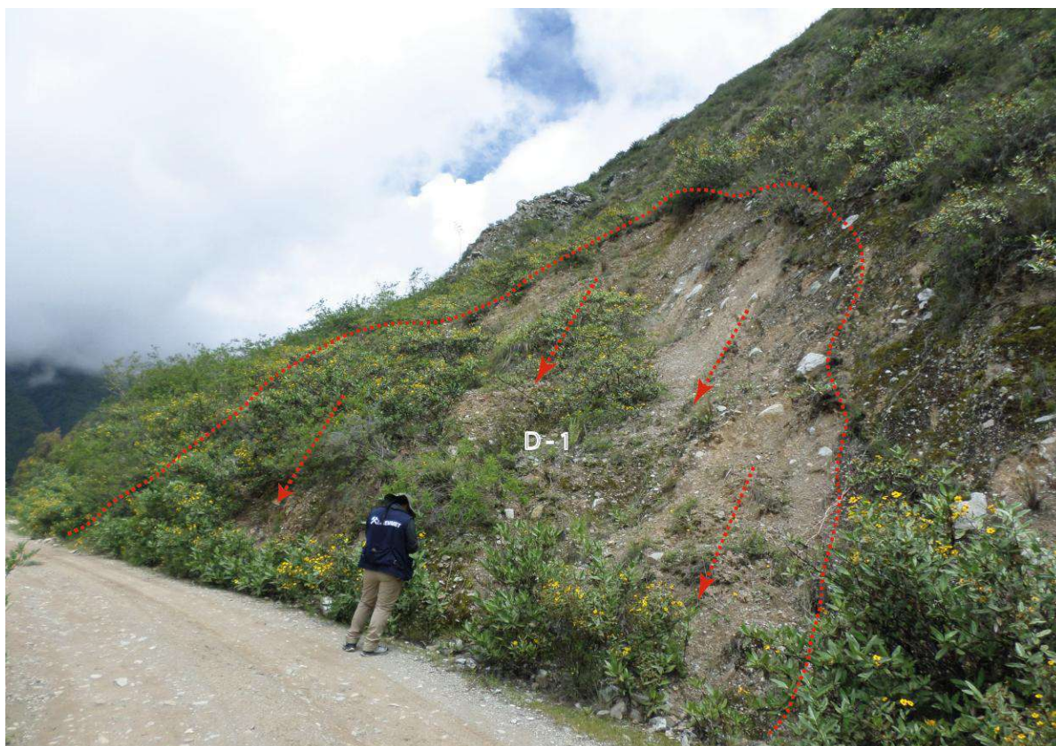
Figura 10. Derrumbe D-1, se observa la reactivación con longitud de arranque de 18.5 m y altura de arranque 10.5 m, donde se puede distinguir material coluvial que fue depositado al pie del talud, susceptibles a ser removidos con facilidad durante lluvias excepcionales.
