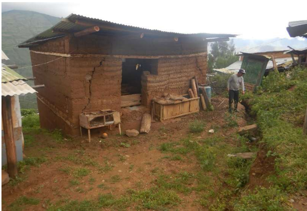
Fotografía 7. Vista de vivienda de adobe que presenta grietas en sus paredes con abertura de 7 cm y longitud de hasta 3.2 m, se muestra también un canal de riego no impermeabilizado.
