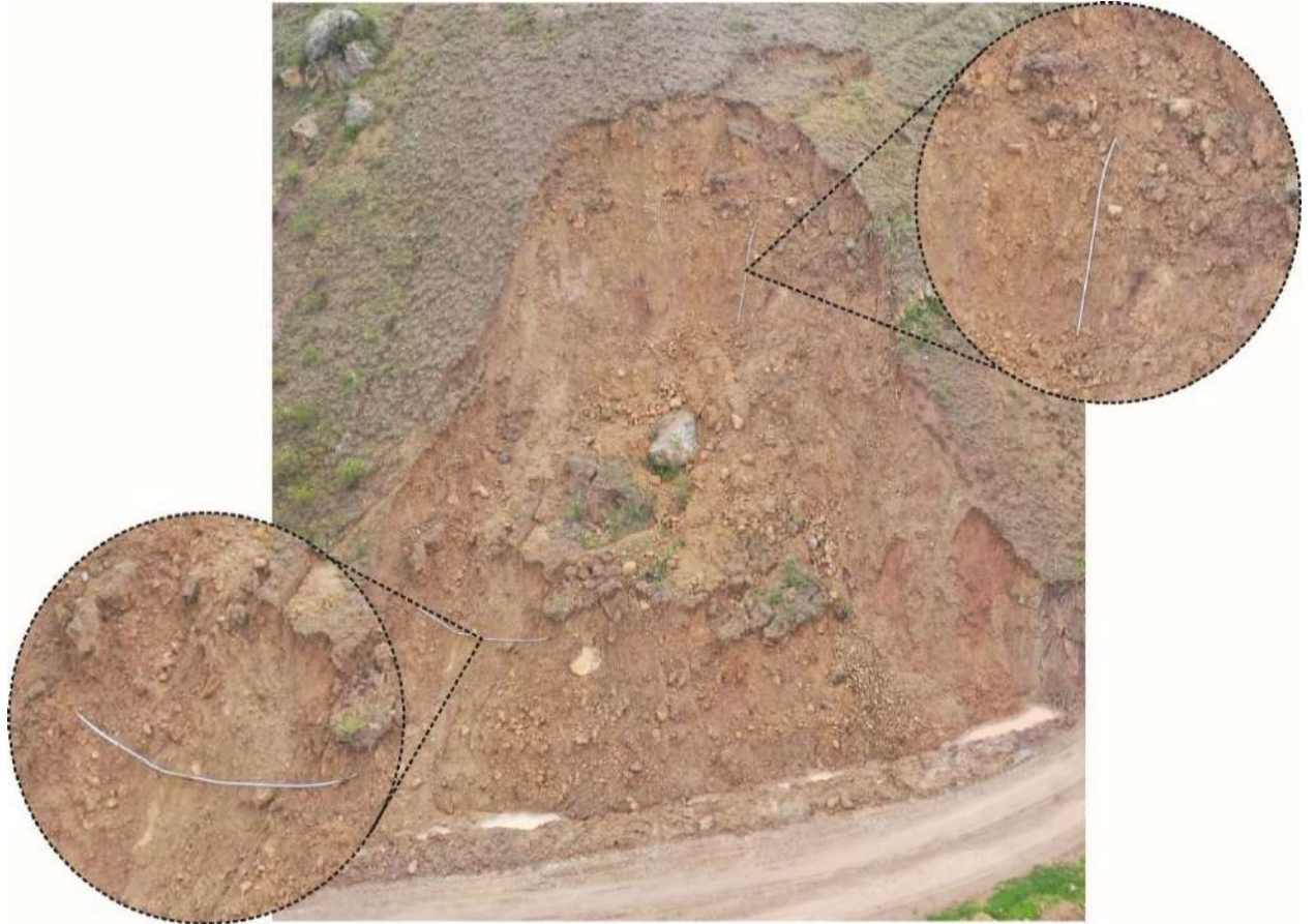
Figura 15. Se observa tubería afectada por el deslizamiento, reactivado en febrero del 2025.
