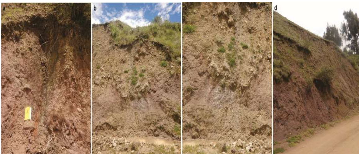
Figura 18. Vista de los ojos de agua, identificados dentro del cuerpo de derrumbe; el cual discurre por la cuneta ubicada a un lado de la trocha carrozable.
