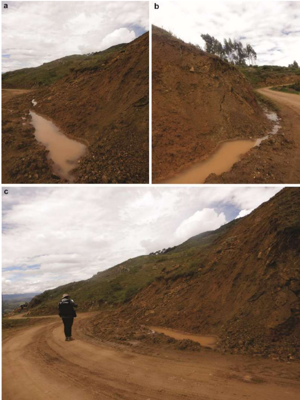
Figura 14. Vista del cuerpo del deslizamiento por donde se identificó ojos de agua subterránea, lo cual está aportando en la saturación del cuerpo del deslizamiento.
