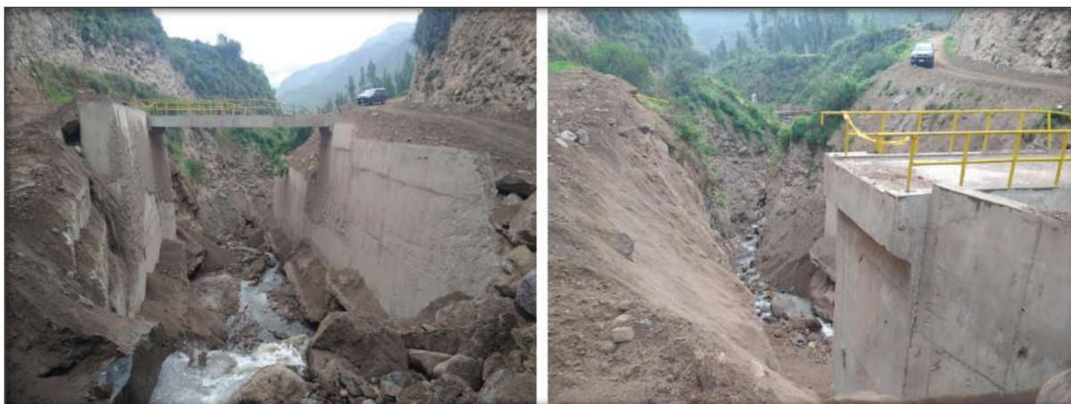
Figura 11. Afectación del puente carrozable en la vía afirmada Pararca-Pausa, que cruza la quebrada Tacrama.
