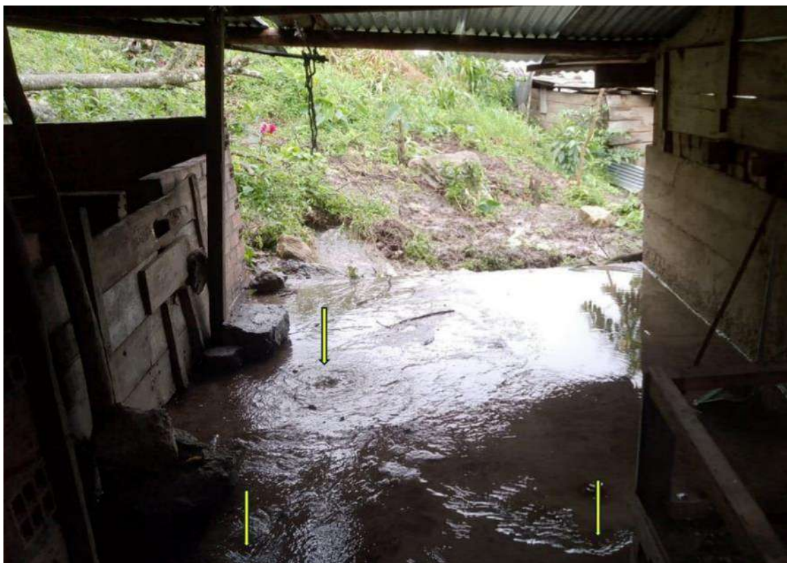
Figura 26. Surgencia de agua a través de cavidades en el piso de vivienda. Fotografía proporcionada por pobladores, mayo, 2024.
