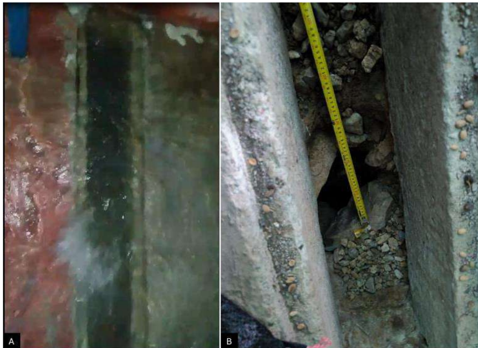
Figura 30. Vista del afloramiento de agua del piso vivienda. A. imagen tomada en mayo 2024. B. Fotografía noviembre 2024. Coordenadas referenciales UTM WGS-84, 18S: E: 770032; N: 9345729.
