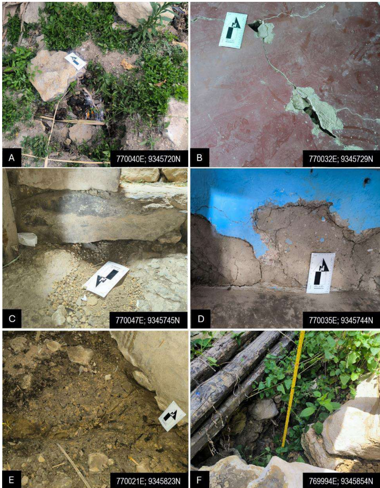
Figura 20. Vista de los desniveles de terreno en diferentes viviendas. A. Parcialmente relleno. B. Piso de vivienda con cavidades. C. Base de escalera de vivienda fue subsanada D. Pared de vivienda, subsanada. E. Base de muro de vivienda, se observa discurrimiento constante de agua. F. Socavamiento del terreno junto al muro de una vivienda.
