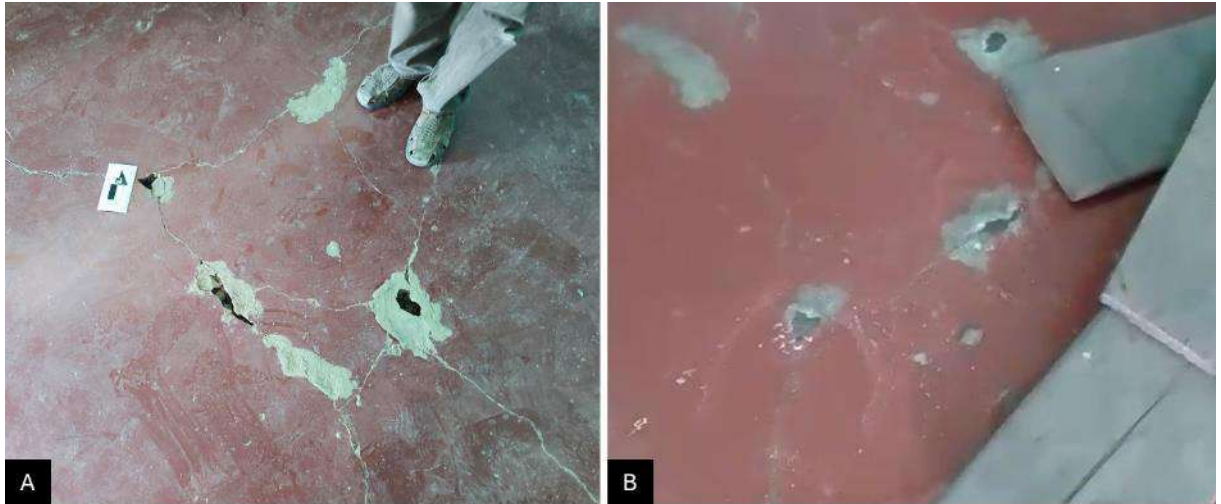
Figura 29. Vista de vivienda con tres cavidades por donde aflora agua en época de lluvias. A. imagen tomada en mayo 2024. B. Fotografía noviembre 2024. Coordenadas referenciales UTM WGS84, 17S: E: 770032; N: 9345729.
