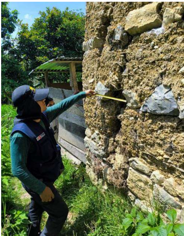
Figura 33. Vista de los vivienda afectada con grietas de 10-30cm. El suelo se encuentra húmedo por la filtración de agua.
