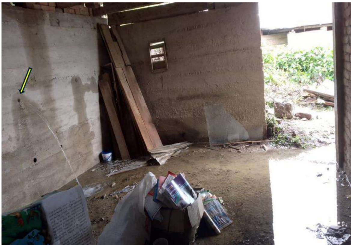
Figura 25. Filtraciones de agua a través de la pared de una vivienda. Fotografía proporcionada por pobladores, mayo, 2024.
