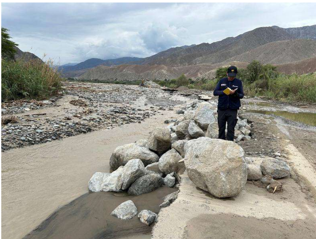
Fotografía 14. Aguas arriba del río Grande en la margen izquierda, estos procesos destruyeron hasta 500 m de la carretera departamental. Coordenadas UTM 479801 E; 8405466 N.
