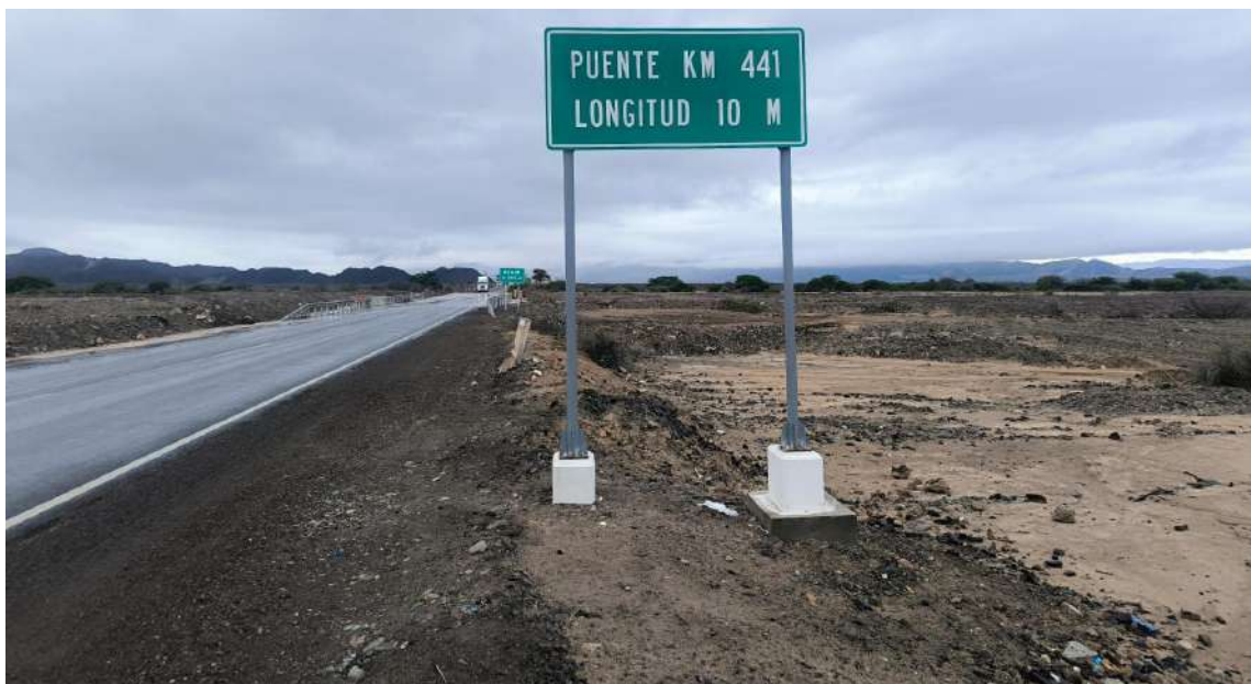
Fotografía 17. Puente carretera Panamericana Sur km 441, afectadas por inundación fluvial. Del río Socos. Coordenadas UTM 485038 E; 8376953 N.
