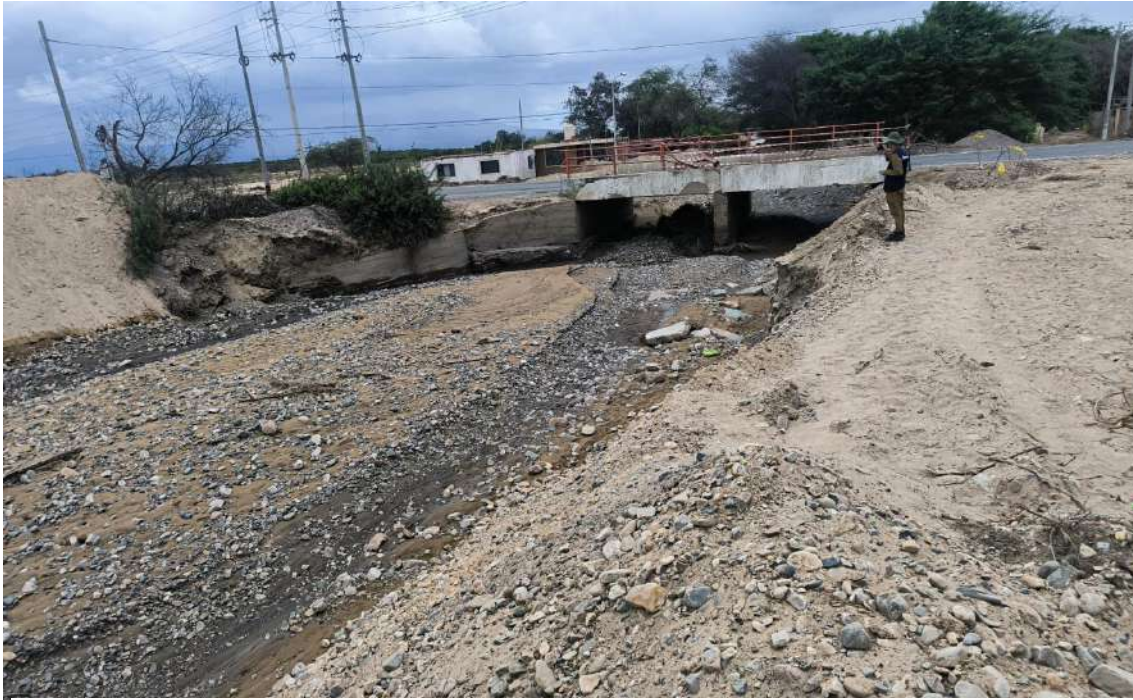
Fotografía 5. Puente de la carretera Panamericana, el desborde del río Taruga hacia su margen derecha ocasionó la afectación de 05 viviendas, Sector El Pajonal. Coordenadas UTM 501517E; 8350998 N
