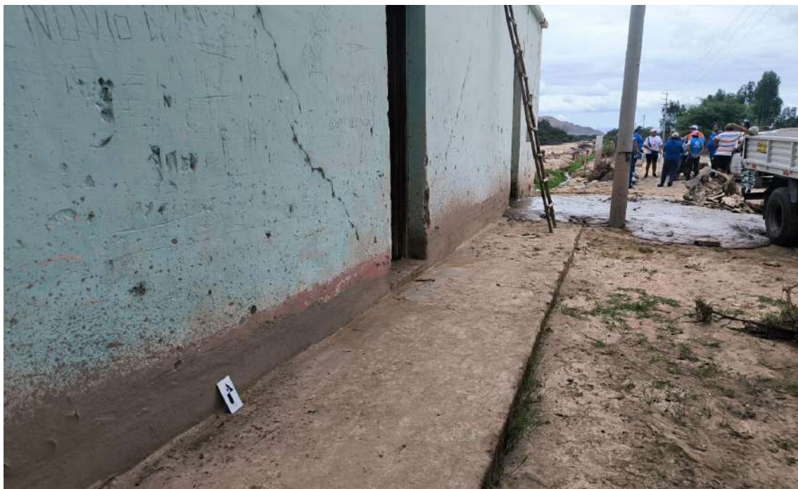
Fotografía 3. Sector La Ranchería, el desborde afectó 12 viviendas.
