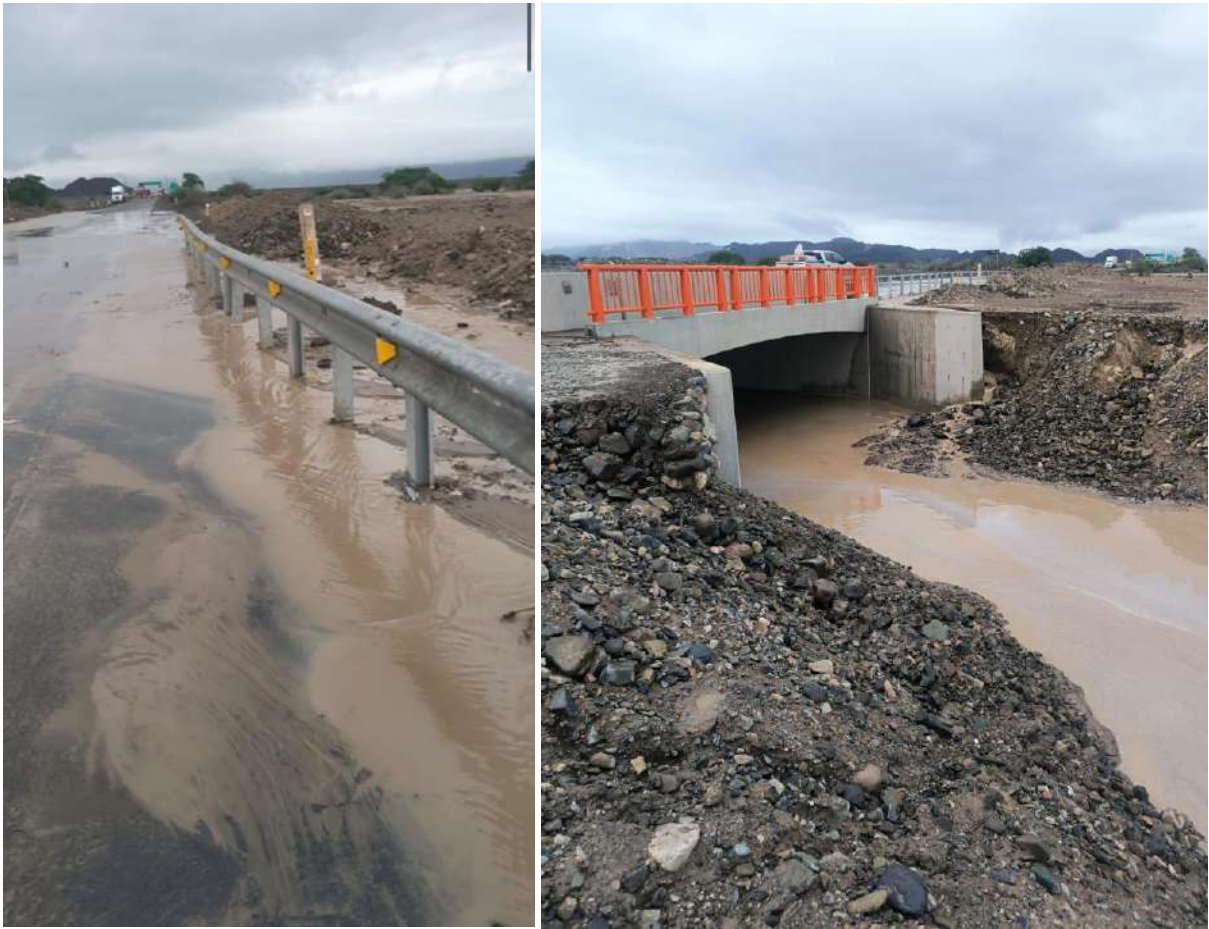
Figura 12. Puente carretera Panamericana Sur km 441, afectadas por desborde del río Socos Coordenadas UTM 485038 E; 8376953 N.
