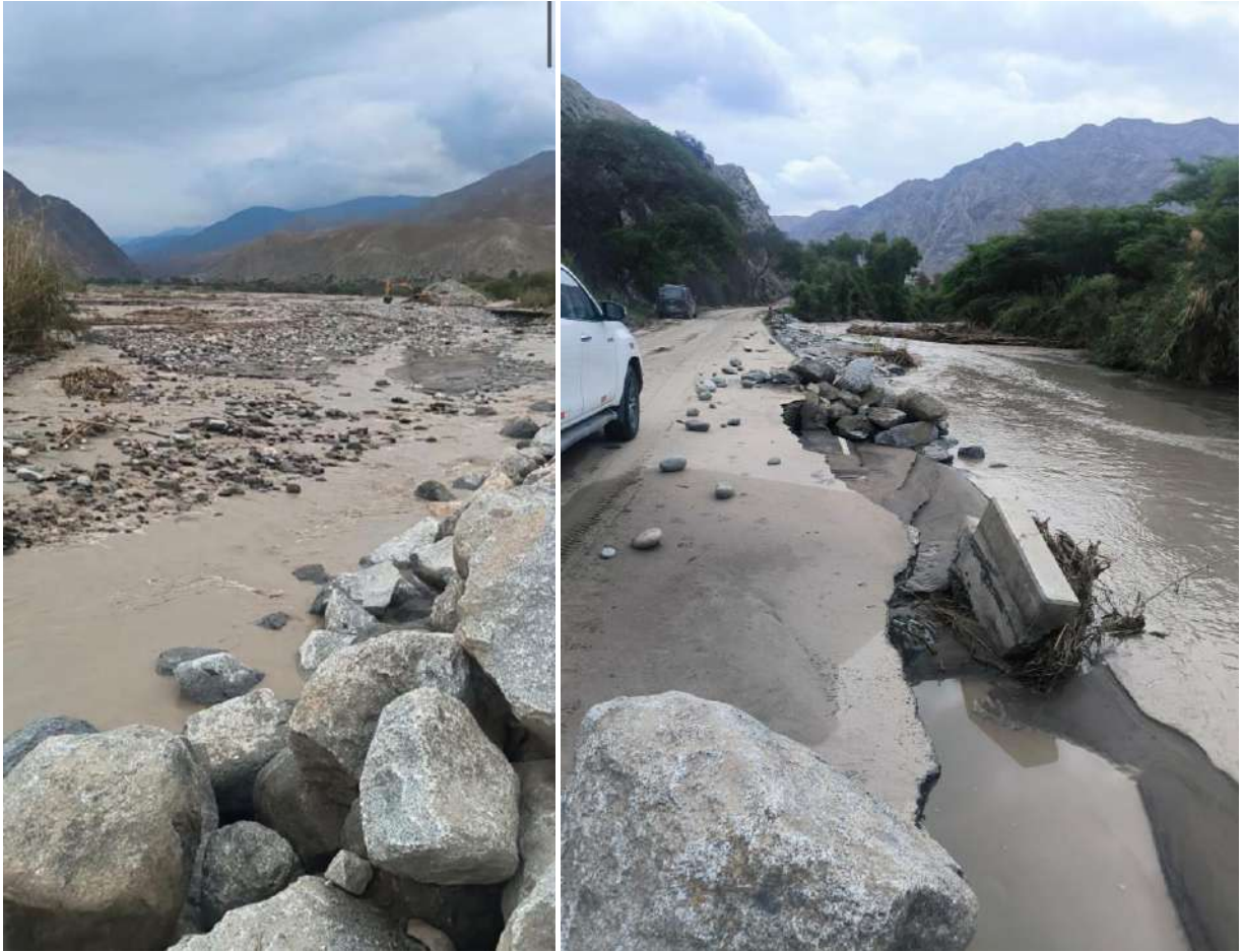
Figura 11. Erosión e inundación fluvial del río Grande en la margen izquierda, estos procesos destruyeron hasta 500 m de la carretera departamental. Sector Pinto. Coordenadas UTM 479801 E; 8405466 N.
