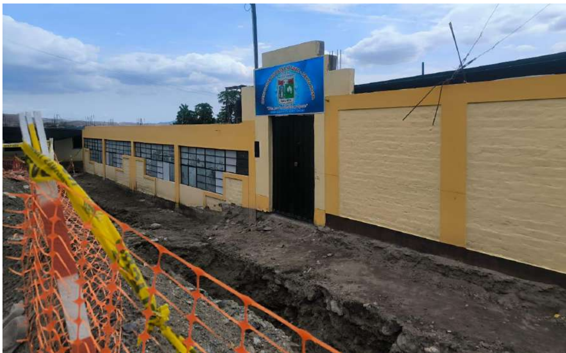
Fotografía 13. Institución Educativa N° 22680, afectado por flujo de detritos (huaico). Sector Santa Rosa. Coordenadas UTM 506044 E; 8362296 N.
