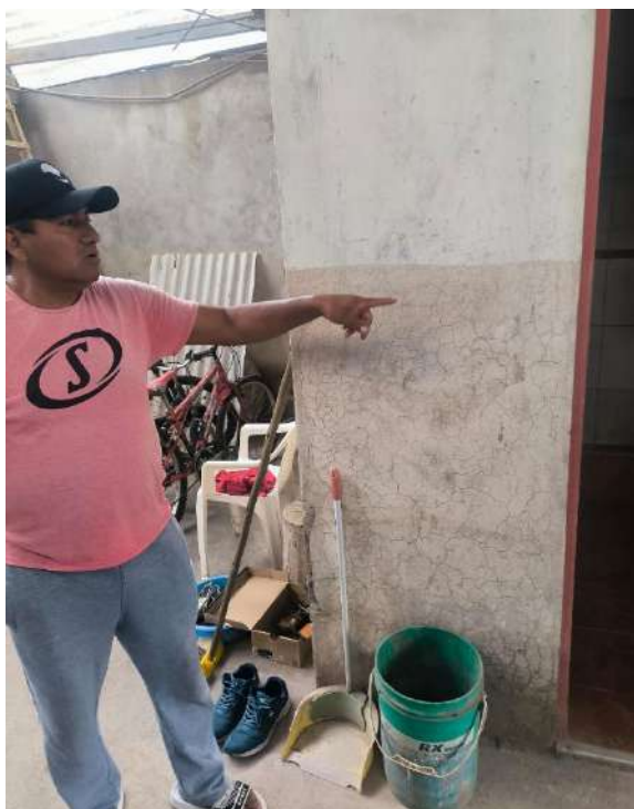
Fotografía 6. Huella de la altura que alcanzó el flujo en esta vivienda del sector La Primavera (Vista Alegre). Coordenadas UTM 504834E; 8358131 N
