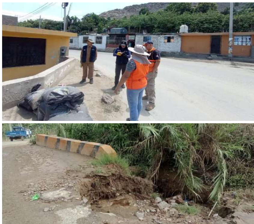
Figura 14. Viviendas afectadas por flujo de detritos (huaico) del año 2025 en el sector Pampa de Islas, distrito San José de Los Molinos. Coordenadas UTM 425071 E; 8456698 N.
