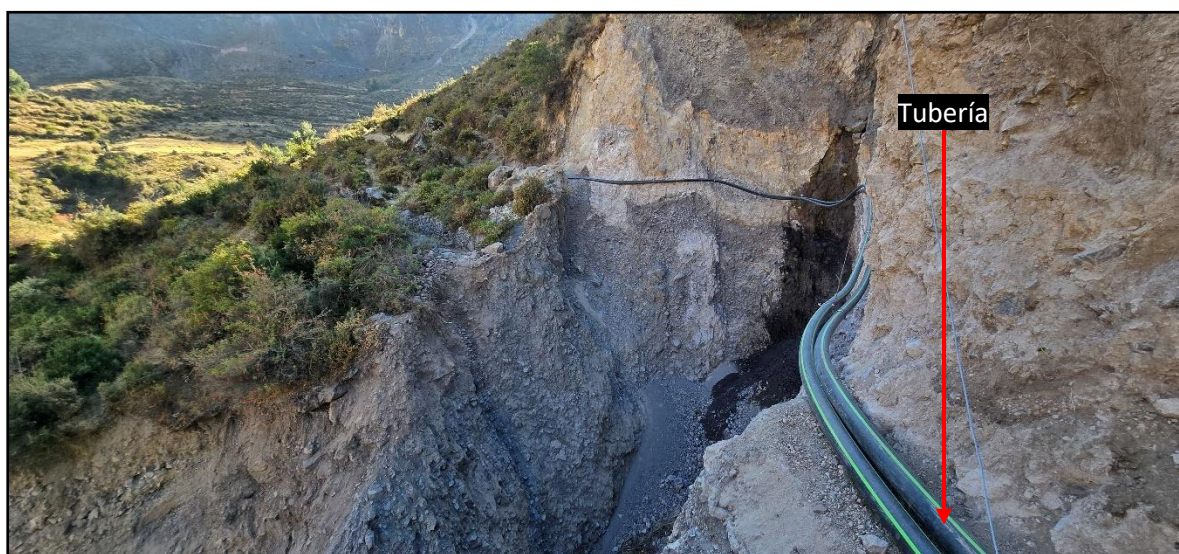
Figura 7. En el área fue afectado el principal camino de herradura y el canal de agua, el cual actualmente está entubada.
