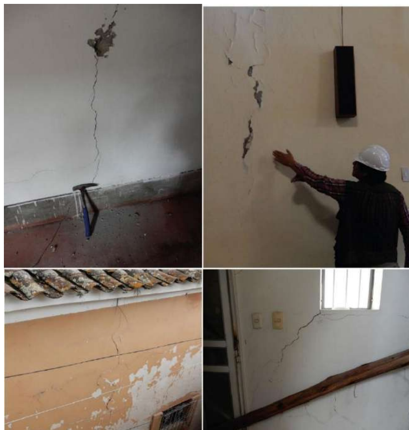
Figura 12. Agrietamientos en la iglesia del Calvario
