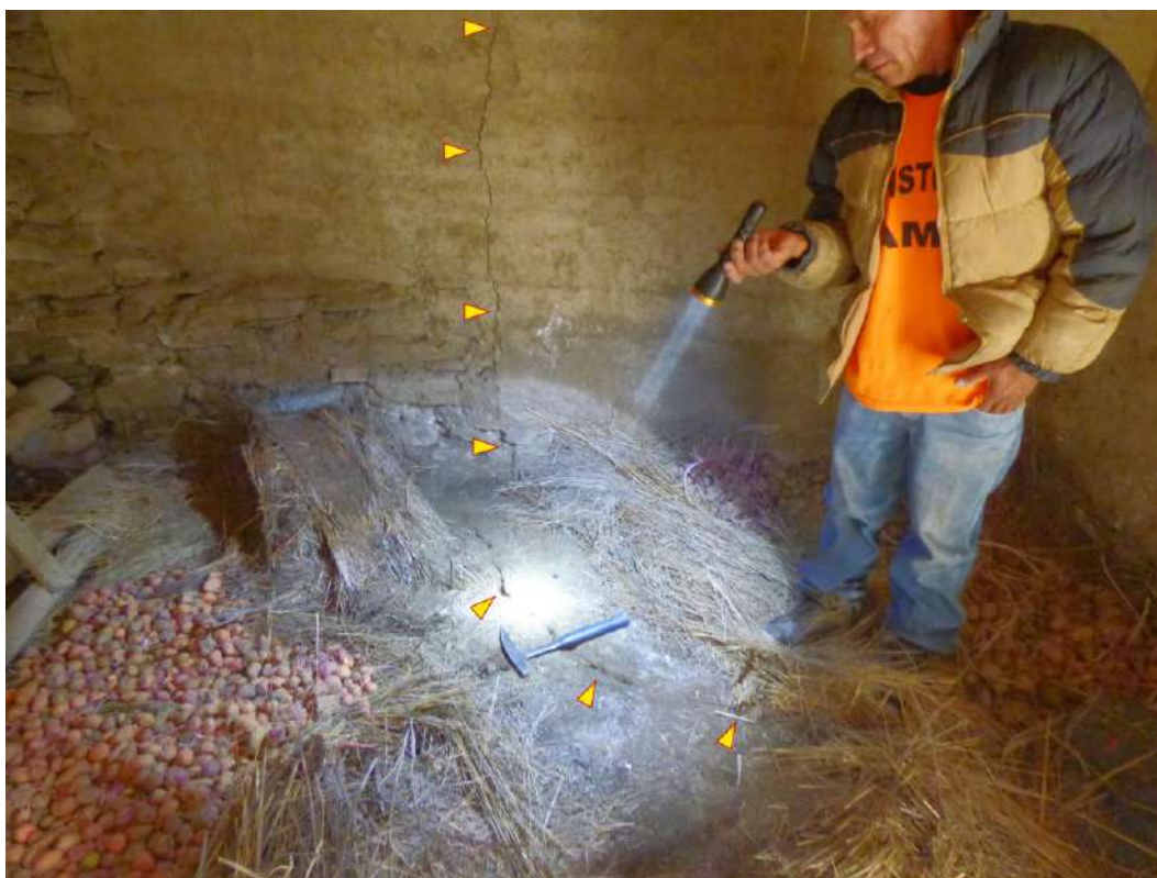
Figura 27. Grieta visible que se extiende hasta 4 m de longitud, el cual atraviesa una vivienda situada en el flanco derecho del deslizamiento activo, cerca de la plaza de armas de Marías (E: 312784, N: 8937435).
