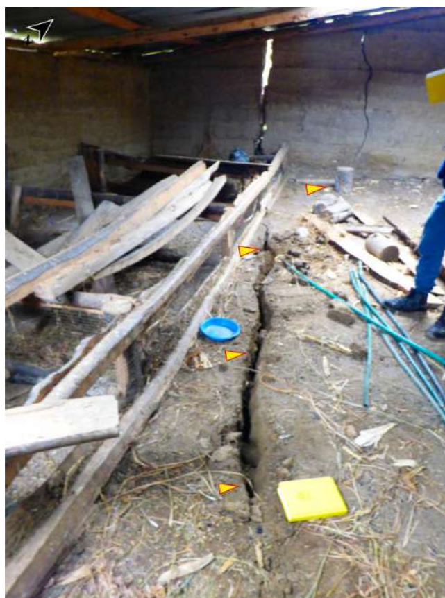
Figura 29. Grieta en el cuerpo del deslizamiento activo, situado en la parte baja de la ladera. Esta grieta atravesó transversalmente una vivienda (E: 313010; N: 8937000).
