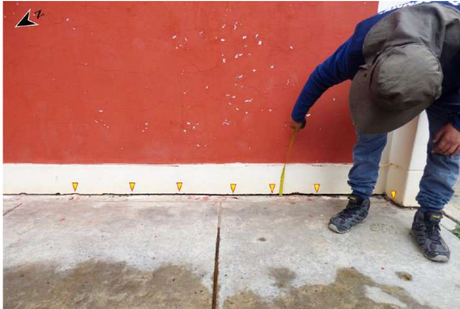
Figura 25. Evidencia de asentamiento de terreno (flechas de color amarillo). Se observa una separación de hasta 2 cm de la losa con el piso (E:313133, N8937432).
