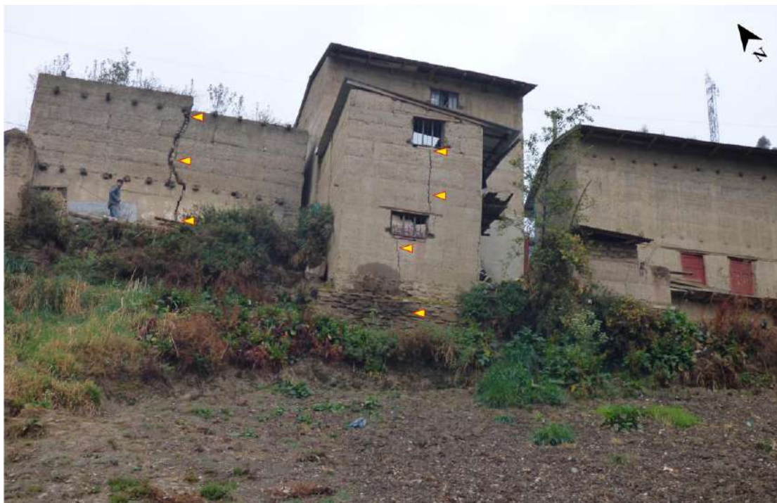
Figura 33. Fisuras y rajaduras en las viviendas situadas en el flanco derecho del deslizamiento activo, estas estructuras se alinean de forma semiparalela al escarpe principal del deslizamiento (E: 312789, N: 8937573).
