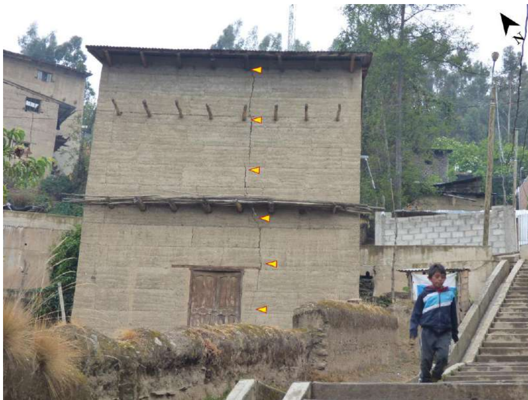
Figura 32. Viviendas afectadas por fisuras localizadas en la zona urbana del distrito de Marías, lo que, en evidencia el desarrollo del deslizamiento en estado activo (E:312760, N:8937535).
