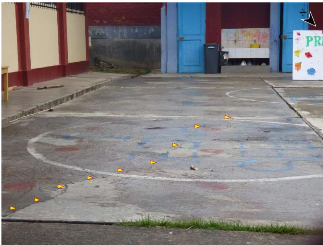
Figura 31. Grietas en la plataforma de la I.E. N°064 del distrito de Marías, que ponen en evidencia la deformación del terreno en el cuerpo del deslizamiento activo.
