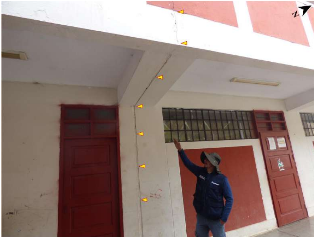
Figura 29. Columna de una de las aulas de la I.E. N°32230 se encuentra dañada con fisuras y grietas de manera vertical y con aberturas de 1 a 2 cm.
