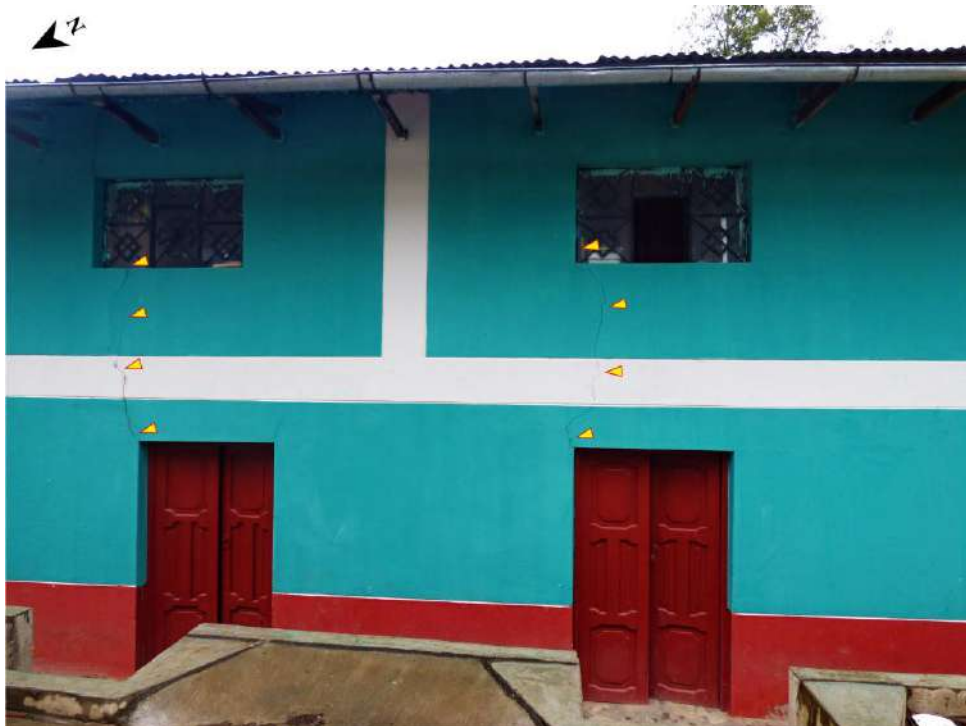
Figura 26. Evidencia de movimiento de terreno con las fisuras y rajaduras (flechas de color amarillo) de alguna de las viviendas situadas en la parte media superior del deslizamiento activo (E:313275, N8937466).
