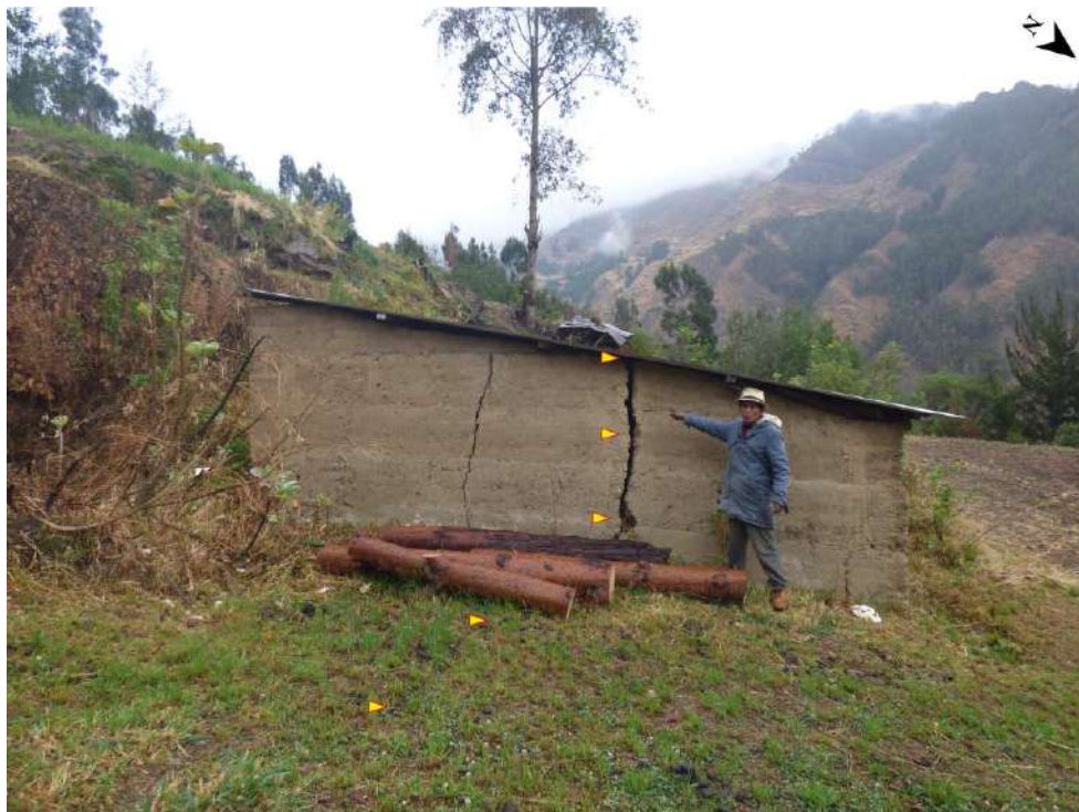
Figura 30. Vivienda afectada por una grieta interna localizada en el cuerpo del deslizamiento activo. Se trata de una fisura de 10 a 15 cm de abertura en la pared lateral.
