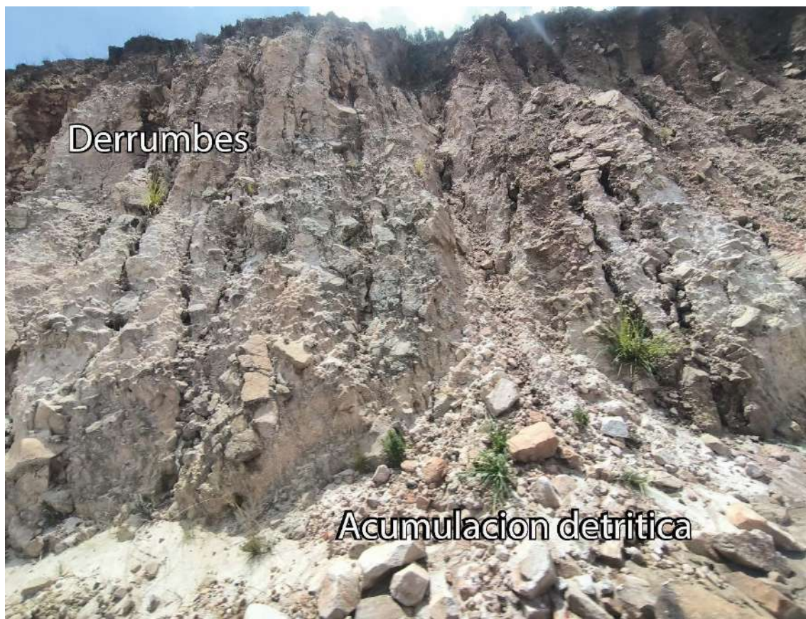
Figura 23: Evidencias de derrumbes en el área de inspección, la totalidad de ellos se muestran en el mapa 4 del anexo 1.
