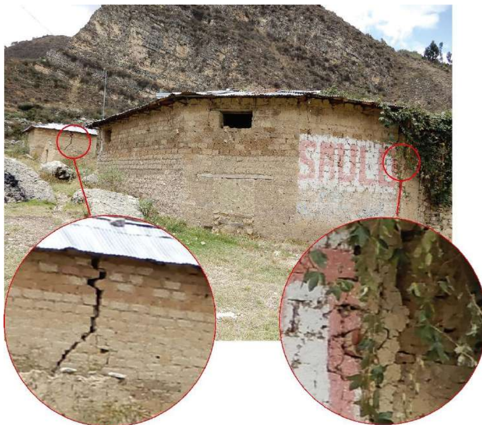
Figura 16: Agrietamientos en dos viviendas en la comunidad de Yachacmarca Villa Victoria.
