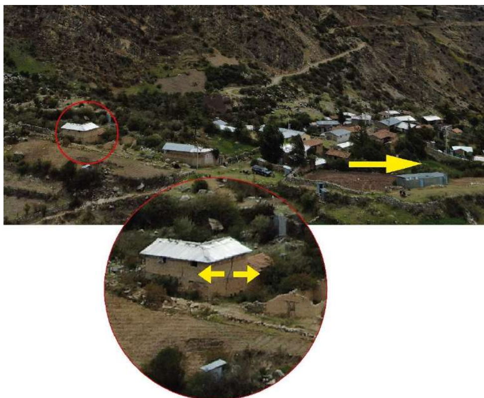
Figura 17: Dirección de apertura de los agrietamientos en dos viviendas en la comunidad de Yachacmarca Villa Victoria.
