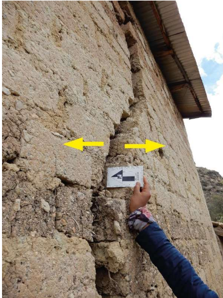
Figura 18: Apertura de 15 cm en los agrietamientos de viviendas.
