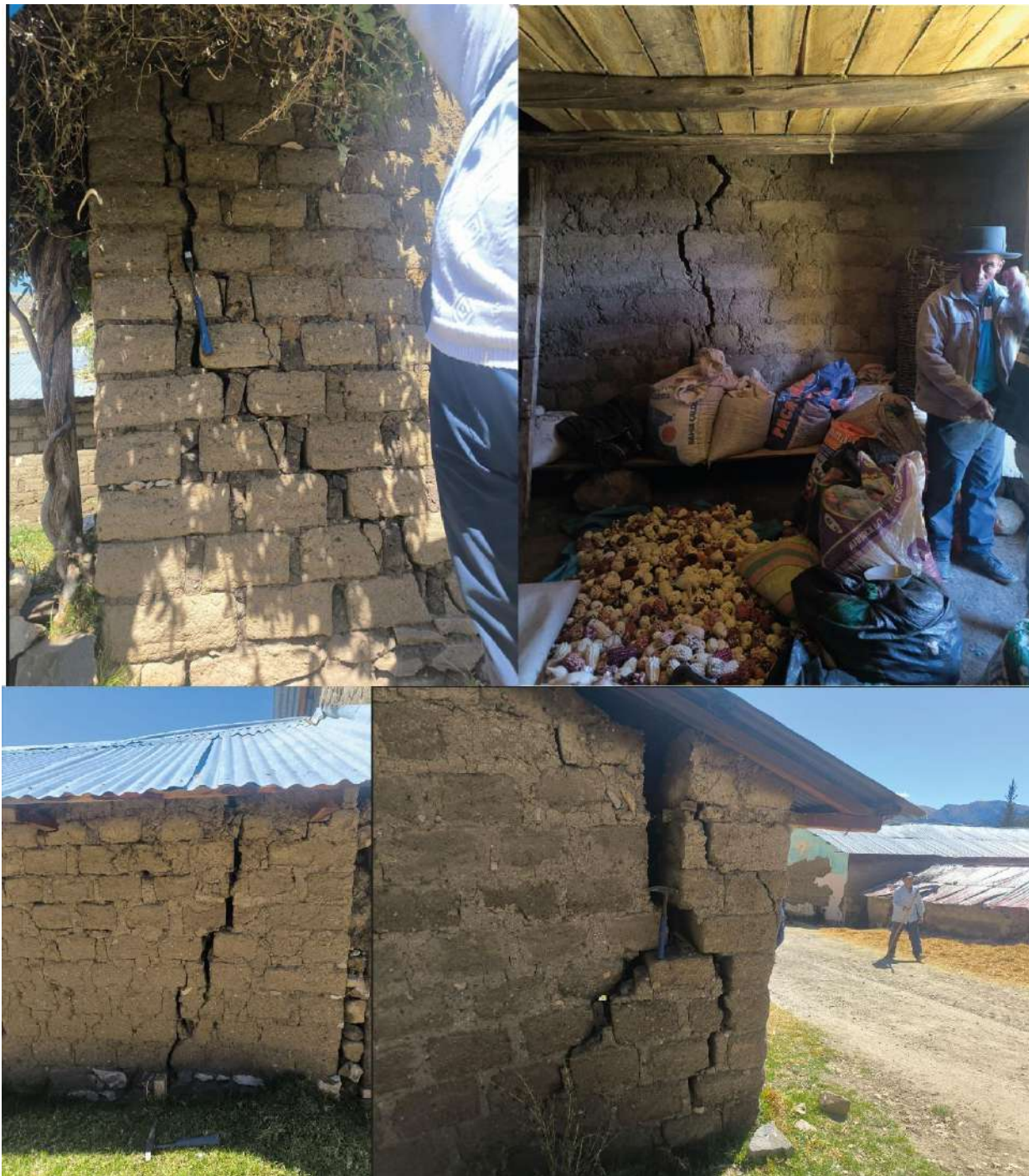
Figura 15. Grietas estructurales en viviendas de la localidad de Santa Rosa de Ccocha, originadas por el movimiento en masa lento correspondiente al deslizamiento rotacional activo 2 (Da-2).
