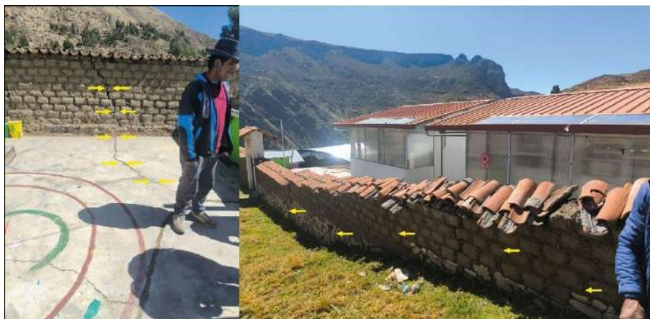
Figura 18. Grietas en la infraestructura del centro educativo inicial de Santa Rosa de Ccocha, las cuales evidencian la inestabilidad del terreno asociada al deslizamiento rotacional activo 2 (Da-2).
