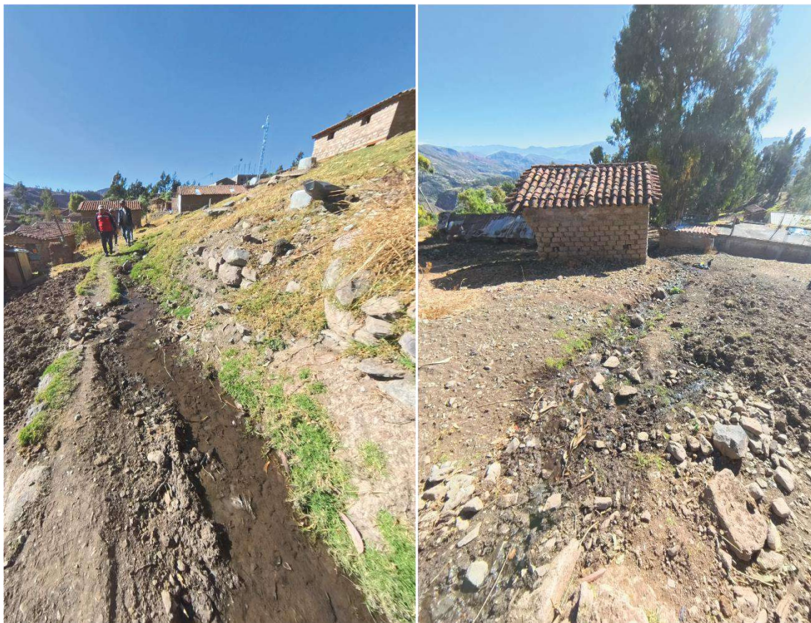
Figura 12. Evidencias de la saturación del suelo generada por canales de regadío sin revestimiento que atraviesan la ladera y descargan libremente pendiente abajo. Estas condiciones antrópicas constituyen una fuente adicional de recarga hídrica que favorece la pérdida de estabilidad de la ladera. Coordenadas referenciales UTM WGS-84, 18S: E: 576497; N: 8543422.
