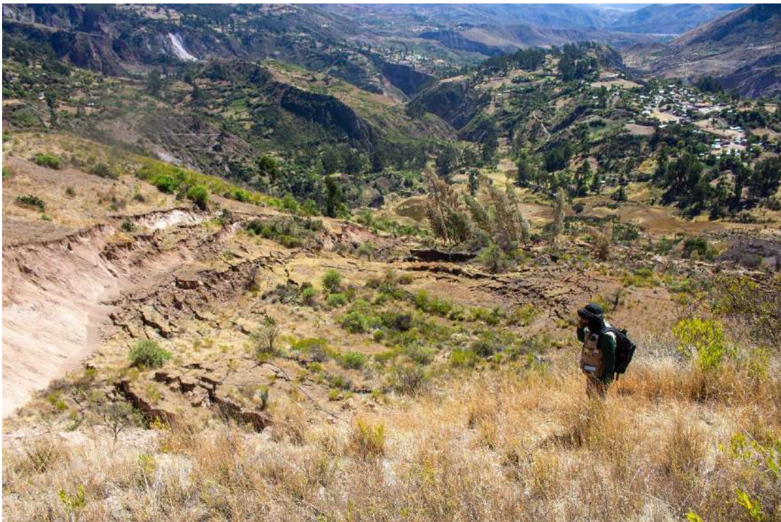
Fotografía 4. Grietas transversales en el cuerpo del deslizamiento con longitudes de 10 a 55 m y aberturas de hasta 0.50 m, que reflejan tensiones internas activas de la reactivación progresiva del deslizamiento.
